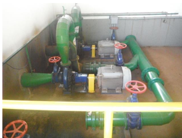
Foto 4.16 - Conjuntos Motobomba da EEAB2
