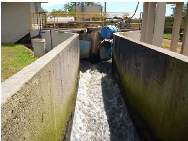
Foto 4.44 – Calha Parshall – Entrada ETE
