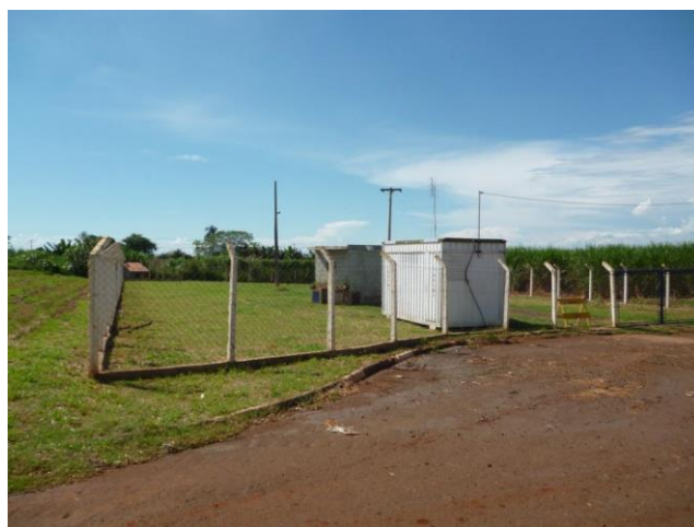
Foto 4.43 – EEE4 – Casa de Bomba
