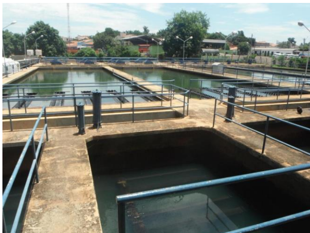
Foto 4.20 – Vista Geral da ETA
