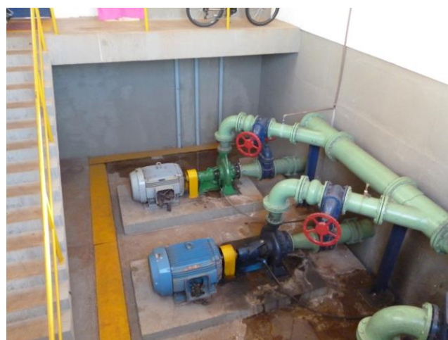
Foto 4.39 – EEAT11 – Conjunto Motobombas
