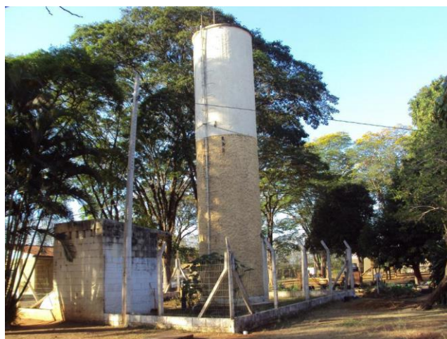
Foto 4.31 – Reservatório Centro Rural
