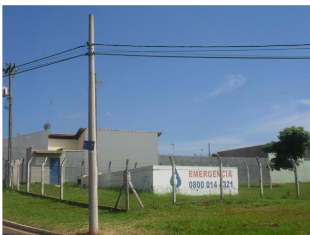
Foto 4.38 – EEAT9 – Casa de Bombas*
