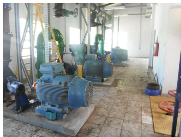
Foto 4.14 – Conjuntos Motobomba da EEAB1
