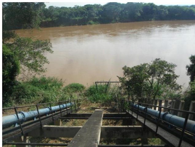
Foto 4.6 – Captação – Rio Mogi Guaçu
