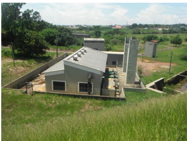
Foto 4.13 – Casa de Bombas da EEAB1
