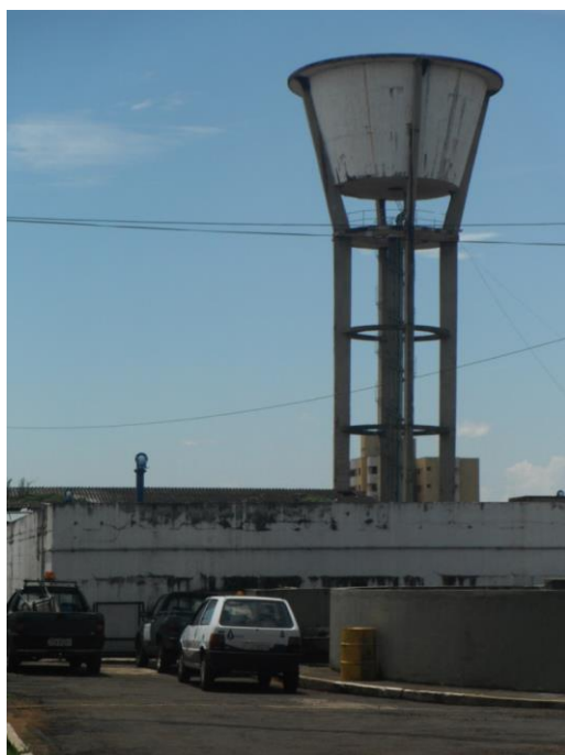
Foto 4.26 – Reservatório Jd. Cândida
