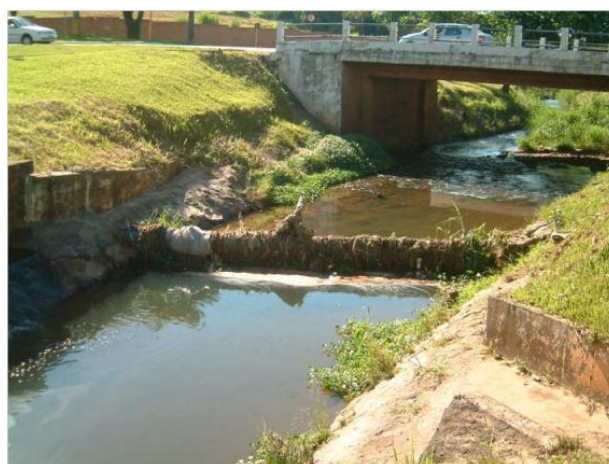
Foto 4.57 - Obstrução por entulho fixado em tubos e vegetação no leito do ribeirão
