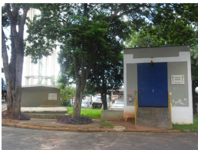
Foto 4.34 – EEAT1 e EEAT2*
