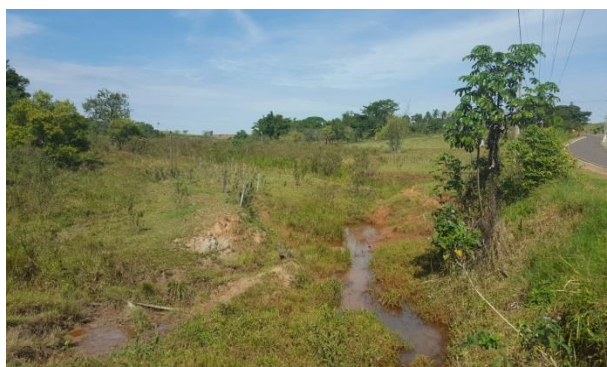
Foto 3.6 – Erosão no final da Rua Projetada 2
