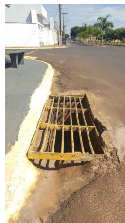
Foto 3.2- Boca de lobo Rua José Demori
