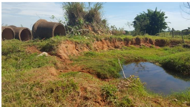
Foto 3.5 – Erosão no final da Rua Projetada 2
