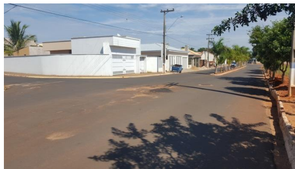
Foto 3.4 – Pontode Alagamento na Rua José Demori
