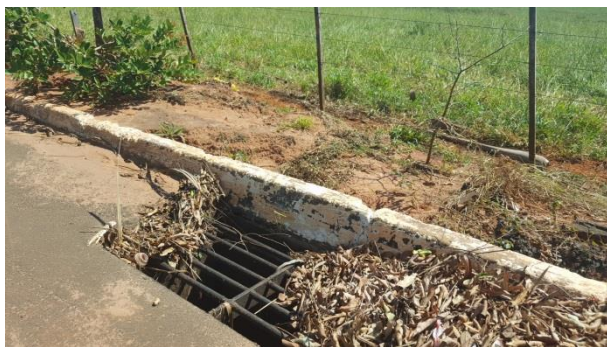
Foto 3.3 – Estrutura de microdrenagem com necessidade de limpeza
