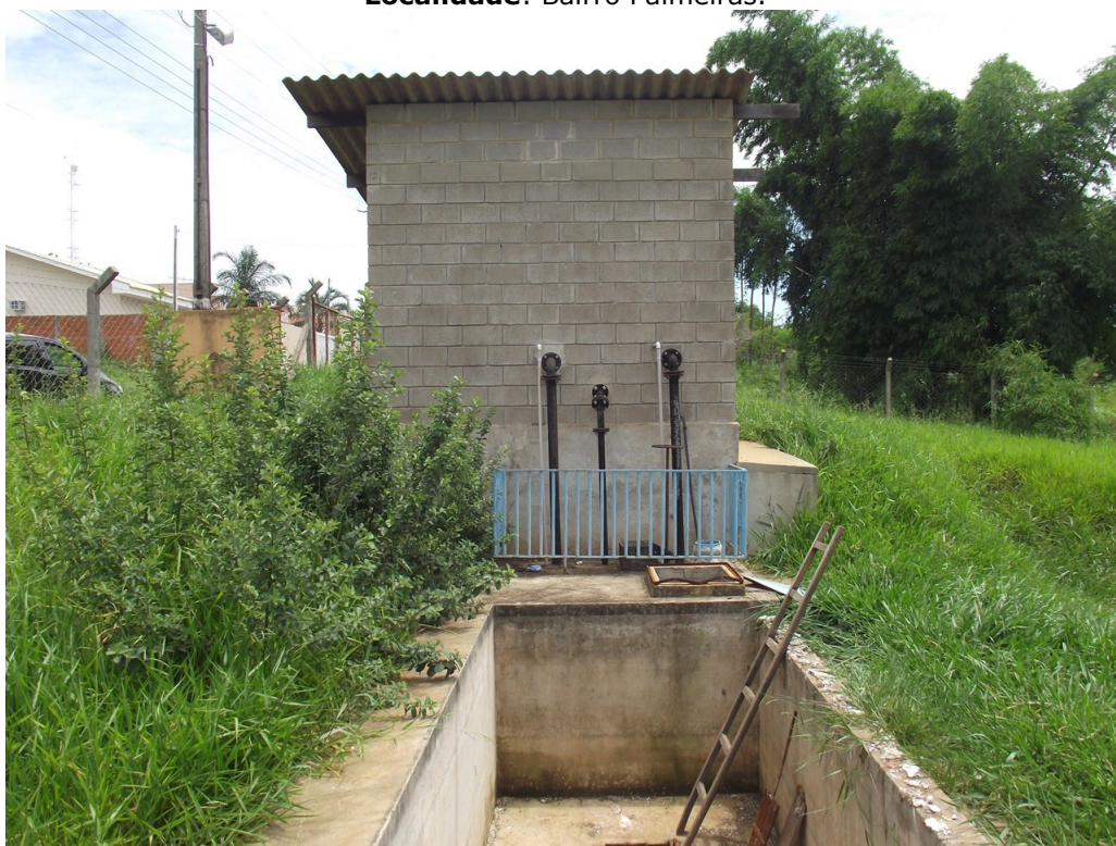
Foto: 75 – Vista da 2ª Elevatória de Esgoto (Desativada) Localidade: Rua Luiz Manoel Santana Branco, nº 2071
