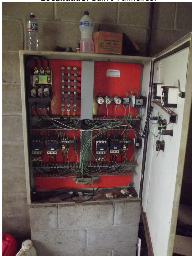
Foto: 73 - PAINEL de Comando das Bombas de Recalque (Antiga Elevatória de Esgoto) Localidade: Bairro Palmeiras.
