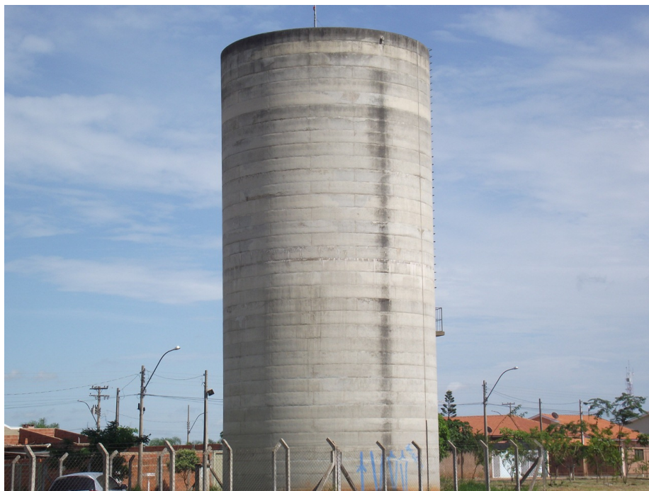
Foto: 14 – Reservatório Concreto - Capacidade: 285m 3 Localização: Rua Olímpio Manoel Damásio, altura do nº 2.321 – Bairro Colina Sul. Obs: Reservatório faz o abastecimento dos bairros Palmeiras e Remanso dos Coqueiros
