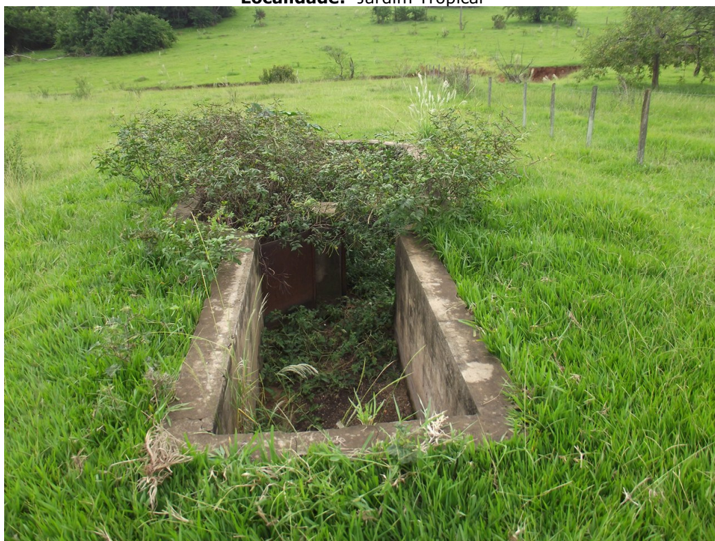
Foto: 81 - Imagem da Calha Parshall 2ª Lagoa (Desativada) Localidade: Jardim Tropical
