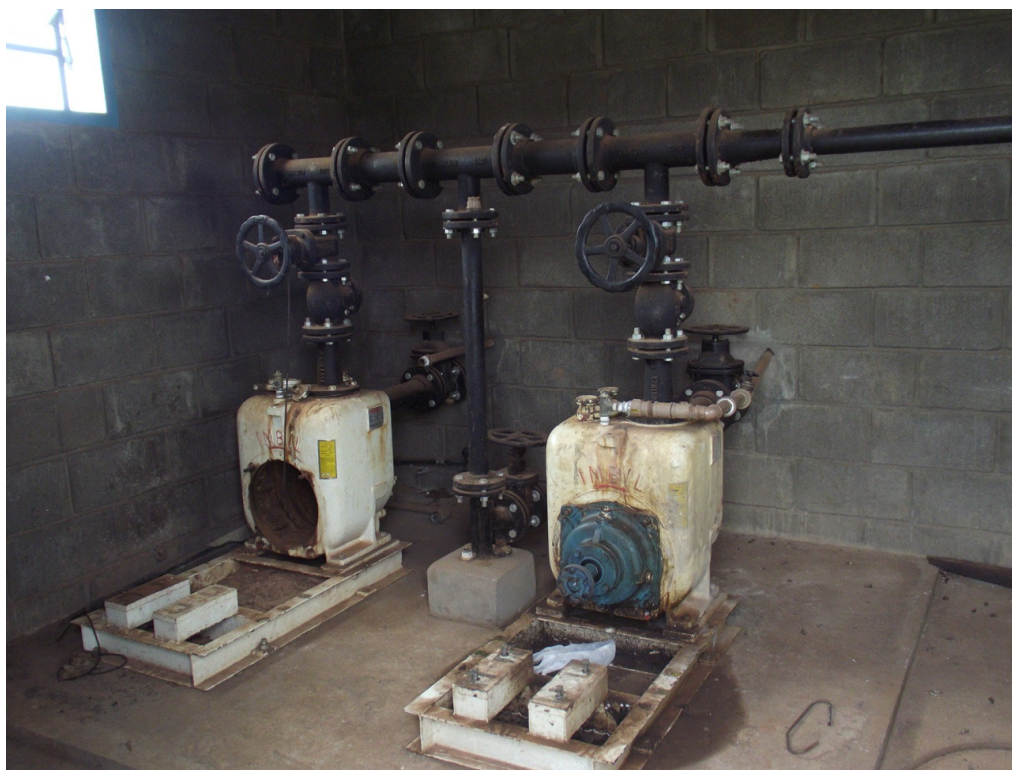
Foto: 76 - Visão do Interior da 2ª Elevatória de Esgoto (Casa das Bombas) Localidade: Bairro Palmeiras.
