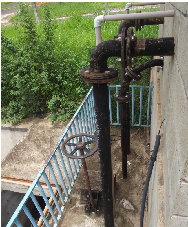
Foto: 78 – Tubulações 2ª Elevatória de Esgoto - Desativada Localidade: Bairro Palmeiras.
