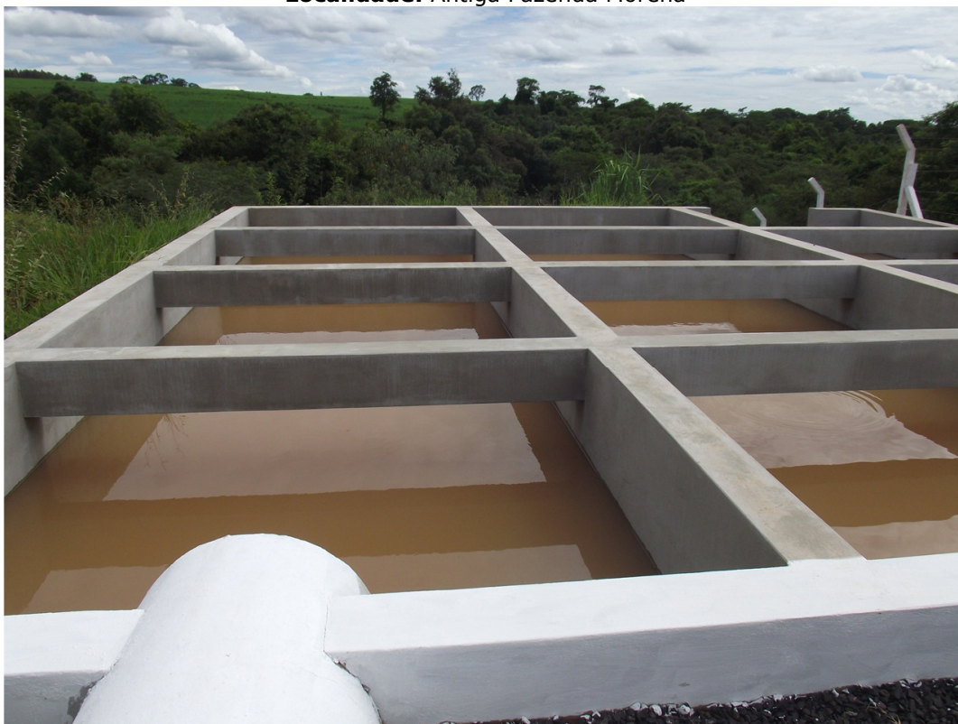
Foto: 101 – Visão III – Tratamento Facultativo dos Efluentes Estação de Tratamento de Esgoto - ETE Localidade: Antiga Fazenda Morená
