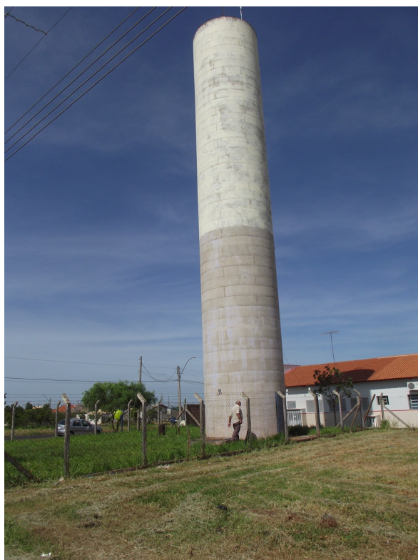
Foto: 13 – Reservatório Concreto - Capacidade: 100m 3 Localização: Rua Manoel de Souza, nº460 – Bairro Palmeiras.
