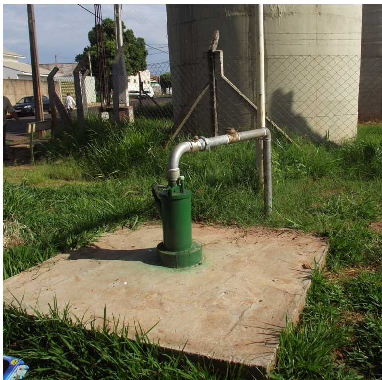
Foto: 39 – Entrada do Poço (P9) – Poço ainda sem Painel de Comando Localização: Rua Wilson Antônio de Aquino, nº 310
