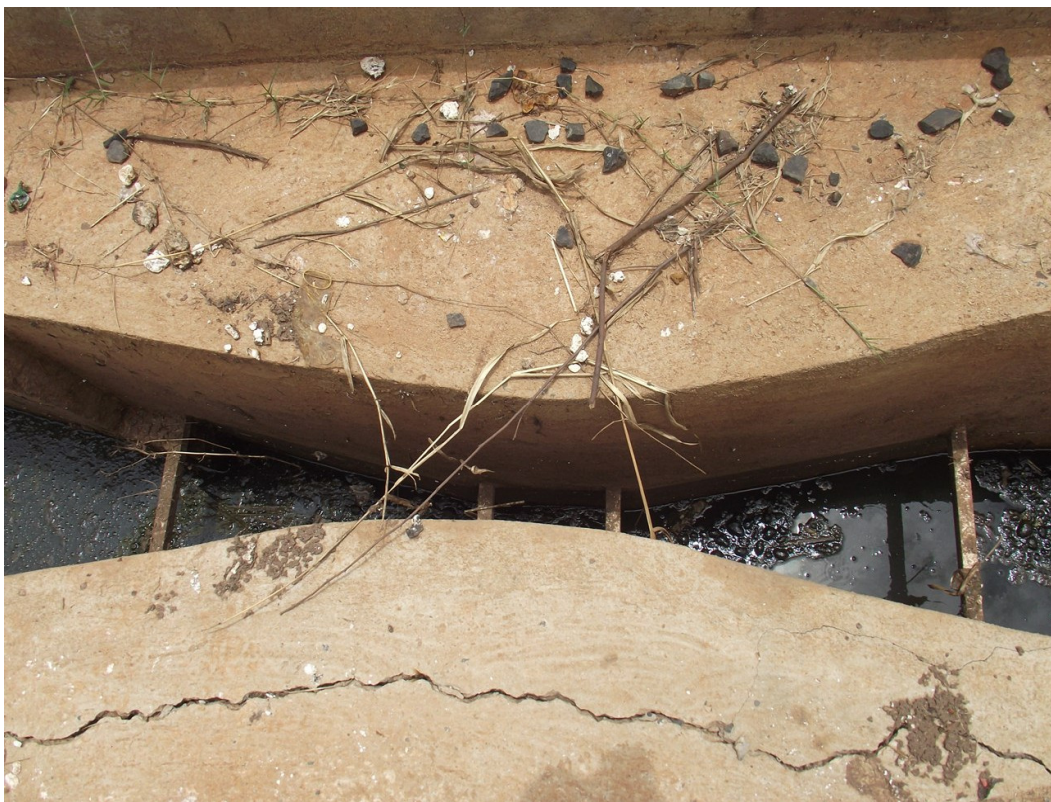
Foto: 68 – Caixa de gradeamento – Nova Elevatória de Esgoto Localidade: Denominado "Matadouro".
