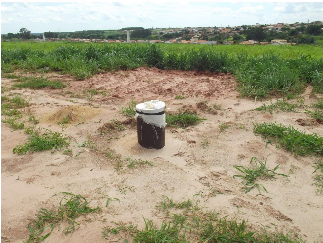
Foto: 53 – Entrada do Poço (P19) – Poço Sem Painel Localização: Bairro Residencial Menezes II
