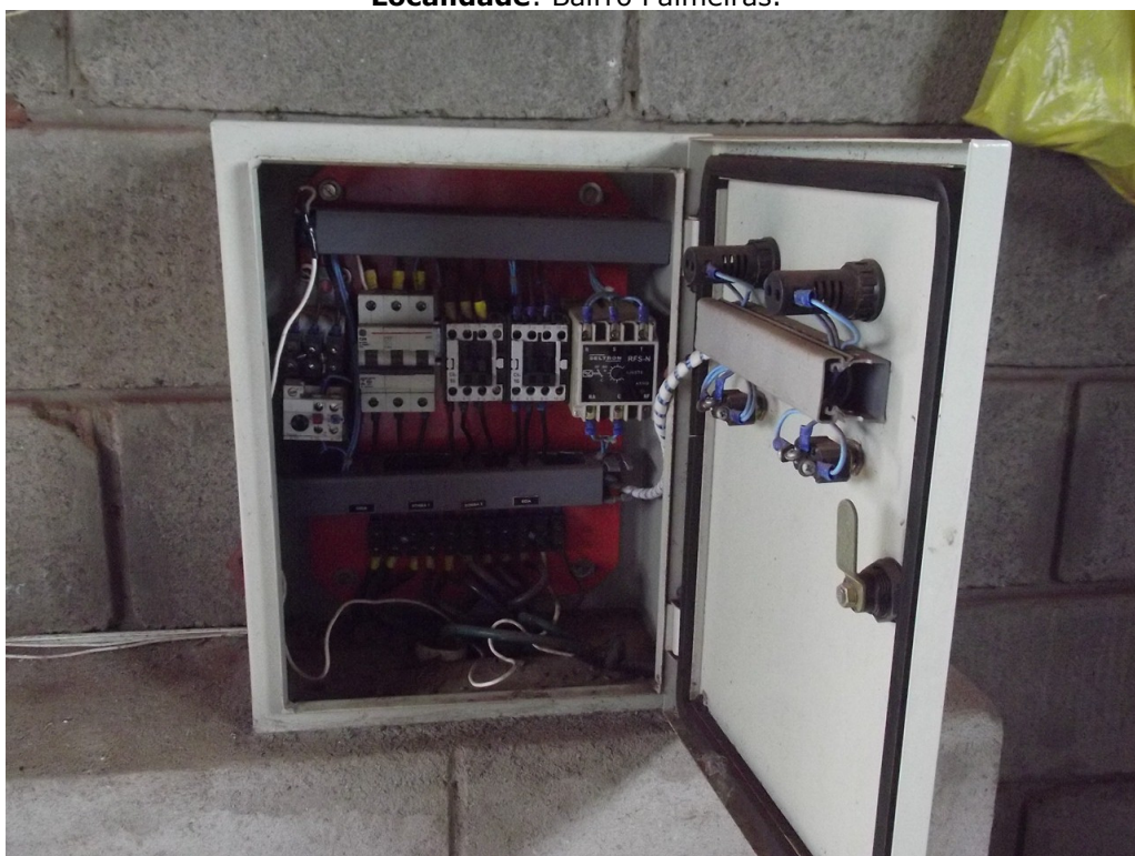
Foto: 77 - Painel de Comando das Bombas de Recalque (2ª Elevatória de Esgoto - Desativada) Localidade: Bairro Palmeiras.
