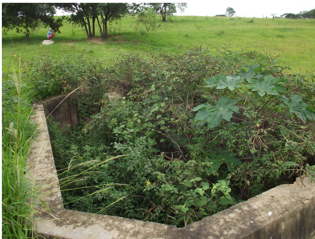
Foto: 82 – Visão II – Da Calha Parshall 2ª Lagoa (Desativada) Localidade: Jardim Tropical
