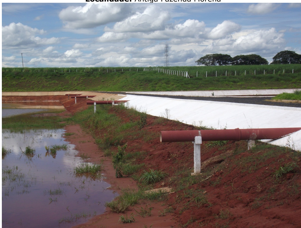
Foto: 92 – Visão VI – Passagem dos Efluentes da 2ª para a 3ª Lagoa de Tratamento de Esgoto Localidade: Antiga Fazenda Morená
