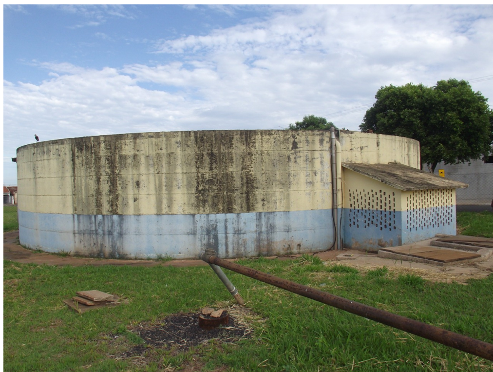
Foto: 04 - Reservatório Apoiado – Capacidade de 750m 3 - Localização: Rua Otacílio José Mesquita, s/nº - Bairro San Remo.
