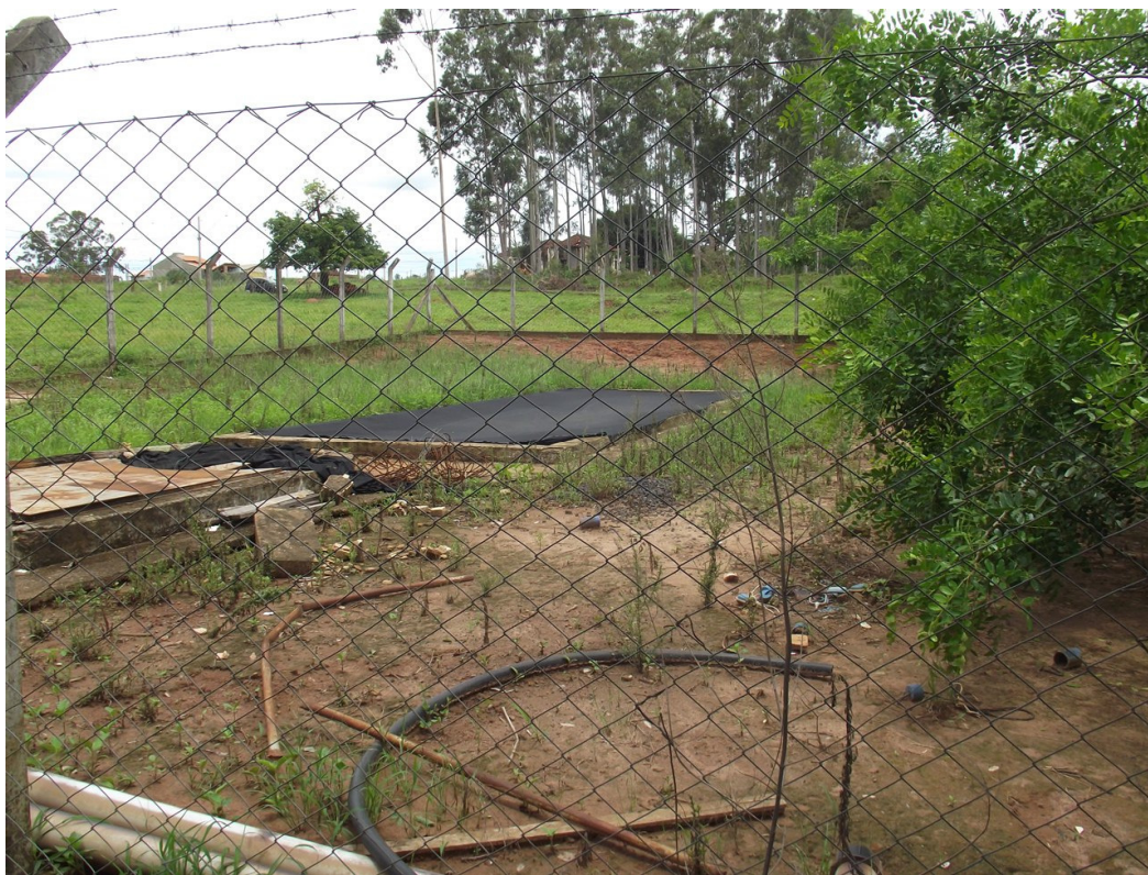
Foto: 63 – Bomba de Recalque Localidade: Residencial Borboleta I (Vista Lateral)
