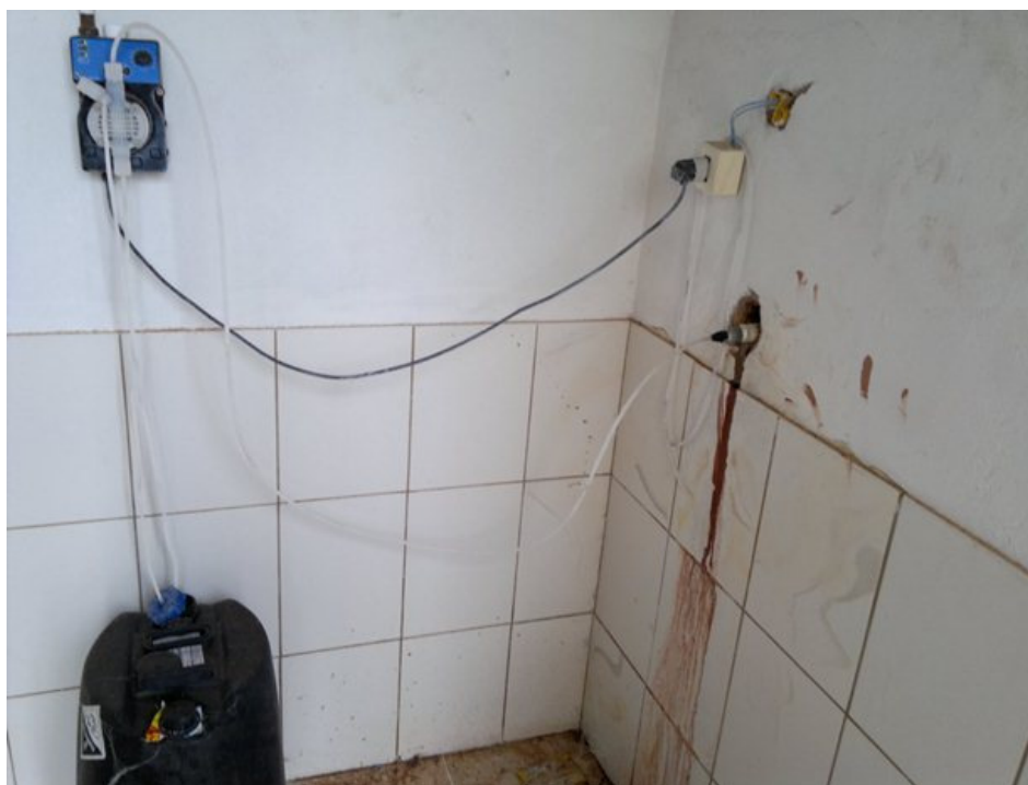
Foto: 58 – Local Armazenamento e Tratamento de Água Localização: – Entre as Ruas Projetada 13 e Projetada 03 – Bairro Residencial Lago Sul
