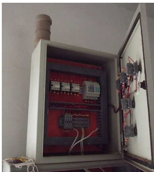
Foto: 32 – Painel de Controle de Partida e Entrada do Poço Profundo (P4) – Poço Novo Localização: Praça Mário Covas.
