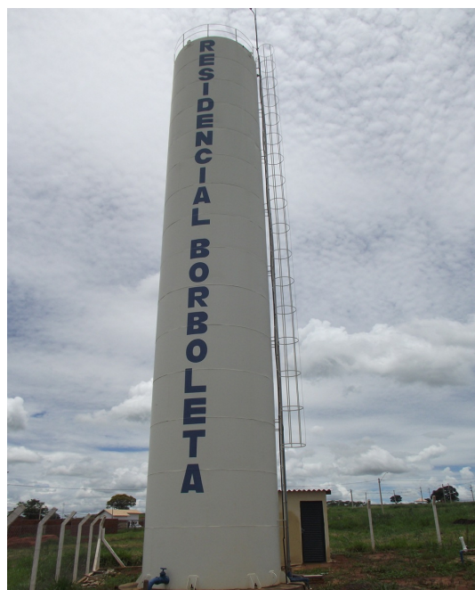
Foto: 16 – Reservatório Metálico - Capacidade: 60m 3 Localização: Rua Projetada 07, s/nº – Bairro Residencial Borboleta I.
