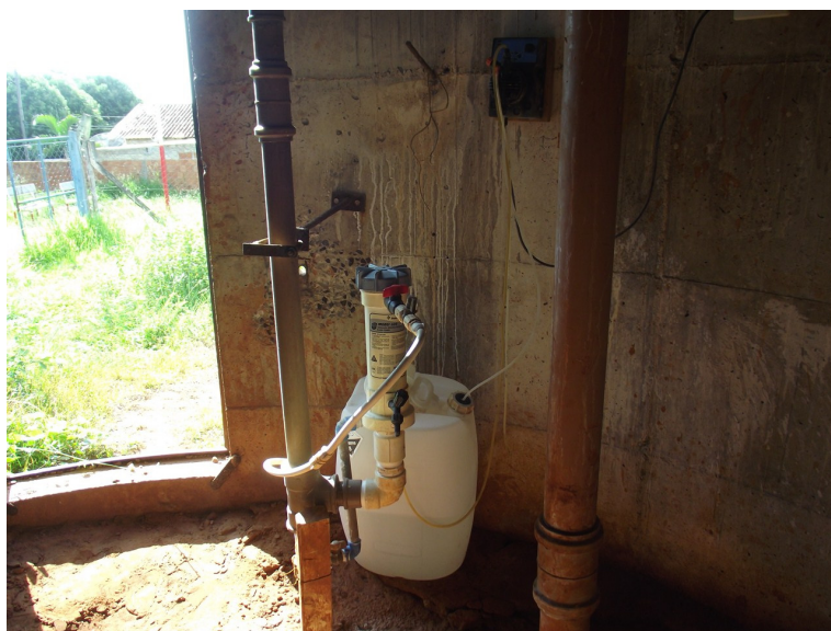
Foto: 41 – Armazenamento e Tratamento Cloro e Flúor Localização: Praça Lino Pradela – Cohab I
