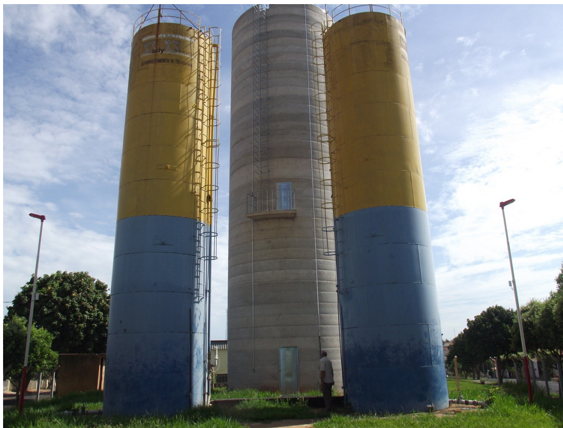
Foto: 12 – Reservatórios do Bairro Cohab III Capacidade Reservatórios Metálicos: 145\text{m}^3 cada Capacidade Reservatório Concreto (Inativo): 250^3 Reservação Total: 540\text{m}^3 Localização: Rua Martino Lúcio de Freitas, nº 1.075 – Cohab III.
