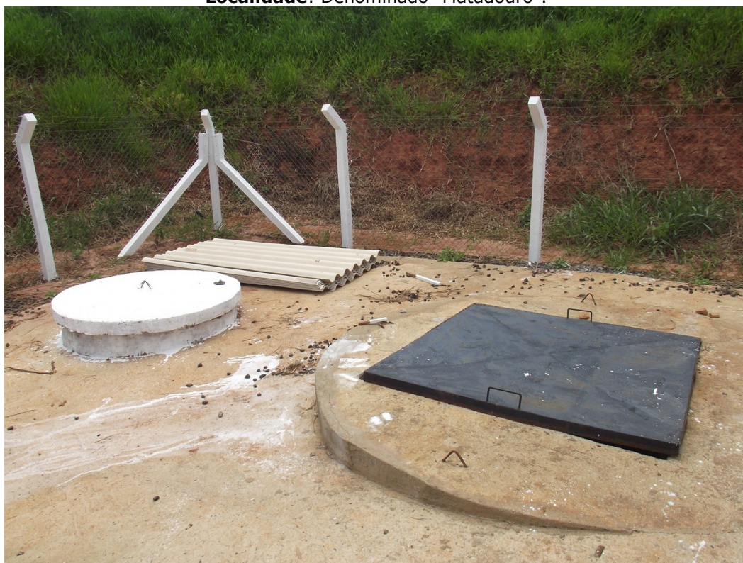
Foto: 69 – Local onde será Instalados as Bombas de Recalque Localidade: Denominado "Matadouro".
