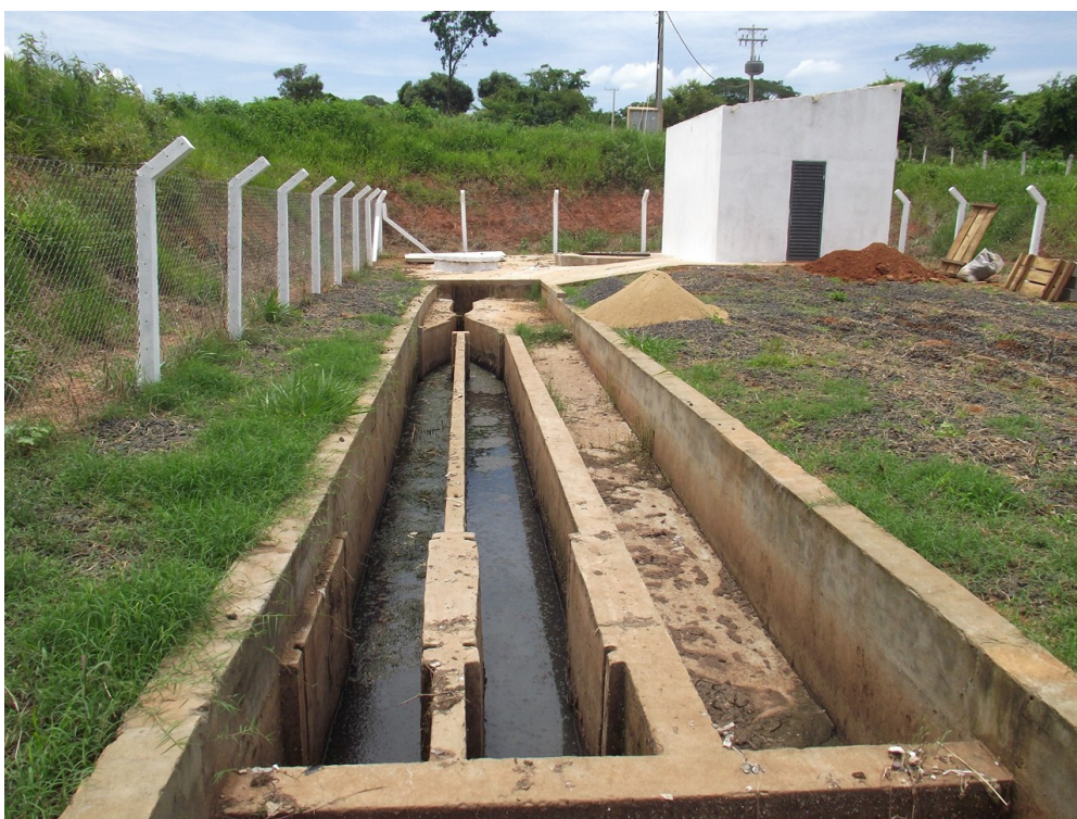
Foto: 67 – Calha Parshall - Ao fundo Elevatório de Esgoto (Inativa). Localidade: Denominado “Matadouro”.
