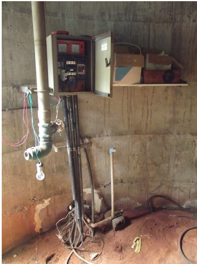
Foto: 25 – Painel de Partida da Bomba Submersa – 12HP (Bairro Vertente)
