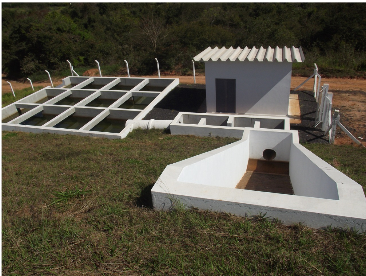
Foto: 104 – Visão VI – Final do Tratamento e Saída dos Dejetos já Tratados para o Rio Água Limpa Estação de Tratamento de Esgoto - ETE Localidade: Antiga Fazenda Morená
