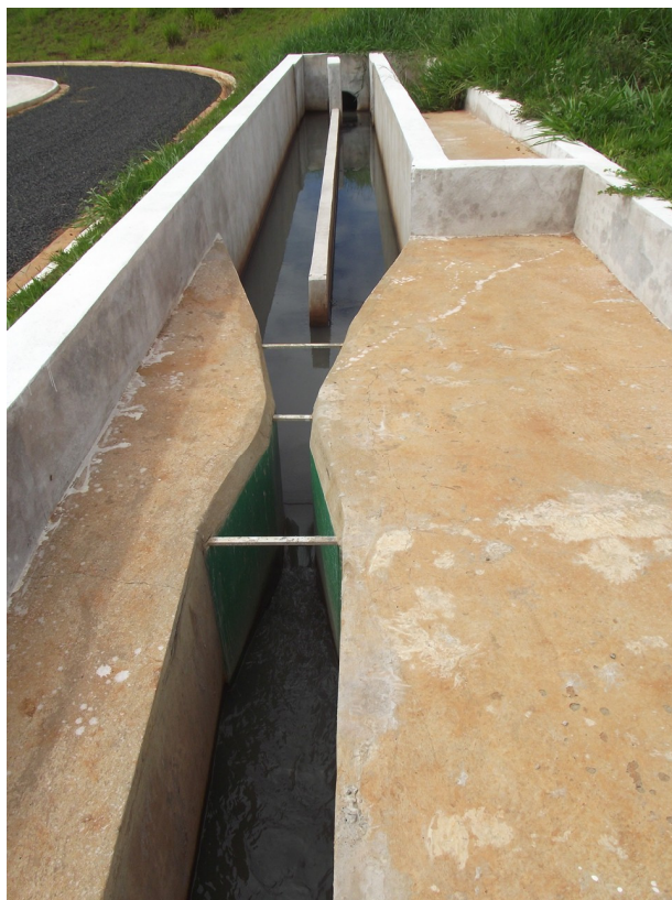
Foto: 94 – Calha Parshall da Nova estação de Tratamento de Esgoto - ETE Localidade: Antiga Fazenda Morená
