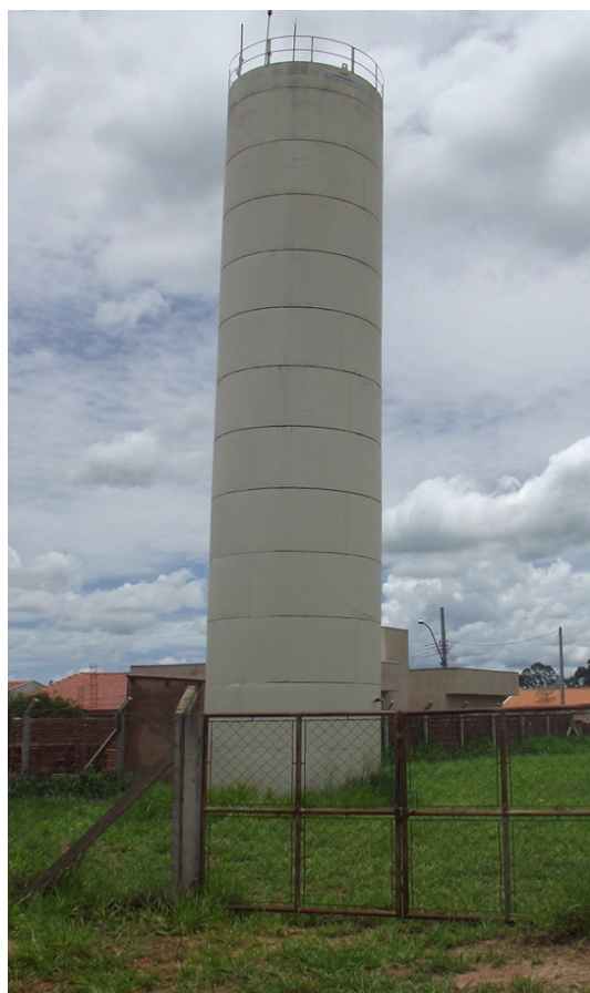
Foto: 15 – Reservatório Metálico - Capacidade: 80m 3 Localização: Rua Ludolvina Cardoso Barufi, nº 290 – Bairro Menezes.
