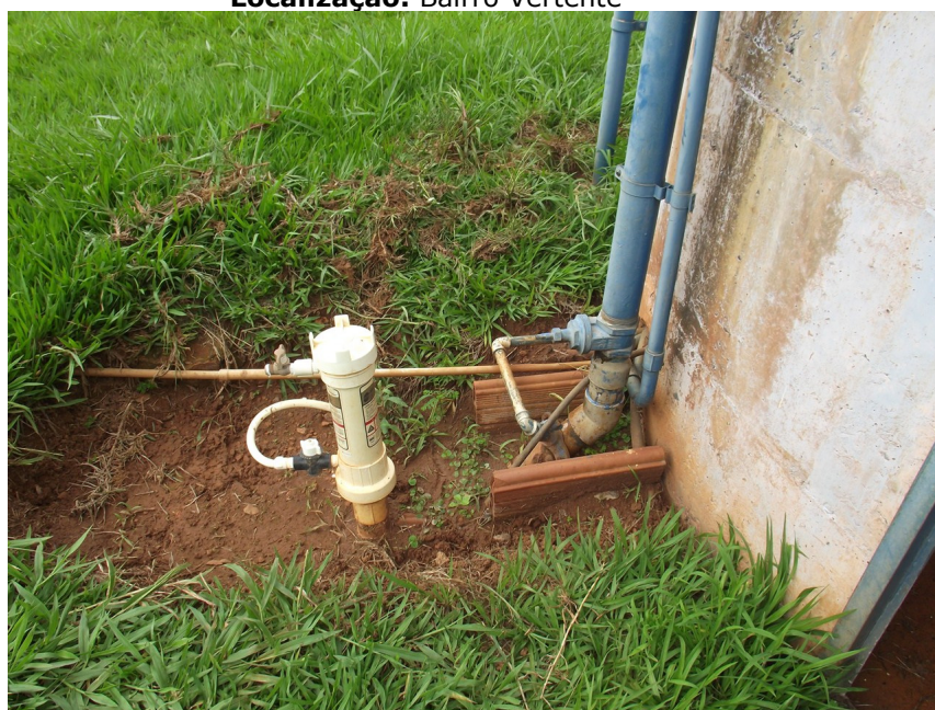
Foto: 22 – Clorador de Flúor Localização: Bairro Vertente
