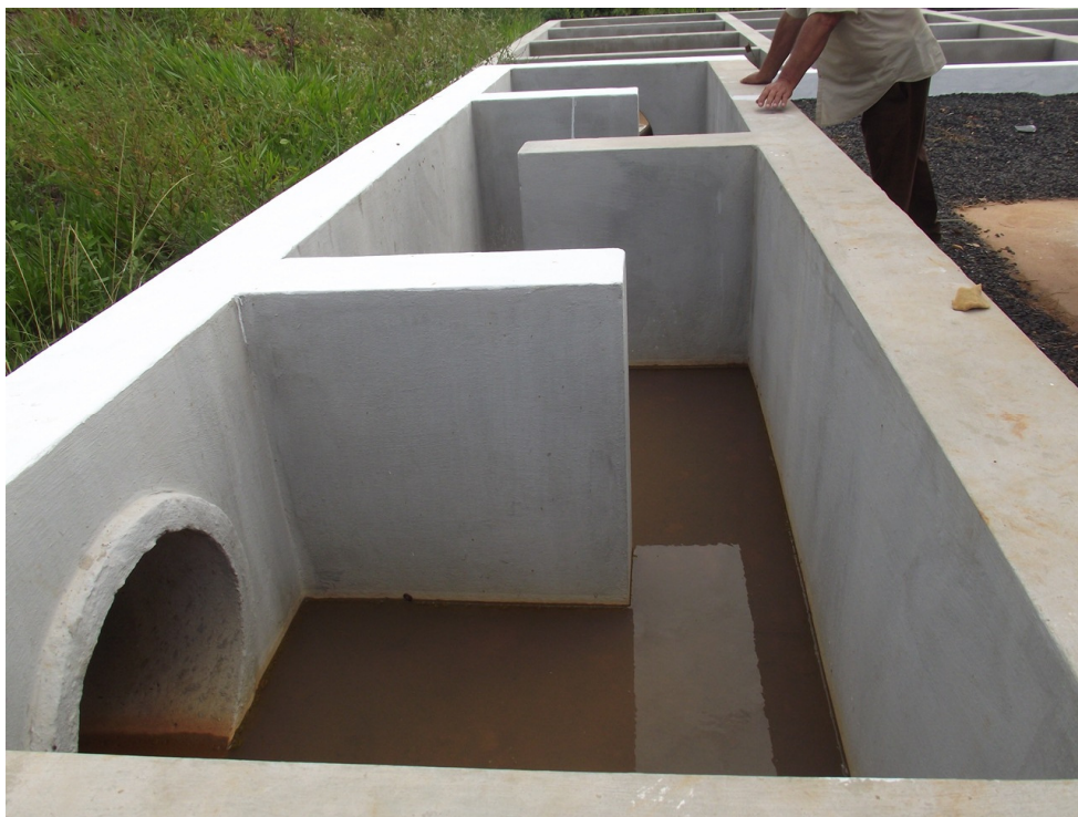
Foto: 100 – Visão II – Início da Entrada dos Efluentes para o Tratamento Localidade: Antiga Fazenda Morená
