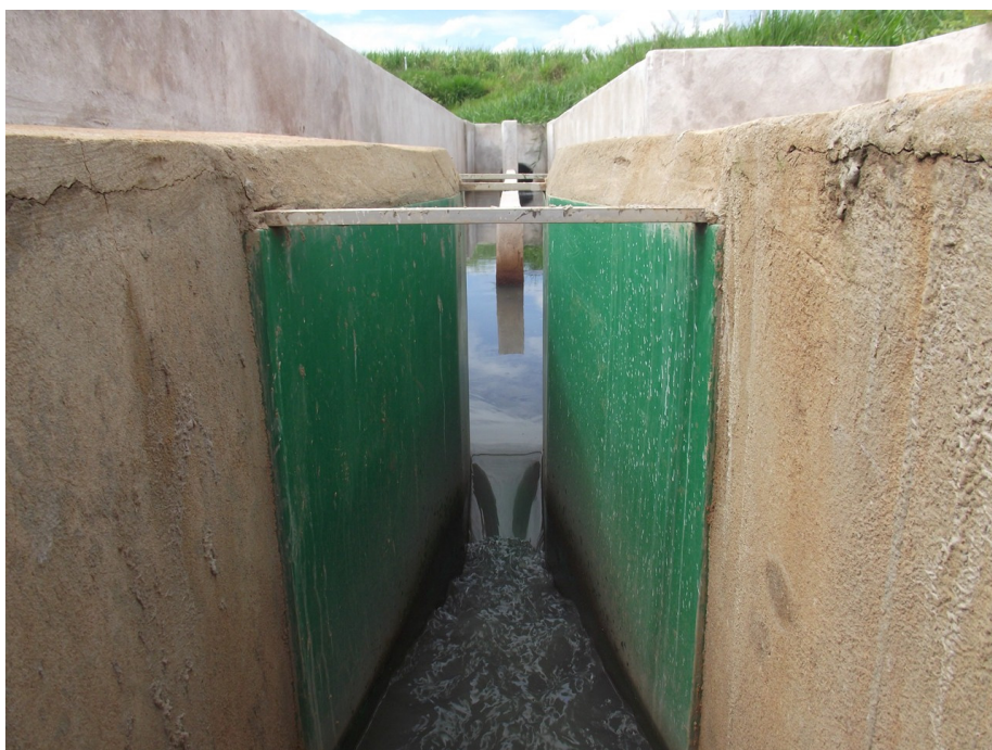
Foto: 95 – Calha Parshall da Nova estação de Tratamento de Esgoto - ETE Localidade: Antiga Fazenda Morená
