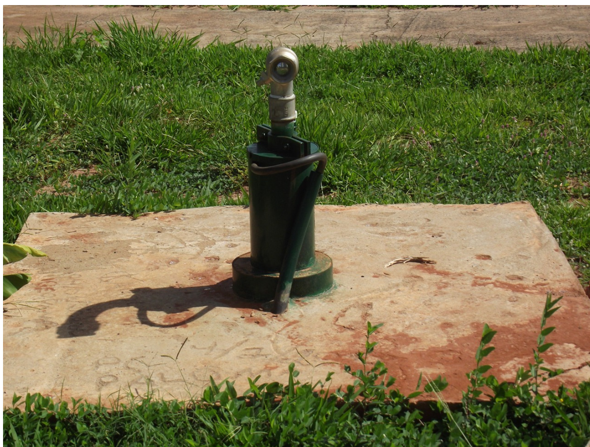
Foto: 44 – Entrada do Poço (P12) (Inoperante – Poço Novo) Localização: – Rua Martino Lúcio de Freitas, nº 1.075 - Cohab III
