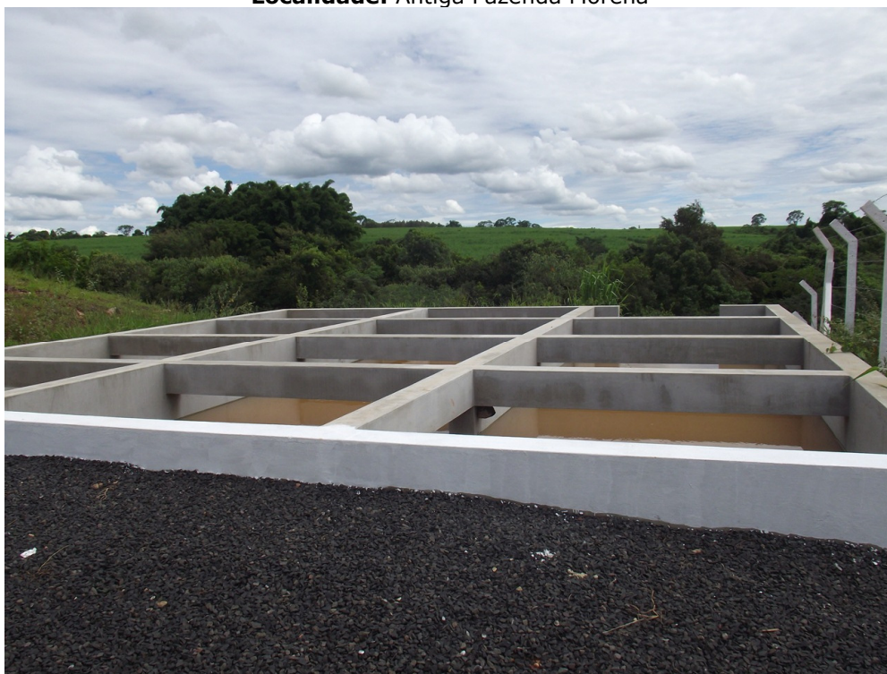
Foto: 103 – Visão V – Visão Geral do Tratamento Facultativo dos Efluentes Estação de Tratamento de Esgoto - ETE Localidade: Antiga Fazenda Morená
