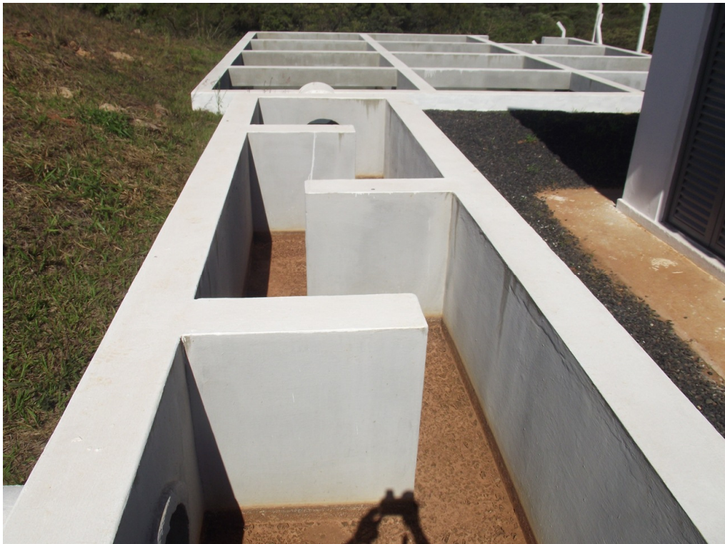
Foto: 99 – Visão I – Início da Entrada dos Efluentes para o Tratamento Localidade: Antiga Fazenda Morená
