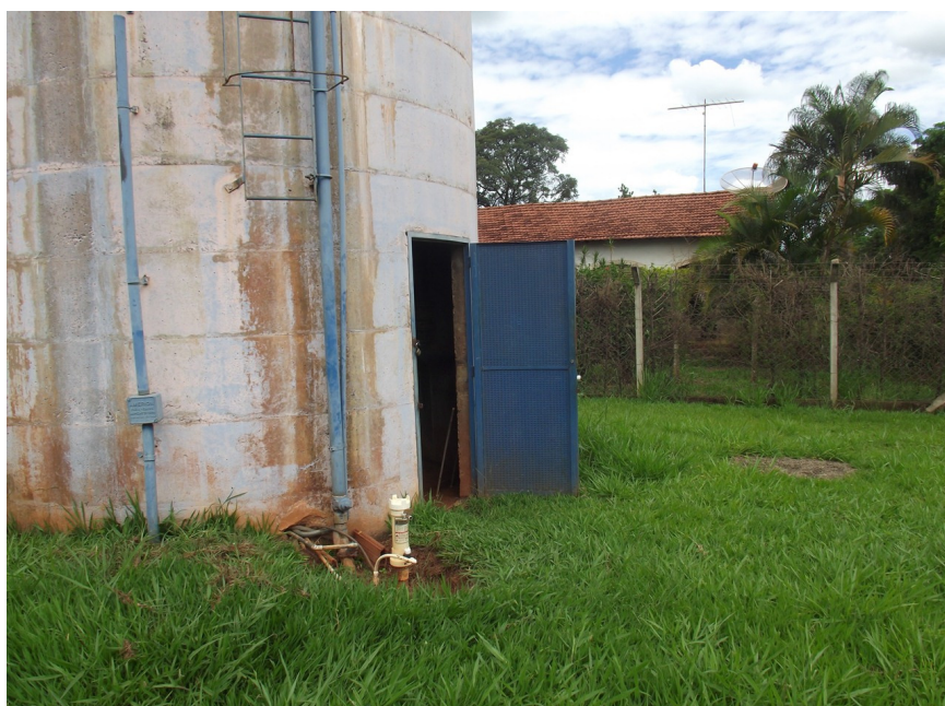
Foto: 24 - Entrada Para o Reservatório, onde esta localizado o Painel de Partida do Poço Profundo (Bairro Vertente)
