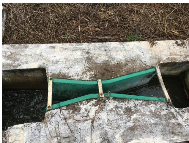
Foto 3.28 – Calha Parshal - ETE
