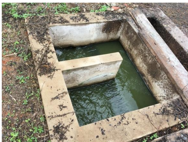
Foto 3.27 – Caixa de Entrada – ETE
