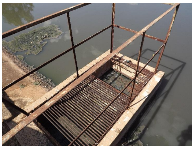
Foto 3.182 – Detalhe de caixa de passagem com tampa danificada na saída da lagoa facultativa
