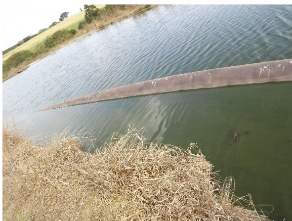
Foto 3.240 – Detalhe de manta geotêxtil desprendida do fundo, na superfície da lagoa
