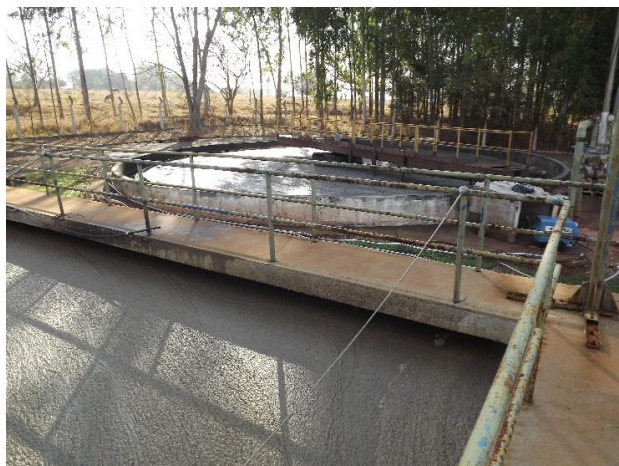
Foto 3.208 – Vista de decantador secundário da ETE IV
