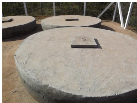
Foto 3.131 – Detalhe de reservatórios pulmão na EEE Jd. Oasis
