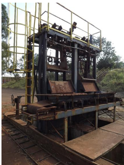
Foto 3.187 – Vista do gradeamento mecanizado (desativado) na ETE III
