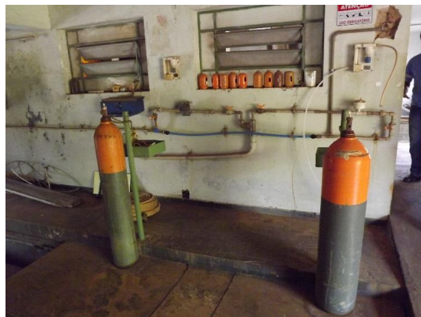
Foto 3.65 – Detalhe de cilindros de cloro em gás instalados (sistema reserva para desinfecção)
