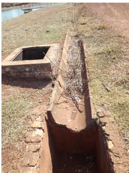
Foto 3.171 – Detalhe de estrutura de drenagem de águas pluviais obstruída na ETE I
