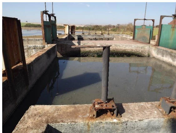
Foto 3.147 – Detalhe de caixa de areia na entrada da EEEB II – ETE III
