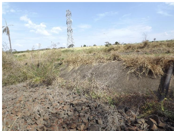
Foto 3.245 – Detalhe de filtro biológico desativado na ETE VII - Ibitu
