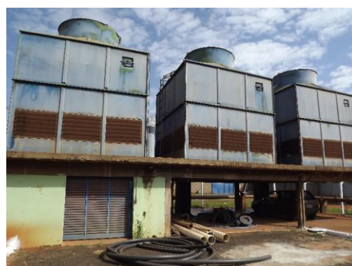
Foto 3.18 – Sistema de resfriamento de água na saída do Poço Tubular Profundo Barretos II
