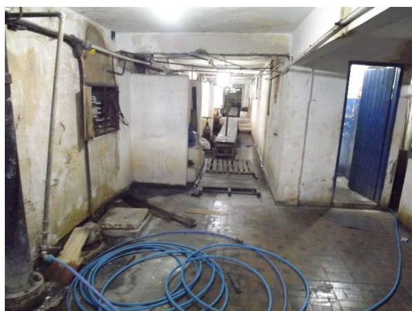
Foto 3.53 – Dependências da ETA – Saída de água tratada para a EEAT ETA
