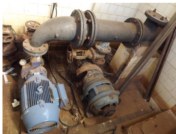
Foto 3.106 – Detalhe de conjunto motobomba da EEAT São Benedito
