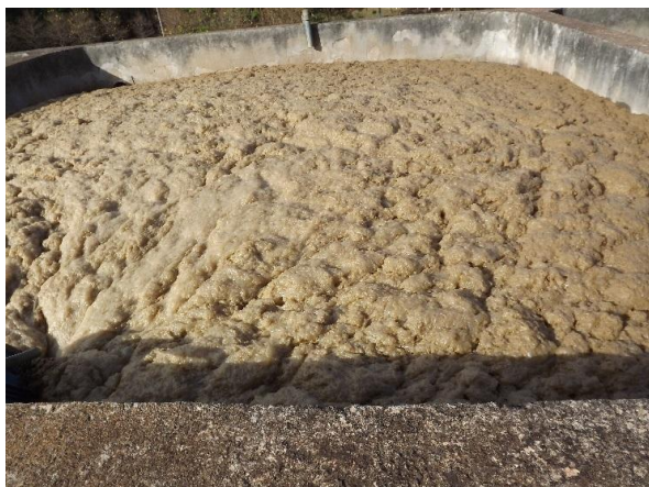
Foto 3.213 – Detalhe de um dos tanques de maturação do lodo em funcionamento
