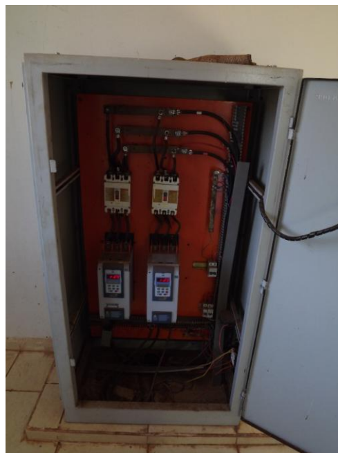
Foto 3.6 – Detalhe de painel elétrico das bombas de recalque da captação no Córrego do Aleixo
