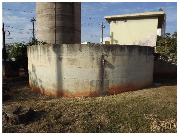
Foto 3.85 – Detalhe do RAP I Cristiano de Carvalho (à frente) e REL Cristiano de Carvalho (ao fundo)
