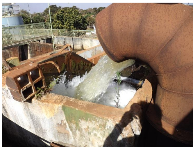
Foto 3.56 – Detalhe de adutora de entrada da ETA e ponto de aplicação de policloreto de alumínio (coagulante)
