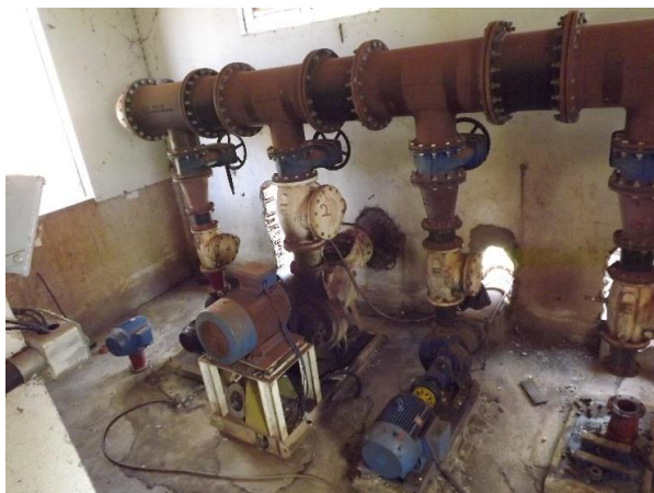
Foto 3.144 – Vista da casa de bombas da EEEB I – ETE III
