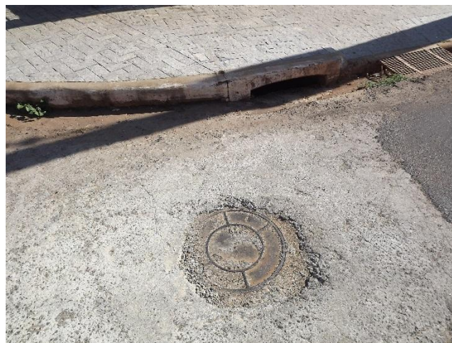
Figura 3.255 – Detalhe de boca de lobo e poço de visita no cruzamento da Rua 24 com Av. 45
