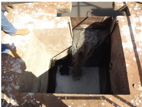
Foto 3.167 – Detalhe de by-pass para o lançamento do efluente no Córrego Barro Preto
