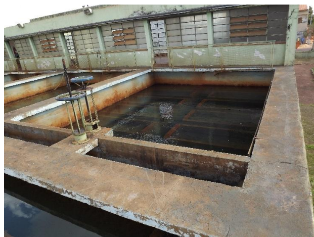
Foto 3.63 – Detalhe de filtro ascendente
