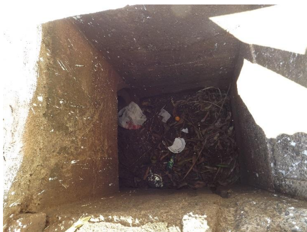
Foto 3.266 – Estrutura de drenagem de águas pluviais com resíduos sólidos no ponto apresentado
