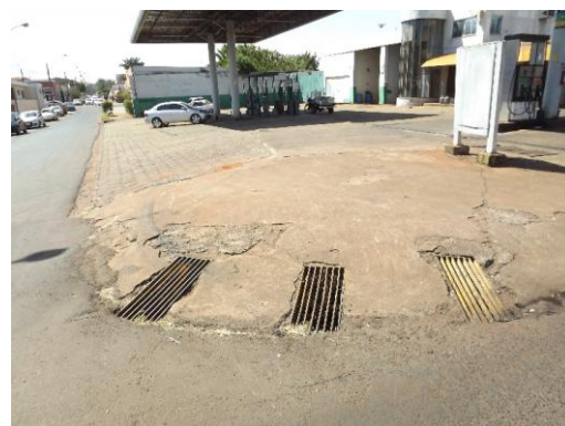
Foto 3.279 – Detalhe de grelhas para a drenagem de águas pluviais em posto no cruzamento da Av. 11 com Rua 20 (ponto crítico de inundação)
