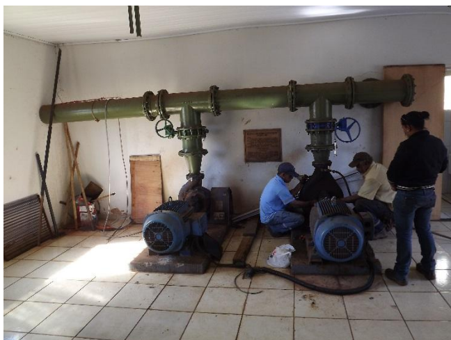
Foto 3.5 – Vista interna – Casa de bombas de recalque
