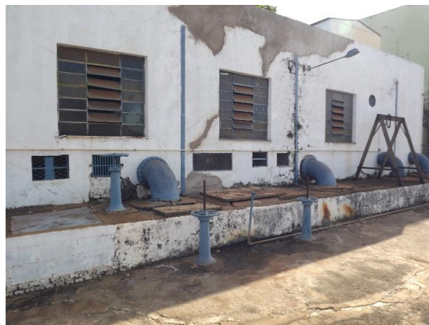
Foto 3.75 – Detalhe das tubulações de saída do RSE I ETA Pereira e entrada na EEAT
