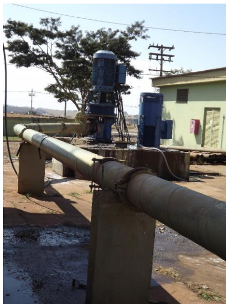
Foto 3.22 – Detalhe de tubulação de saída do Poço Tubular Profundo Comitivas
