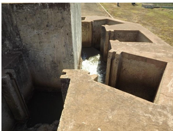
Foto 3.189 – Detalhe das cinco caixas direcionadoras para entrada do esgoto na lagoa anaeróbia – ETE III
