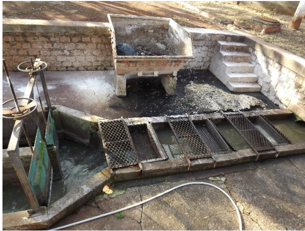
Foto 3.201 – Vista do gradeamento (3 grades de tamanhos diferentes) na ETE IV
