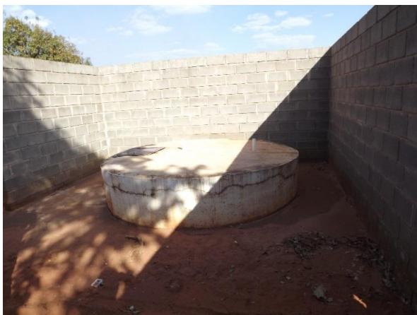
Foto 3.136 – Detalhe de reservatório pulmão da EEE Parque das Flores
