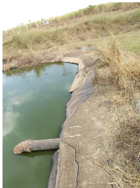
Foto 3.239 – Detalhe de desprendimento do concreto do talude de lagoa anaeróbia – ETE VII
