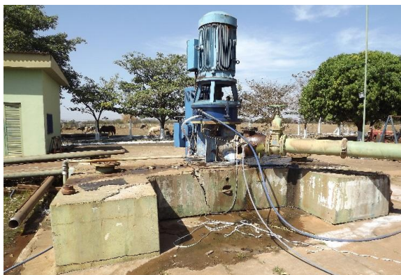
Foto 3.21 – Vista geral do Poço Tubular Profundo Comitivas
