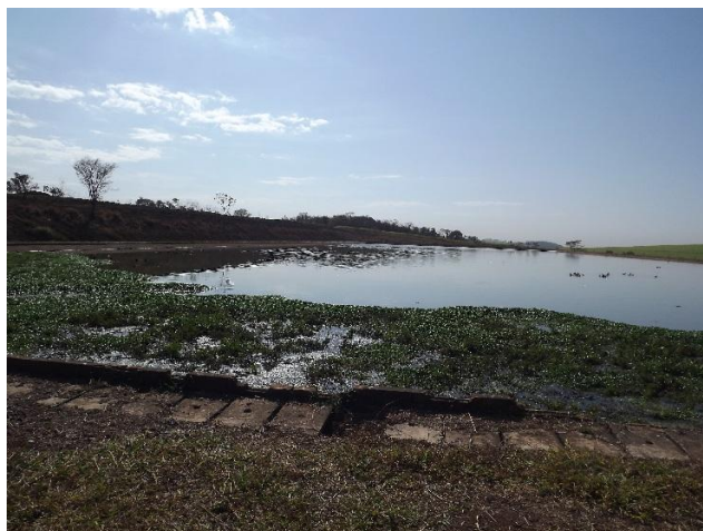
Foto 3.198 – Lagoa de maturação eutrofizada e guia danificada – Linha 2
