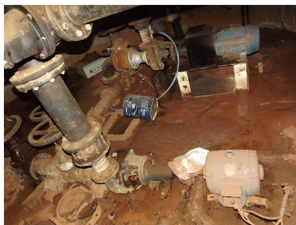
Foto 3.118 – Detalhe de vazamentos na EEAT Cristiano de Carvalho
