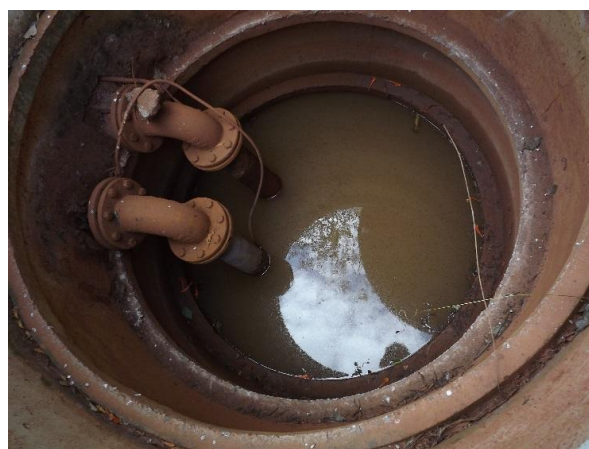
Foto 3.135 – Detalhe de poço de sucção da EEE Parque das Flores
