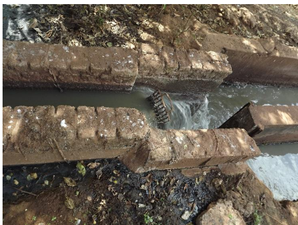
Foto 3.157 – Detalhe do gradeamento insuficiente e caixa de areia com fissuras
