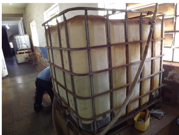
Foto 3.52 – Detalhe de reservatório de ácido fluorssilícico
