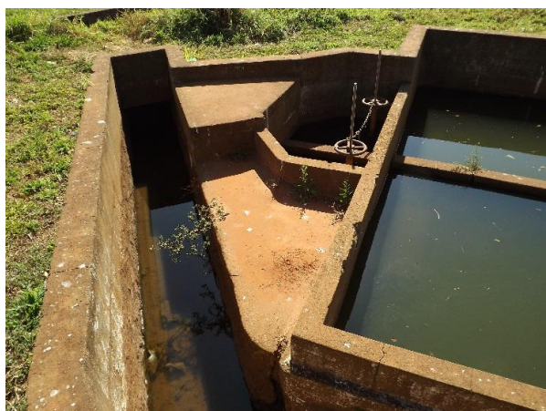
Foto 3.3 – Detalhe de canaleta na saída dos desarenadores para a captação de água bruta
