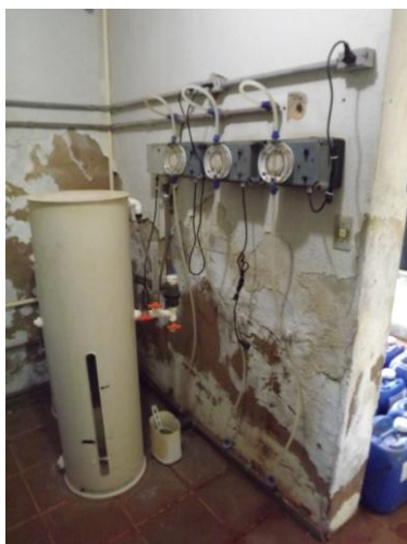
Foto 3.25 – Gerador de cloro (hipoclorito de sódio) para desinfecção (Poço Comitivas)
