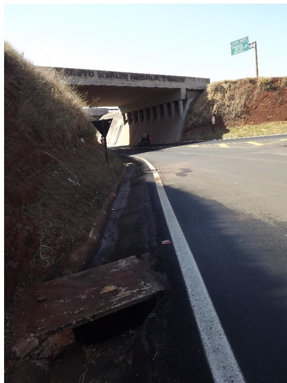
Foto 3.271 – Detalhe de estrutura de microdrenagem no ponto apresentado
