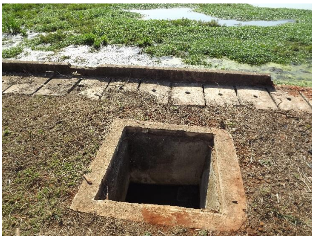
Foto 3.197 – Detalhe de caixa de passagem sem tampa e eutrofização da lagoa de maturação (ao fundo) – Linha 2
