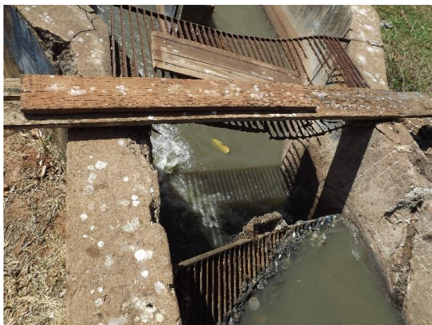
Foto 3.177 – Detalhe do gradeamento da ETE II
