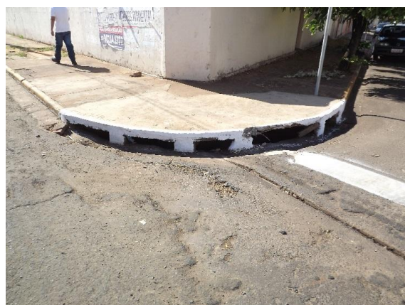
Figura 3.251 – Detalhe de bocas de lobo no cruzamento da Rua 24 com Av. 43
