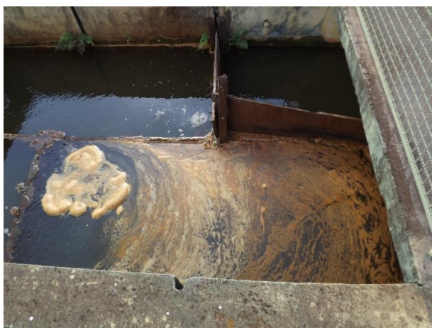
Foto 3.60 – Detalhe de acumulação de material sólido no floculador
