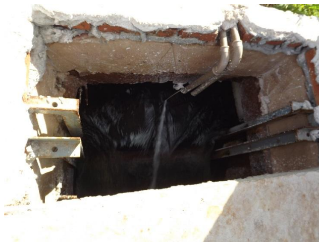
Foto 3.67 – Detalhe de local de pós-cloração na ETA Pereira
