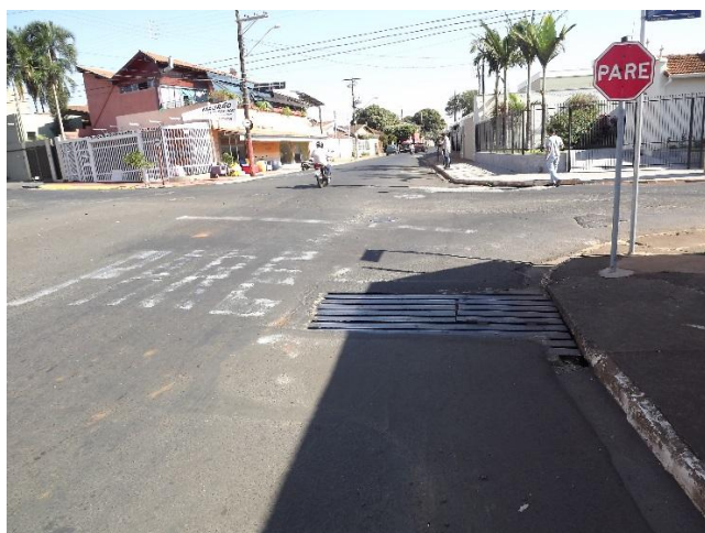
Figura 3.254 – Detalhe de boca de lobo em forma de grelha no cruzamento da Rua 24 com Av. 45
