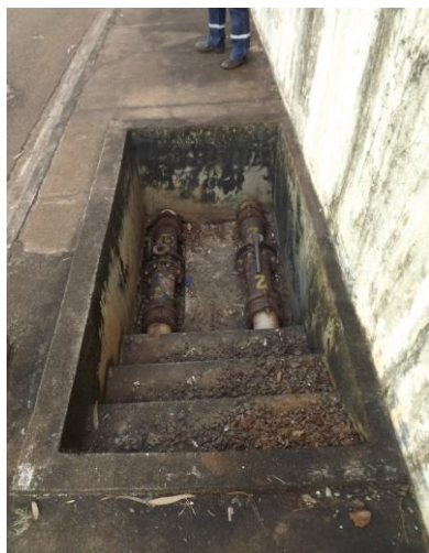
Foto 3.211 – Detalhe de tubulação de recirculação do lodo para o tanque de aeração
