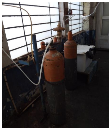
Foto 3.51 – Detalhe de cilindros de cloro em gás instalados (sistema reserva para desinfecção)
