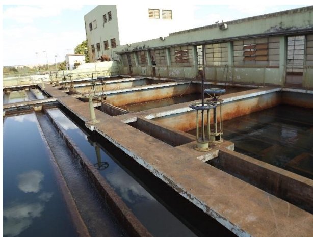
Foto 3.62 – Detalhe de saída dos decantadores e entrada dos filtros ascendentes
