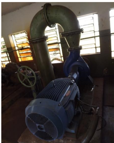
Foto 3.13 – Detalhe de conjunto motobomba na captação do Ribeirão Pitangueiras
