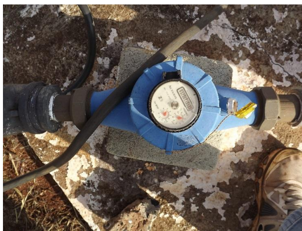
Foto 3.30 – Detalhe de macromedidor instalado no Poço Cristiano de Carvalho C11 – P01
