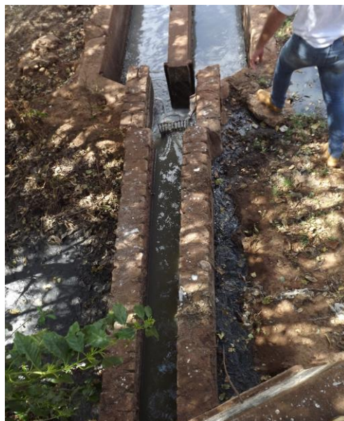
Foto 3.156 – Detalhe do vazamento na caixa de passagem
