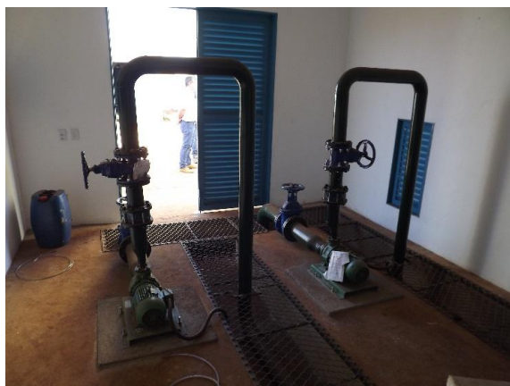
Foto 3.113 – Vista geral da EEAT II Vida Nova
