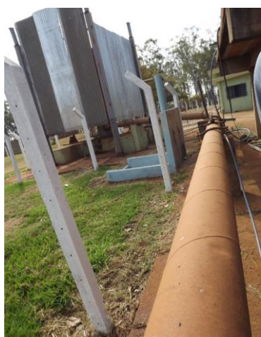
Foto 3.17 – Detalhe da tubulação de saída do Poço Barretos II
