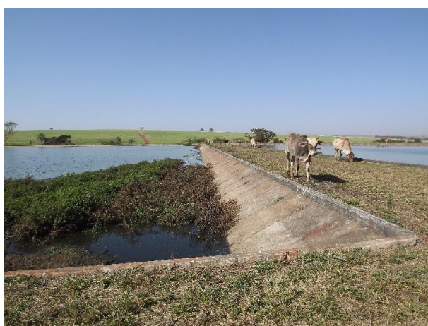
Foto 3.193 – Detalhe de eutrofização na lagoa de maturação e presença de animais na ETE III
