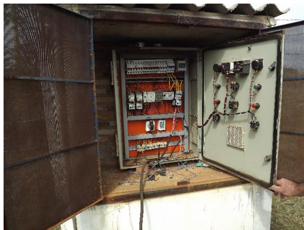
Foto 3.129 – Detalhe de painel elétrico da EEE Ibitu
