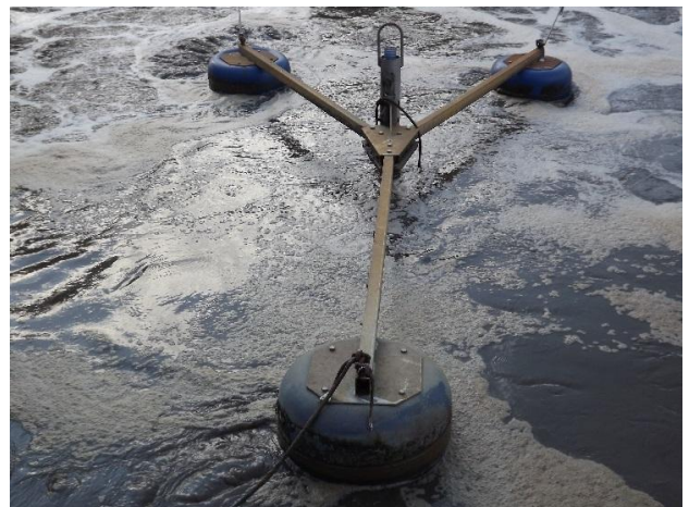
Foto 3.206 – Detalhe de aerador submerso de três hélices no tanque de aeração
