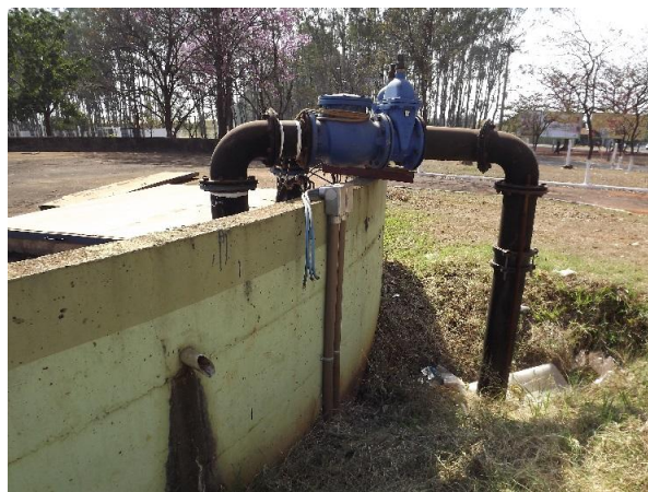
Foto 3.91 – Detalhe de tubulação de saída do RSE II Barretos II
