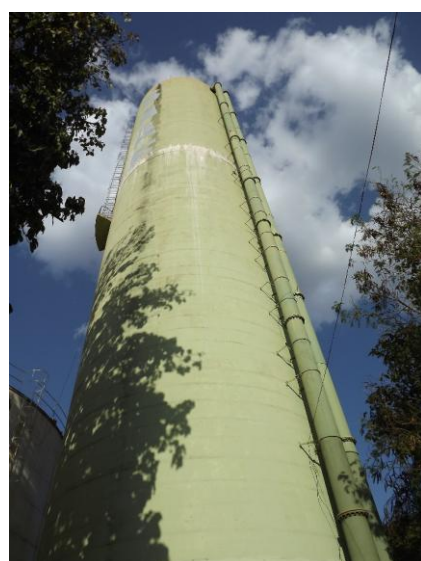
Foto 3.83 – Detalhe do REL FEB e da tubulação do extravasor
