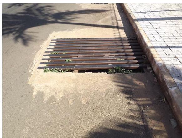
Figura 3.256 – Detalhe de boca de lobo em forma de grelha no cruzamento da Rua 24 com Av. 45
