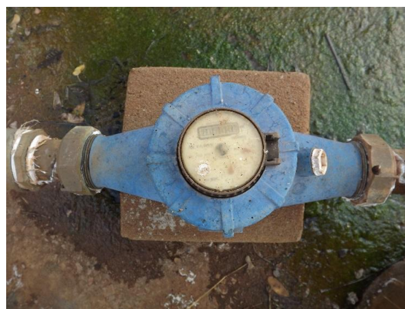
Foto 3.42 – Detalhe de macromedidor instalado no Poço Alberto Moreira
