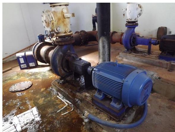
Foto 3.108 – Detalhe de conjunto motobomba da EEAT Sorvetão (com vazamento)
