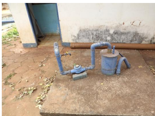
Foto 3.37 – Vista geral do Poço Ibitu
