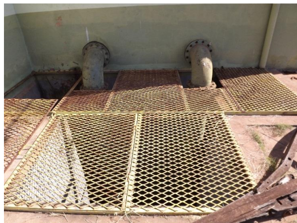
Foto 3.4 – Detalhe do poço de sucção na captação no Córrego do Aleixo
