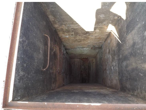
Foto 3.170 – Detalhe de vertedor seco na saída da lagoa de maturação
