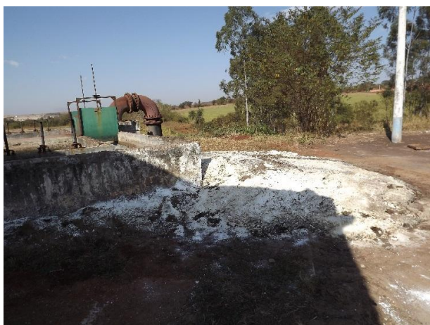
Foto 3.148 – Detalhe do acúmulo de areia ao lado do desarenador da EEEB II – ETE III
