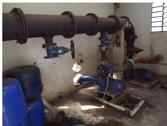
Foto 3.152 – Vista dos conjuntos motobomba da EEEB ETE IV
