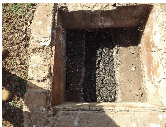
Foto 3.164 – Detalhe de vertedor entupido na saída da lagoa anaeróbia e entrada na lagoa facultativa
