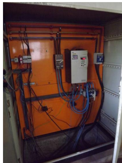
Foto 3.116 – Detalhe de painel elétrico da EEAT FEB
