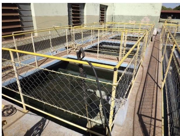
Foto 3.48 – Vista geral do conjunto de quatro filtros ascendentes
