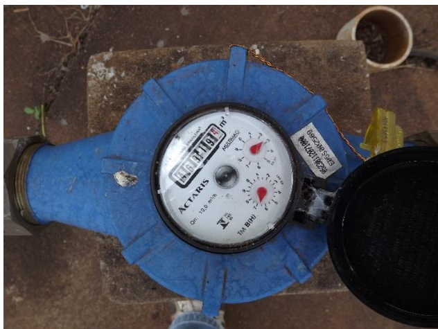
Foto 3.33 – Detalhe de macromedidor instalado no Poço Cristiano de Carvalho C24 – P03
