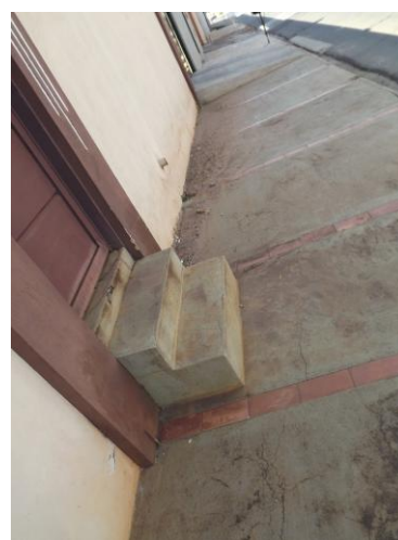
Figura 3.259 – Detalhe de casa, com elevação na porta e marca de água de último alagamento no muro
