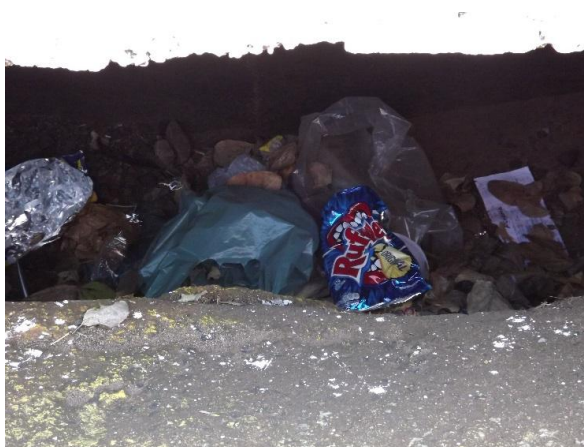
Figura 3.252 – Detalhe de resíduos sólidos acumulados em boca de lobo no cruzamento da Rua 24 com Av. 43
