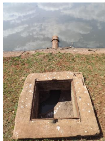
Foto 3.160 – Caixa de passagem sem tampa na entrada da lagoa aneróbia
