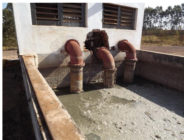
Foto 3.149 – Detalhe de poço de sucção da EEEB II – ETE III
