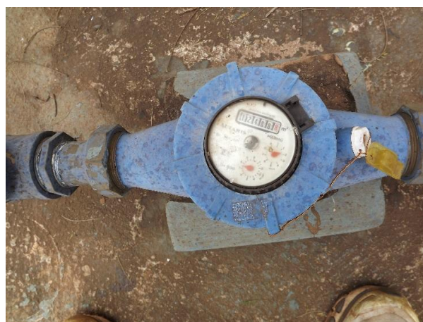
Foto 3.38 – Detalhe de macromedidor instalado no Poço Ibitu
