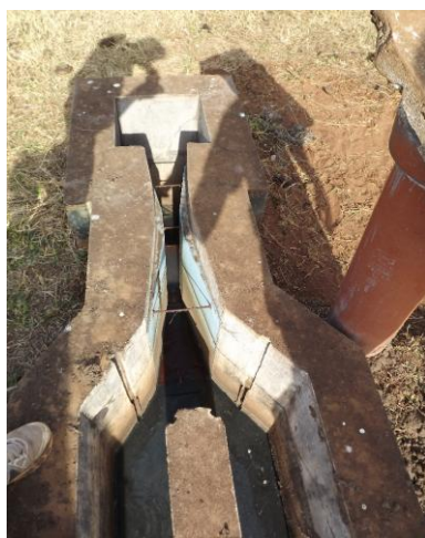
Foto 3.231 – Detalhe da Calha Parshall após os desarenadores
