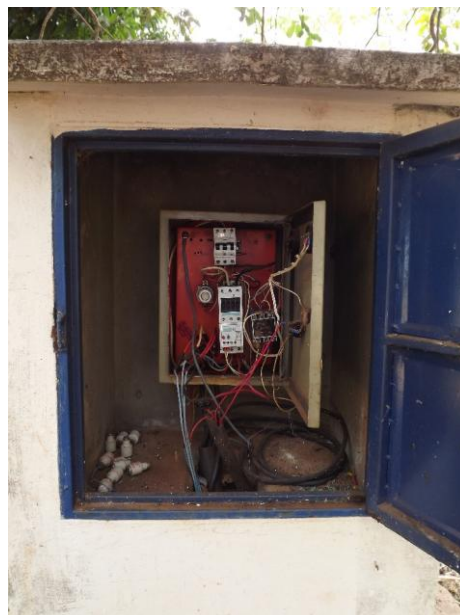
Foto 3.40 – Detalhe do painel elétrico do Poço Ibitu
