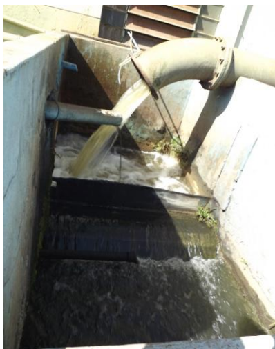
Foto 3.44 – Detalhe de adutora de entrada da ETA e ponto de aplicação de policloreto de alumínio (coagulante) e carvão ativado
