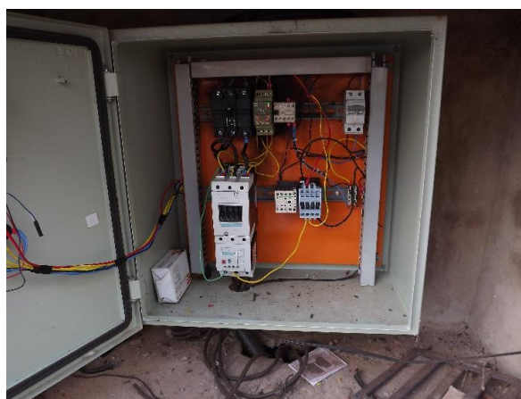
Foto 3.43 – Detalhe do painel elétrico do Poço Alberto Moreira
