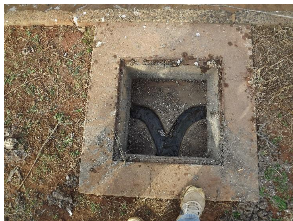
Foto 3.232 – Caixa de passagem direcionadora para tubulações de entrada da ETE VI
