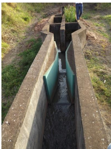
Foto 3.221 – Detalhe da Calha Parshall após os desarenadores
