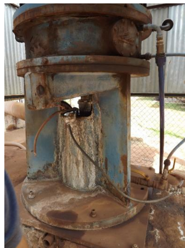
Foto 3.16 – Detalhe da base estrutural que recebe a bomba do Poço Barretos II
