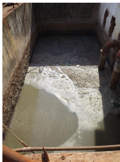
Foto 3.143 – Detalhe de sólidos grosseiros acumulados no poço de sucção da EEEB I – ETE III
