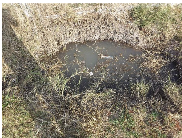
Foto 3.141 – Detalhe de vazamento na entrada da EEE Jardim Caiçara
