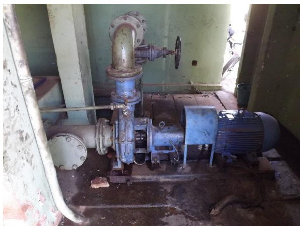
Foto 3.103 – Conjunto motobomba 1 da EEAT ETA Baroni
