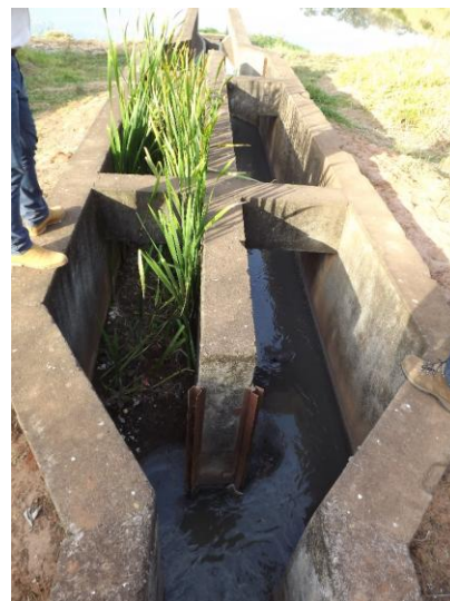
Foto 3.220 – Caixa de areia com crescimento de vegetação na ETE V
