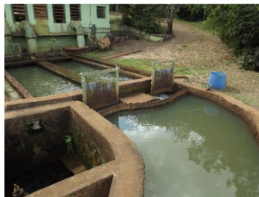
Foto 3.10 – Detalhe dos dois desarenadores na captação de água bruta do Ribeirão Pitangueiras
