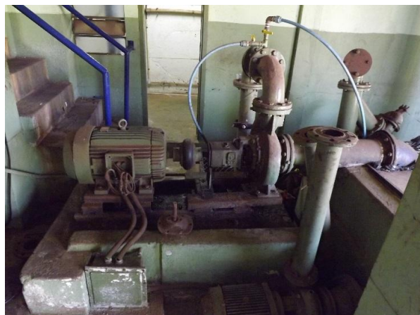
Foto 3.104 – Conjunto motobomba 2 da EEAT ETA Baroni
