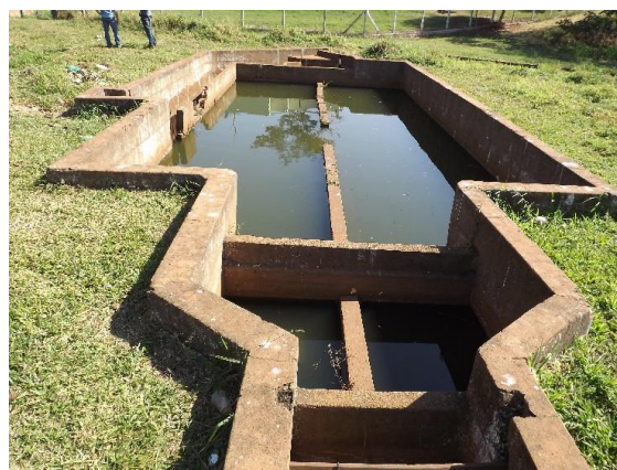
Foto 3.2 – Detalhe do gradeamento e das duas caixas de areia na Captação no Córrego do Aleixo
