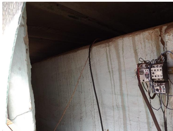
Foto 3.71 – Detalhe de painel elétrico inadequado e cobertura insuficiente no RSE São Benedito
