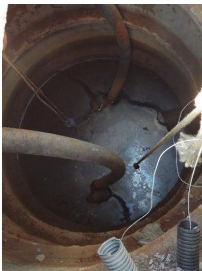
Foto 3.130 – Detalhe de Poço de Sucção sem os conjuntos motobomba (furtados) na EEE Jd. Oasis
