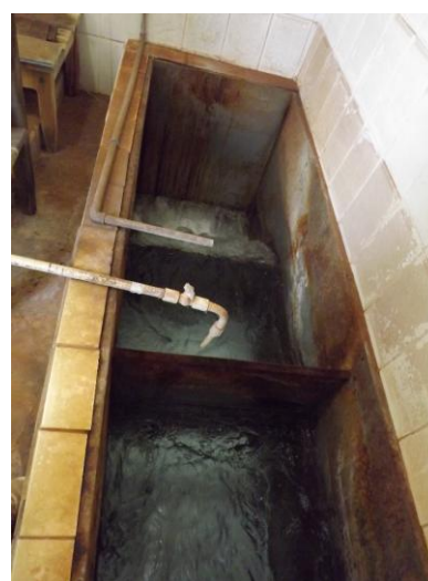
Foto 3.20 – Tanque de contato com cloro e flúor na saída do Poço Barretos II
