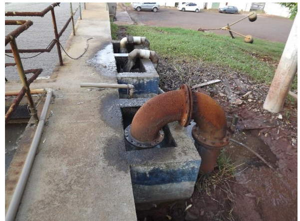
Foto 3.204 – Detalhe de tubulações de entrada no tanque de aeração
