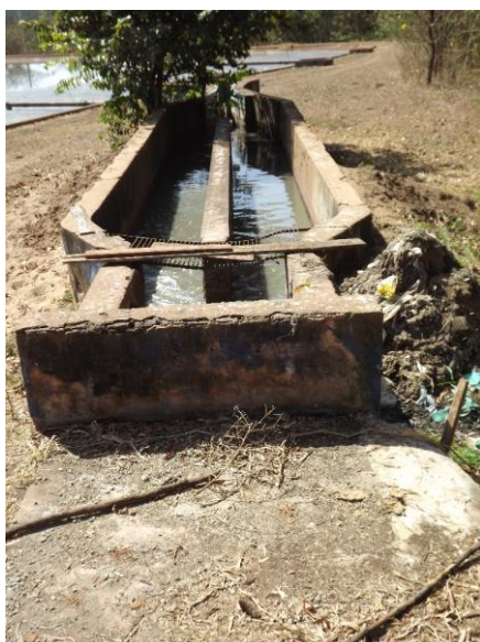
Foto 3.175 – Detalhe do tratamento preliminar
