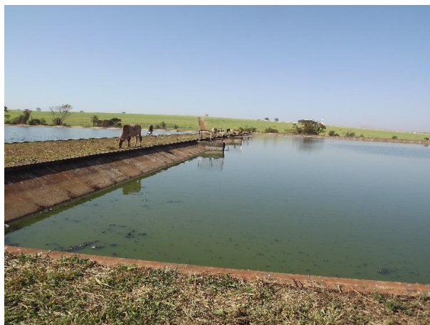
Foto 3.192 – Saída da lagoa anaeróbia e presença de animais na ETE III
