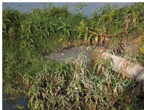
Foto 3.224 – Detalhe de crescimento excessivo de vegetação na tubulação de entrada da lagoa
