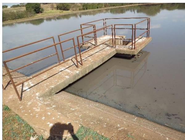
Foto 3.166 – Detalhe de vertedor na saída da lagoa facultativa e entrada na lagoa de maturação
