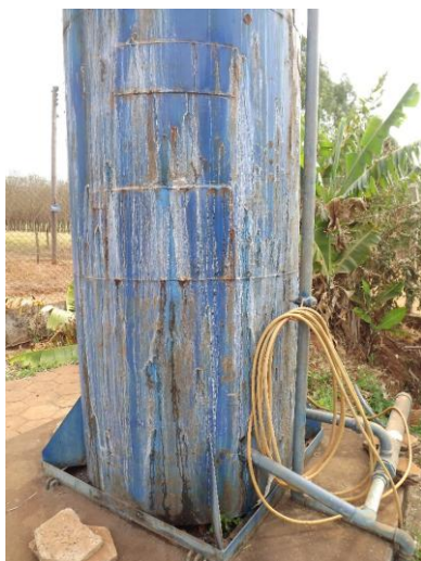
Foto 3.100 – Detalhe de corrosão do REL Ibitu
