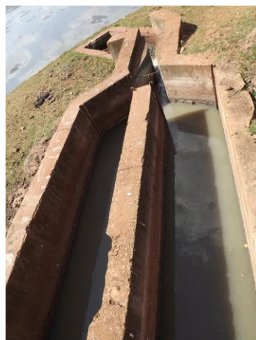
Foto 3.158 – Detalhe de caixa de areia e Calha Parshall ao fundo
