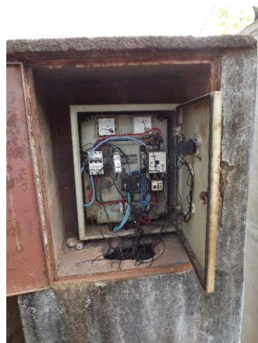
Foto 3.34 – Detalhe de painel elétrico do Poço Cristiano de Carvalho C24 – P03
