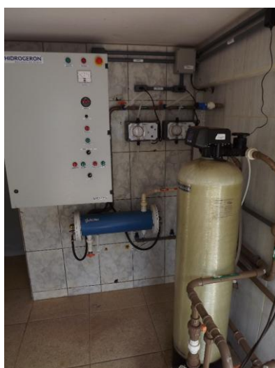
Foto 3.19 – Gerador de cloro (hipoclorito de sódio) para desinfecção
