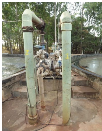
Foto 3.210 – Elevatória de recirculação de lodo
