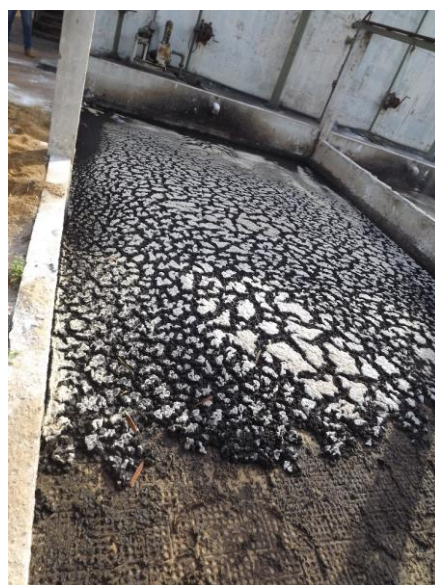
Foto 3.216 – Lodo em processo de secagem no leito
