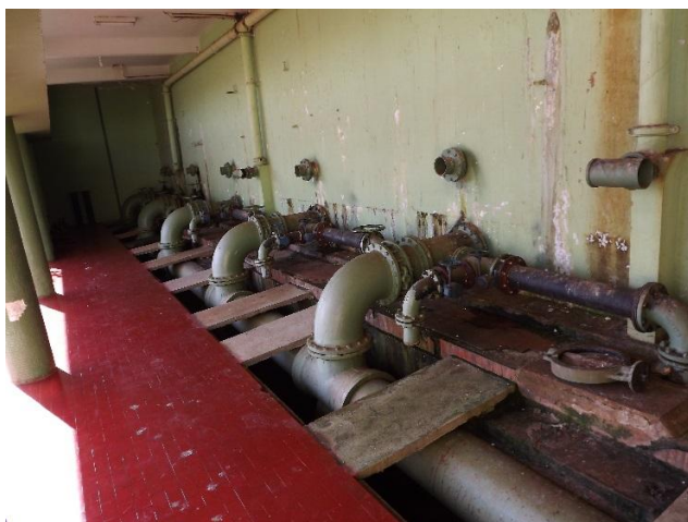
Figura 3.66 – Detalhe de tubulações de limpeza de filtros
