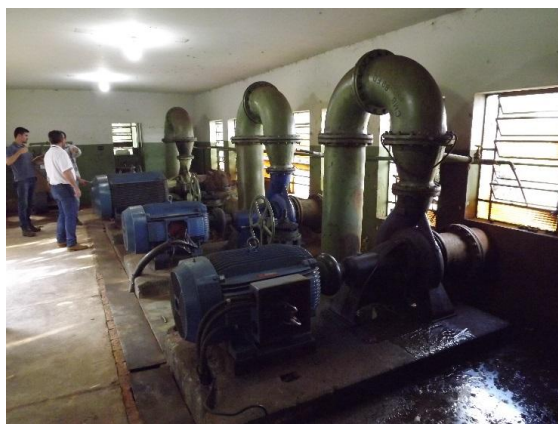
Foto 3.12 – Casa de bombas de recalque de água bruta na captação do Ribeirão Pitangueiras
