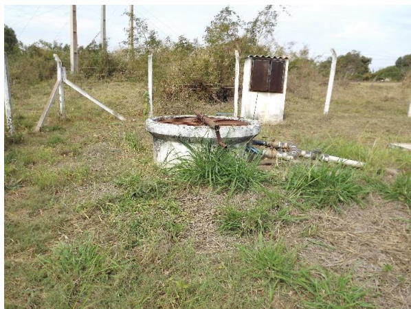
Foto 3.128 – Vista de Poço de Sucção (à frente) e painel elétrico (ao fundo) na EEE Ibitu
