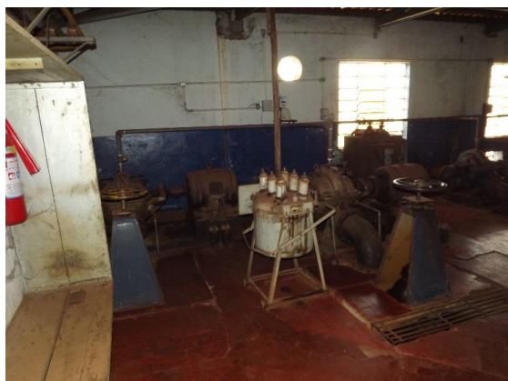
Foto 3.109 – Vista geral da EEAT ETA Pereira
