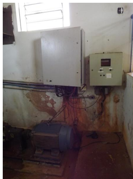
Foto 3.124 – Detalhe de painel elétrico da EEAT Comitivas
