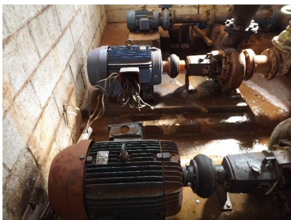
Foto 3.121 – Vista geral da EEAT I Barretos II
