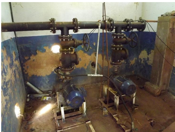
Foto 3.138 – Detalhe de conjuntos motobomba da EEE Jardim Caiçara
