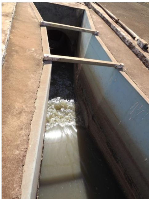
Foto 3.146 – Calha Parshall da EEEB II – ETE III
