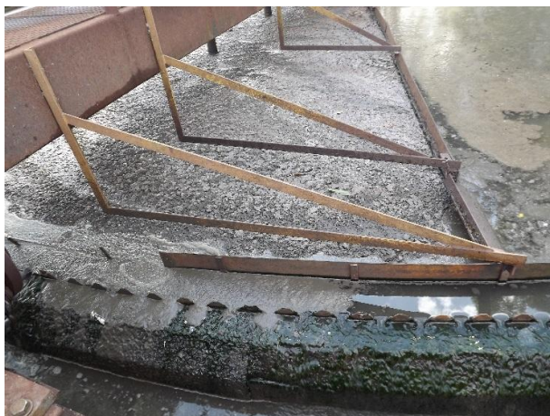
Foto 3.209 – Detalhe de raspador de superfície e canaleta de drenagem do decantador secundário
