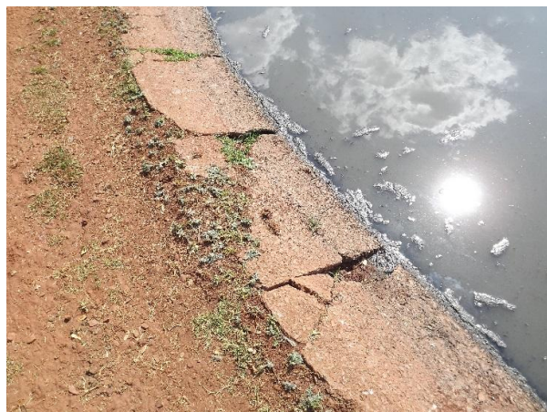
Foto 3.162 – Detalhe de problema de fissuras no talude da lagoa anaeróbia
