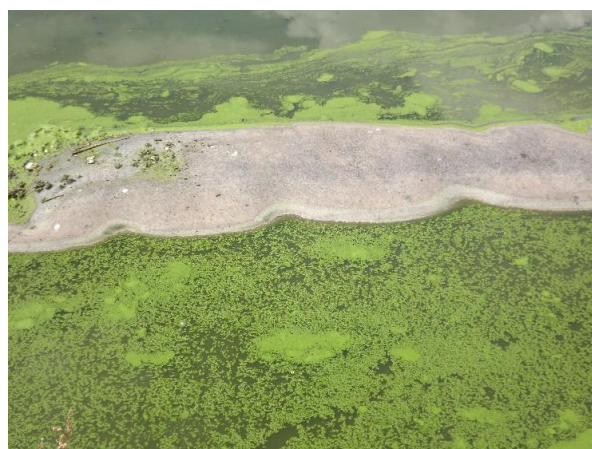
Foto 3.243 – Detalhe da eutrofização e do desprendimento da manta geotêxtil na lagoa facultativa – ETE VII Ibitu
