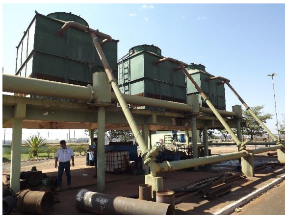
Foto 3.23 – Sistema de resfriamento de água na saída do Poço Tubular Profundo Comitivas
