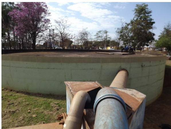
Foto 3.90 – Detalhe de interligação e do RSE II Barretos II (ao fundo)
