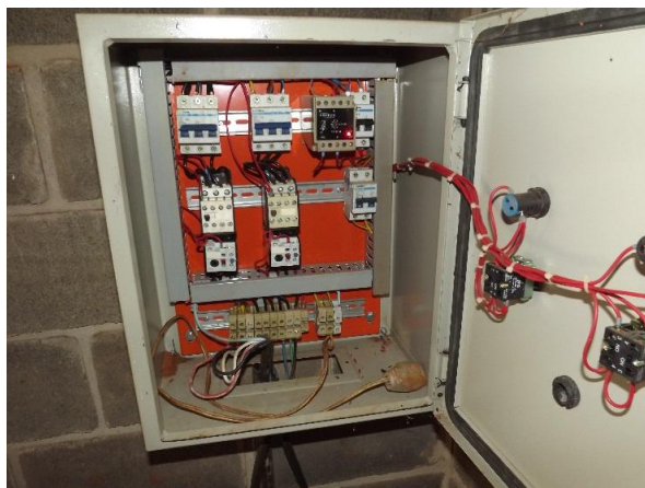
Foto 3.137 – Detalhe de painel elétrico da EEE Parque das Flores
