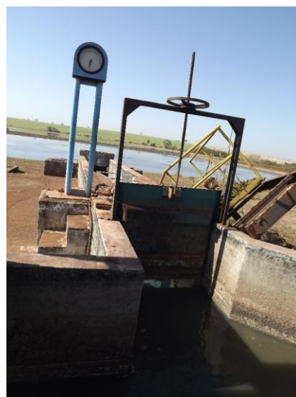
Foto 3.188 – Detalhe de entrada do esgoto bruto na Calha Parshall da Linha 1 – ETE III
