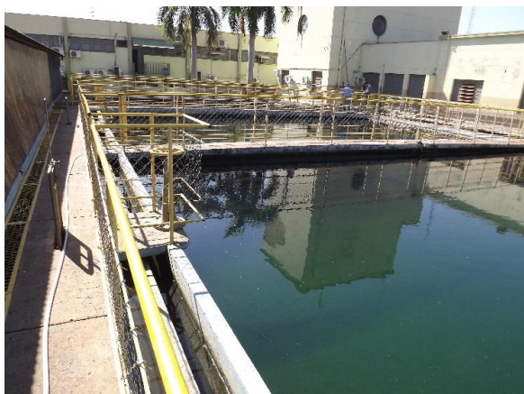
Foto 3.46 – Detalhe dos dois decantadores da ETA Baroni
