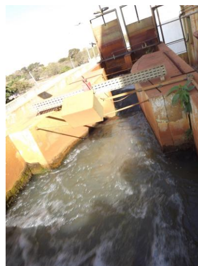
Foto 3.57 – Detalhe de macromedidor de vazão e Calha Parshall
