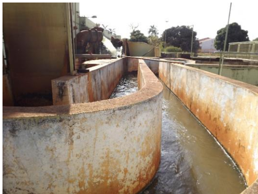
Foto 3.58 – Vista geral de tanque de contato antes da entrada nos floculadores
