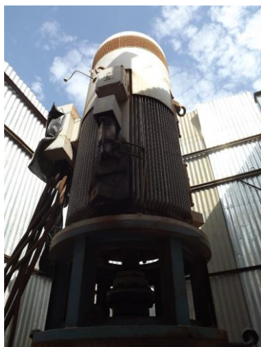
Foto 3.15 – Vista geral do Poço Tubular Profundo Barretos II
