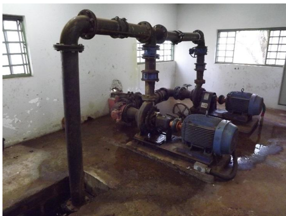
Foto 3.115 – Vista geral da EEAT FEB
