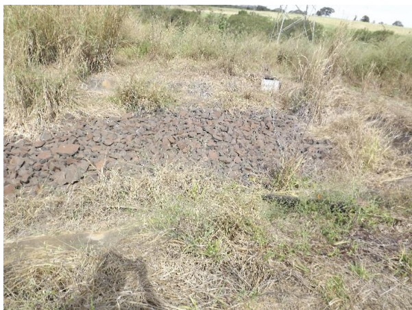
Foto 3.244 – Detalhe de filtro biológico desativado na ETE VII - Ibitu
