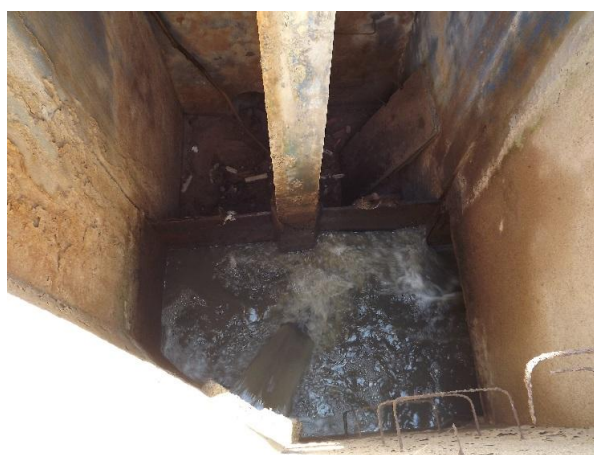
Foto 3.174 – Detalhe da entrada na caixa de passagem da ETE II
