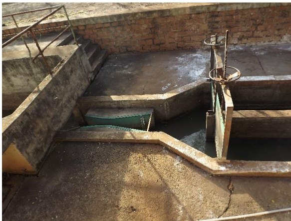
Foto 3.203 – Detalhe da Calha Parshall após os desarenadores
