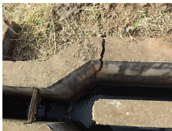
Foto 3.230 – Detalhe de saída do gradeamento e entrada na caixa de areia (com trinca)
