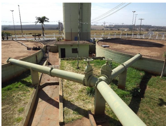
Foto 3.94 – Detalhe das tubulações de entrada do RSE I e RSE II Comitivas
