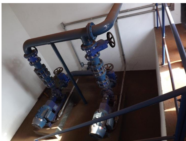
Foto 3.119 – Vista geral da EEAT Mais Parque
