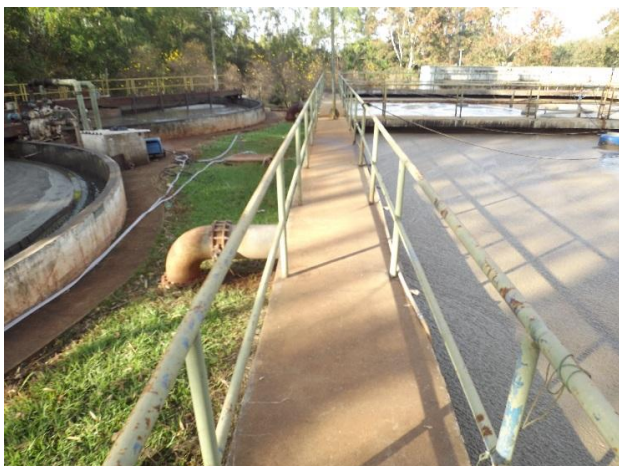
Foto 3.207 – Detalhe de saída do tanque de aeração (à dir.) e tubulação de entrada dos decantadores secundários (à esq.)
