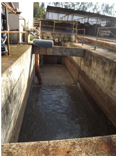
Foto 3.151 – Detalhe de poço de sucção da EEEB ETE IV
