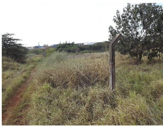
Foto 3.228 – Detalhe da falta de alambrado (furtado) na ETE V
