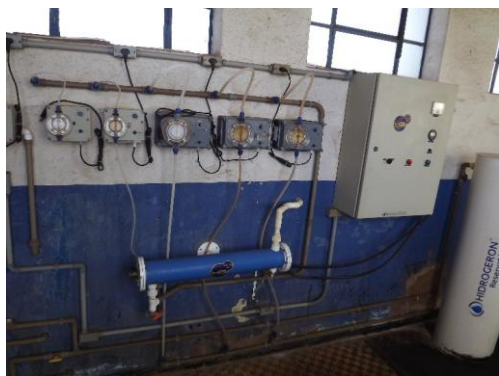
Foto 3.50 – Detalhe do gerador de cloro (hipoclorito de sódio) para desinfecção
