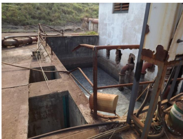
Foto 3.142 – Detalhe do poço de sucção da EEEB I – ETE III
