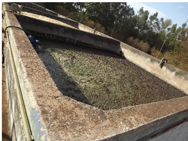
Foto 3.212 – Vista de um dos digestores de lodo biológico excedente
