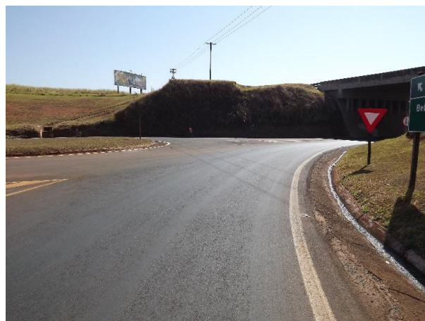
Foto 3.269 – Detalhe de rotatória que sofre alagamentos nas imediações do Viaduto Dr. Salim Thomé
