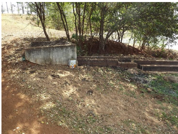
Foto 3.155 – Detalhe da entrada do esgoto na caixa de passagem da ETE I
