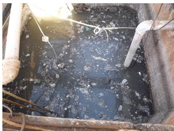
Foto 3.140 – Detalhe de sólidos grosseiros acumulados na EEE Jardim Caiçara
