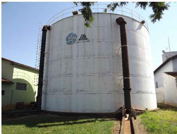
Foto 3.72 – Vista geral do RAP Sorvetão, com detalhe para extravasor
