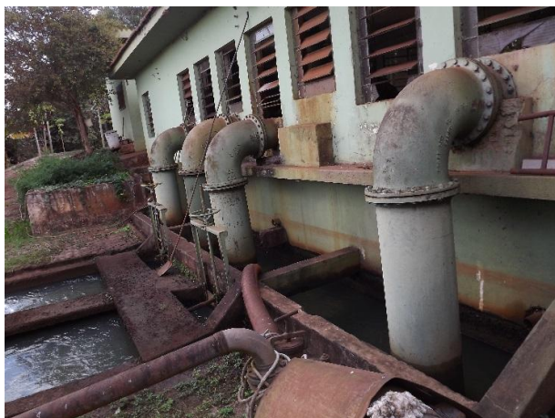
Foto 3.11 – Vista externa – Casa de bombas de recalque
