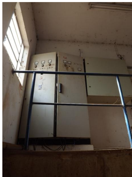
Foto 3.145 – Detalhe de painel elétrico da EEEB I – ETE III
