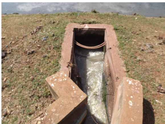
Foto 3.159 – Detalhe de caixa de passagem para a lagoa anaeróbia
