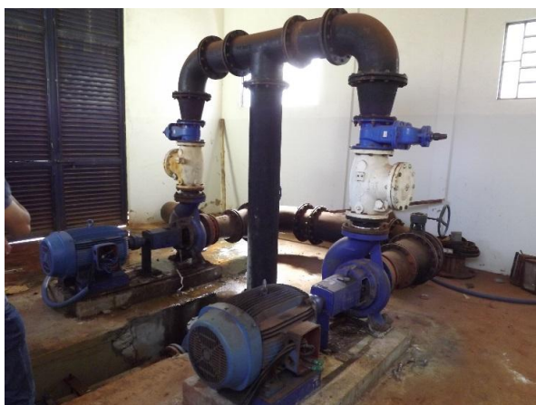
Foto 3.107 – Vista geral da EEAT Sorvetão
