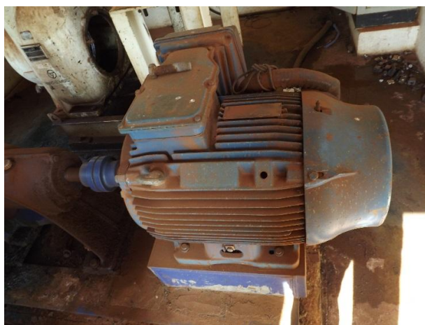
Foto 3.150 – Detalhe de conjunto motobomba da EEEB II – ETE III
