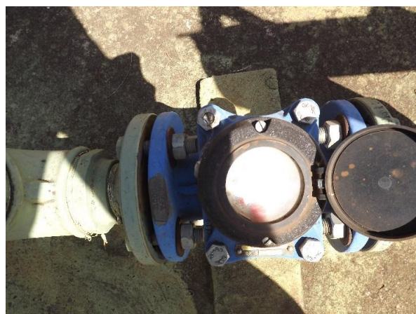
Foto 3.36 – Detalhe de macromedidor instalado no Poço São Francisco
