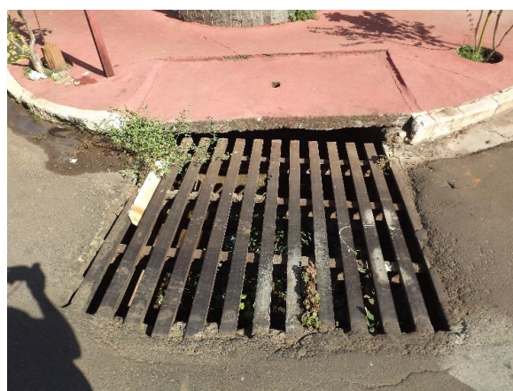
Figura 3.257 – Detalhe de boca de lobo em forma de grelha no cruzamento da Rua 24 com Av. 45
