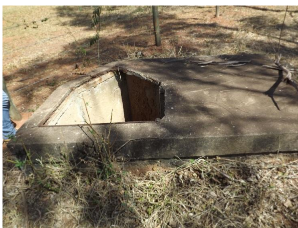
Foto 3.173 – Detalhe da entrada do esgoto na caixa de passagem da ETE II
