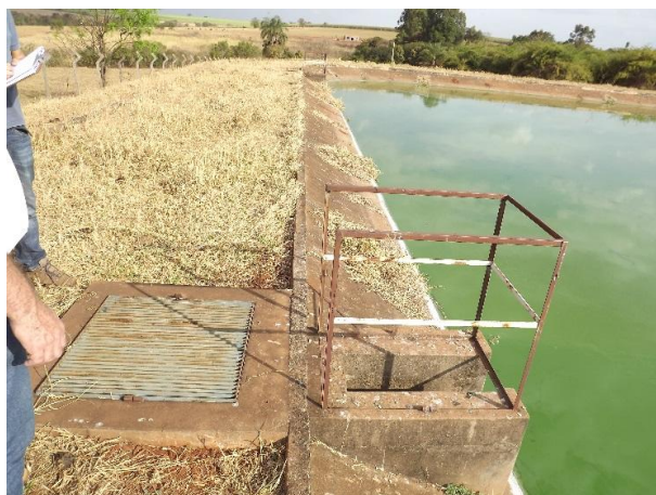
Foto 3.235 – Detalhe de vertedor para a saída do efluente da lagoa de estabilização
