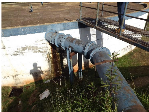
Foto 3.76 – Detalhe da tubulação de entrada do RSE II ETA Pereira
