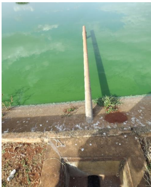
Foto 3.233 – Detalhe de entrada do efluente na lagoa de estabilização
