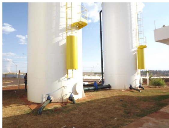
Foto 3.81 – Detalhe de interligação do RAP I e RAP II Vida Nova
