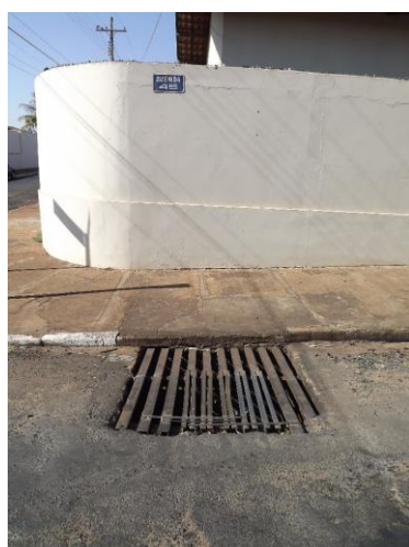
Figura 3.258 – Detalhe de boca de lobo em forma de grelha no cruzamento da Rua 26 com Av. 45
