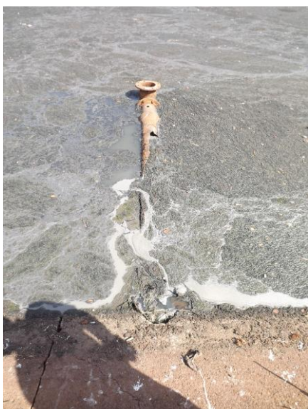
Foto 3.163 – Detalhe de tubulação de saída da lagoa anaeróbia
