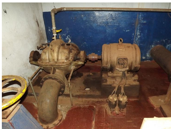
Foto 3.110 – Detalhe de conjunto motobomba na EEAT ETA Pereira
