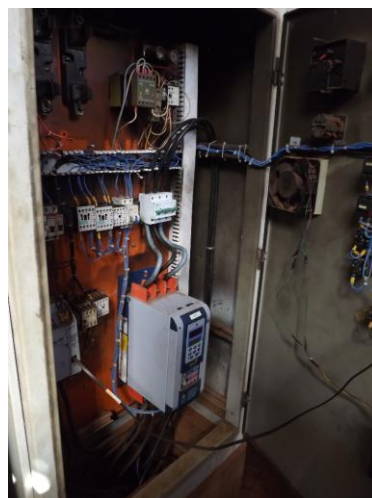
Foto 3.122 – Detalhe de painel elétrico na EEAT I Barretos II
