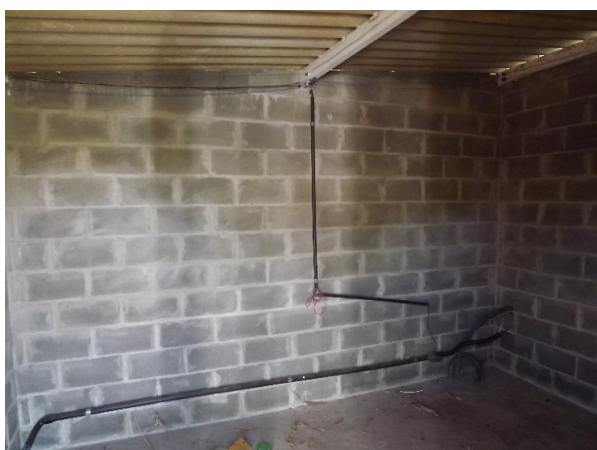
Foto 3.132 – Vista da casa de abrigo de painéis elétricos s/ equipamentos na EEE Jd. Oasis
