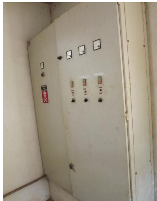
Foto 3.154 – Detalhe de painel elétrico da ETE IV
