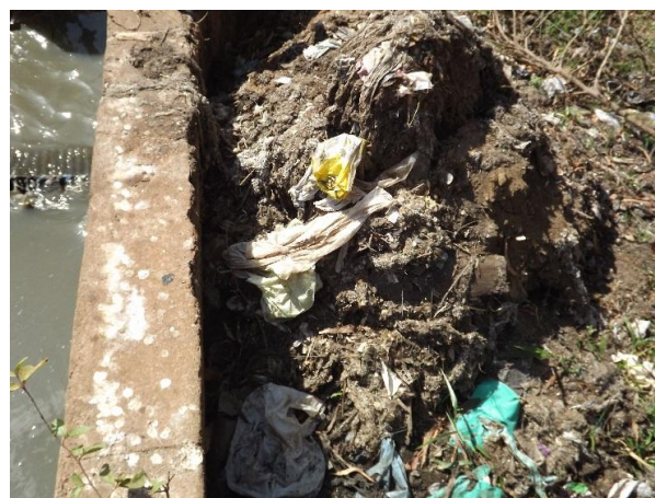
Foto 3.176 – Detalhe do acúmulo de sólidos grosseiros retidos no gradeamento
