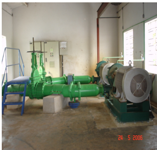
Vista casa de bombas CAP 1
