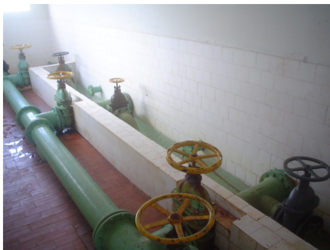
Saída Água Tratada ETA 1
