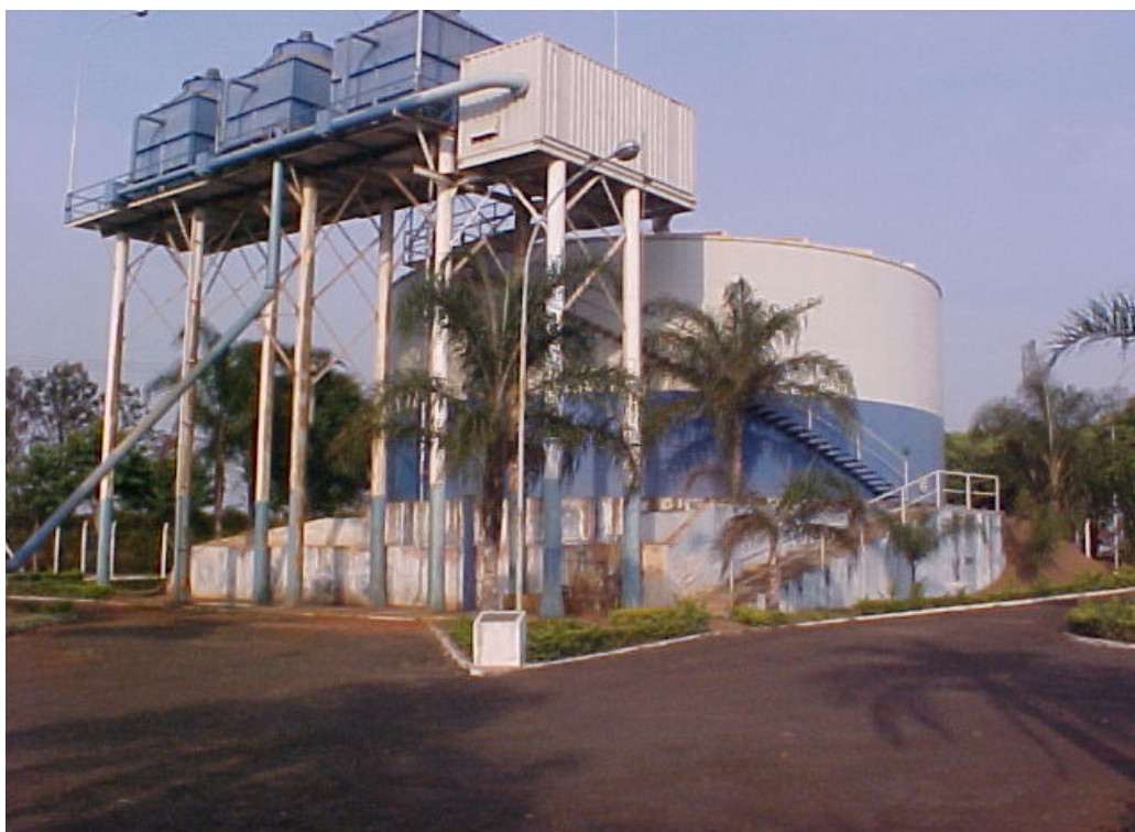
Vista da Torre de Resfriamento do Poço P1
