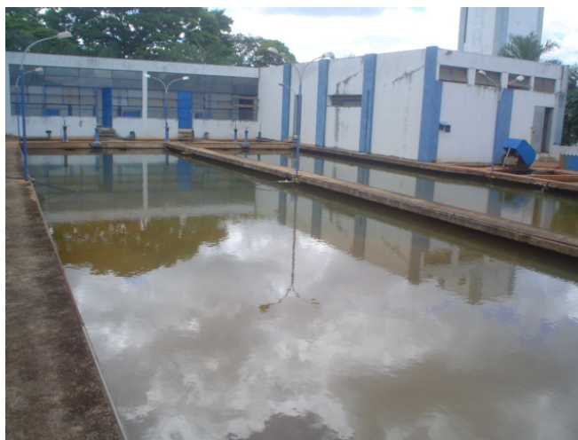
Vista dos Decantadores ETA 2
