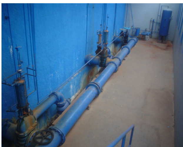
Sistema de acionamento hidráulico ETA 2
