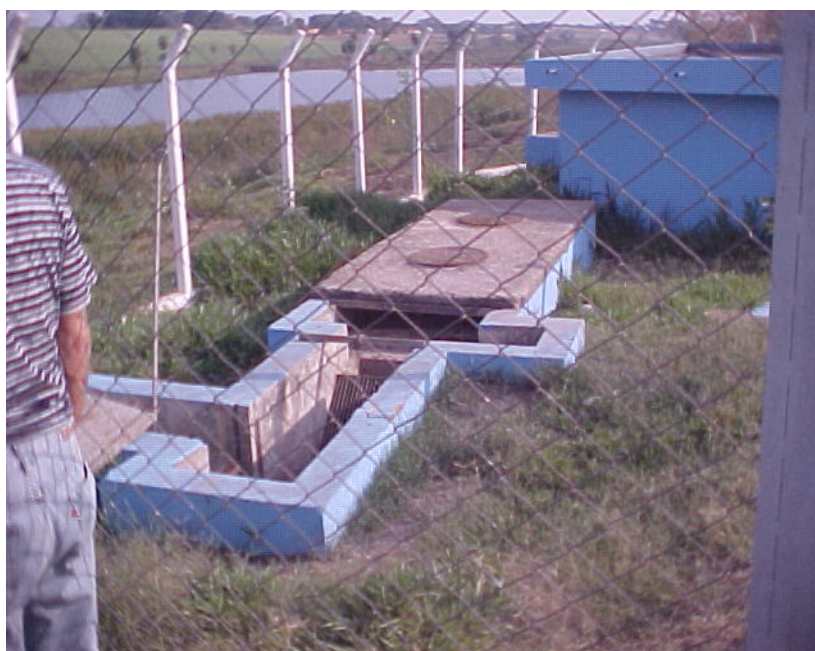
Canal de Chegada de Esgoto Bruto na Elevatória de Esgoto
