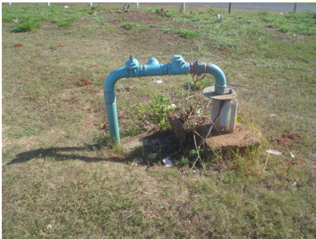
Vista de Poço Artesiano
