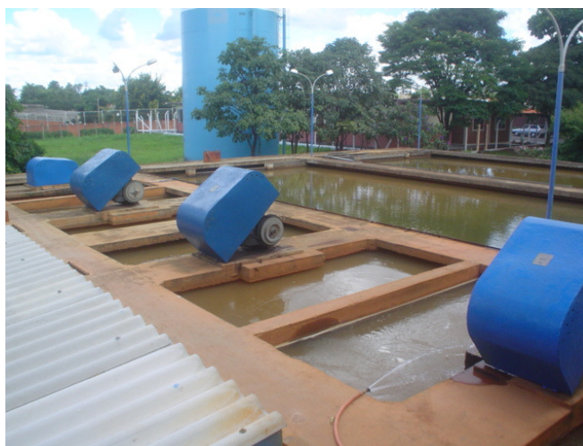
Vista dos Floculadores ETA 2
