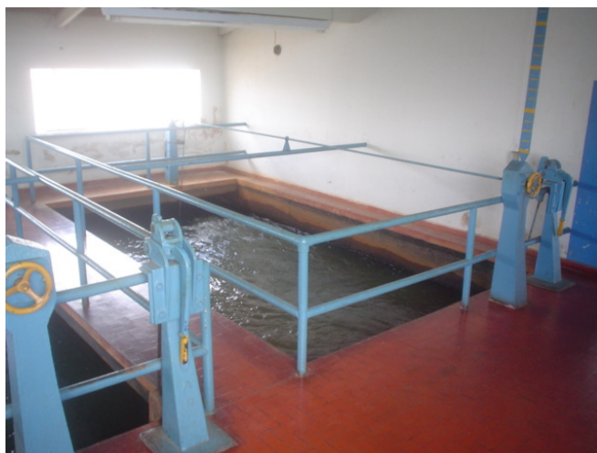
Vista dos Filtros ETA 1
