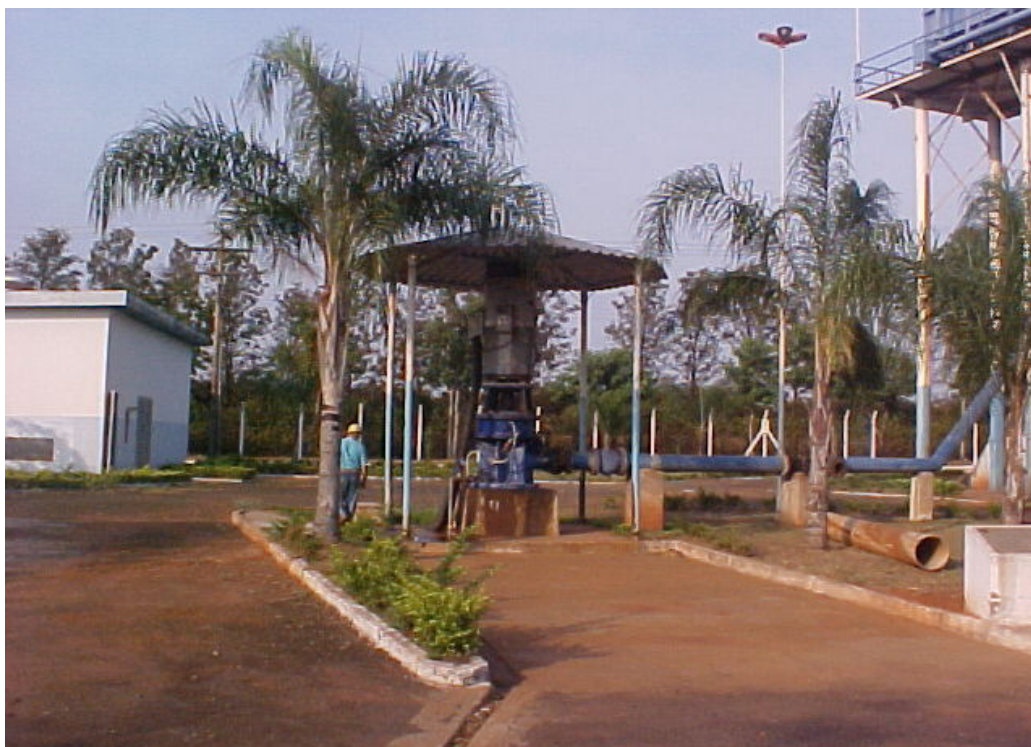
Bomba de eixo prolongado – Poço P1
