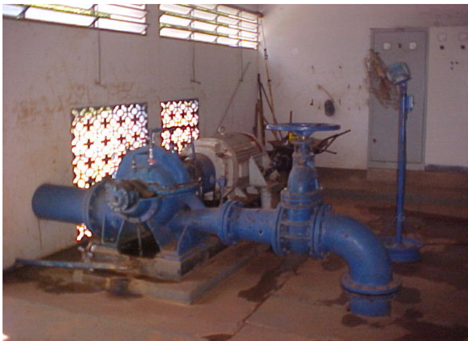
Vista da Casa de Bombas CAP 2
