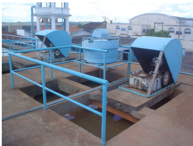
Vista do Floculador ETA 1
