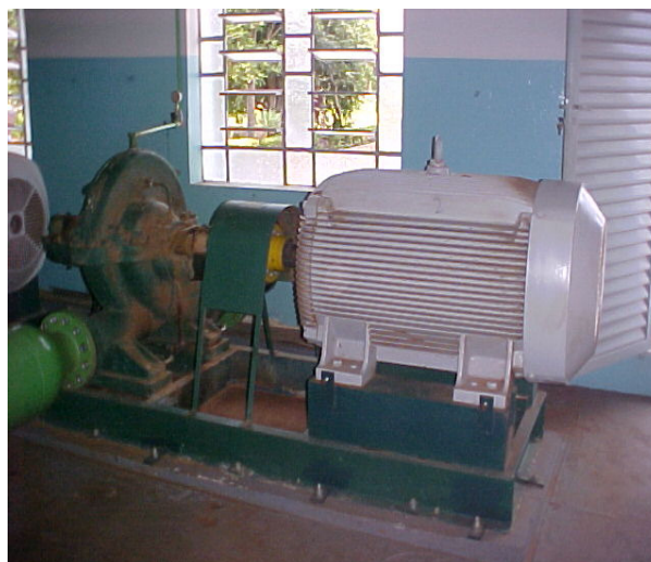
Vista da bomba da CAP 1
