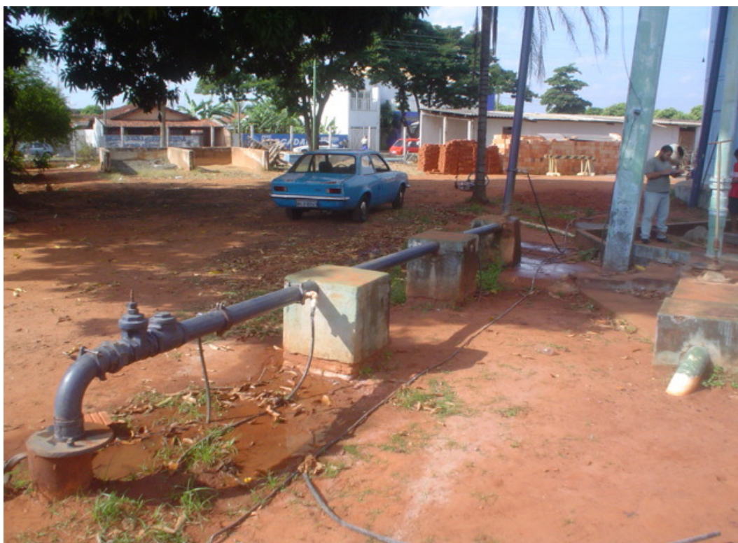
Vista de Poço Artesiano
