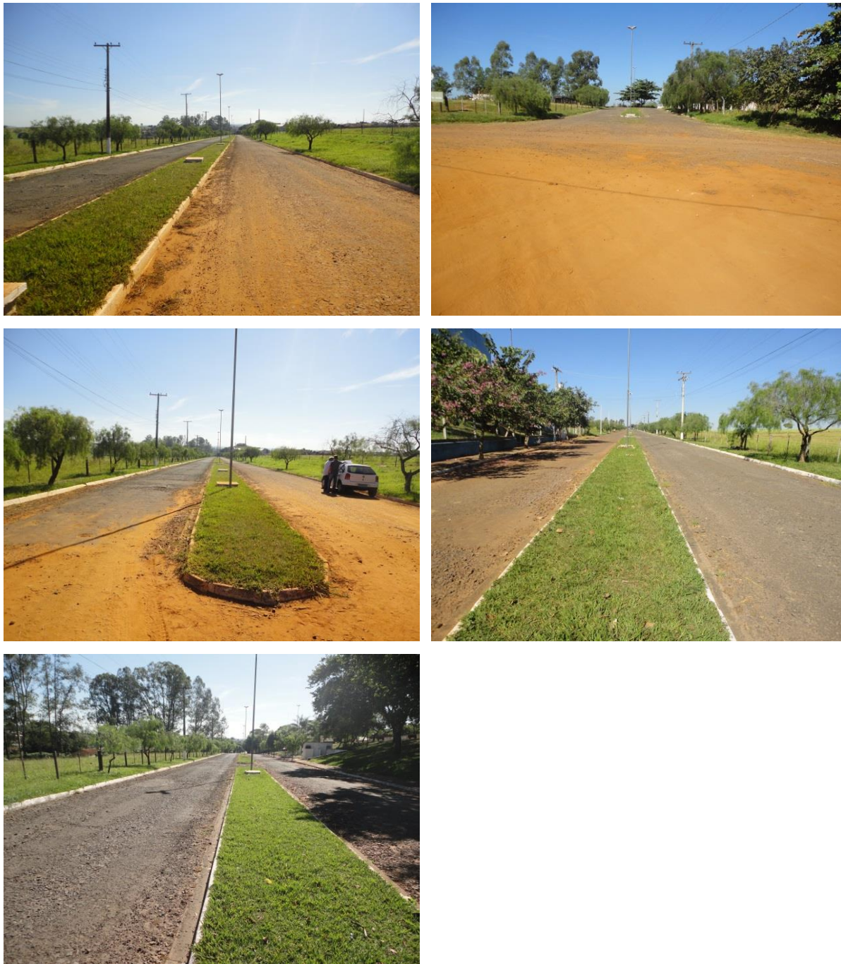
Figura 41. Enxurradas e destruição de pavimento na Avenida Luiz Marega e adjacências
