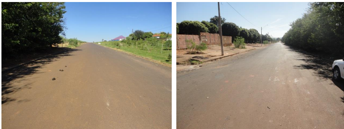
Figura 42. Enxurradas e destruição de pavimento no Conjunto Habitacional Nosso Teto e adjacências
