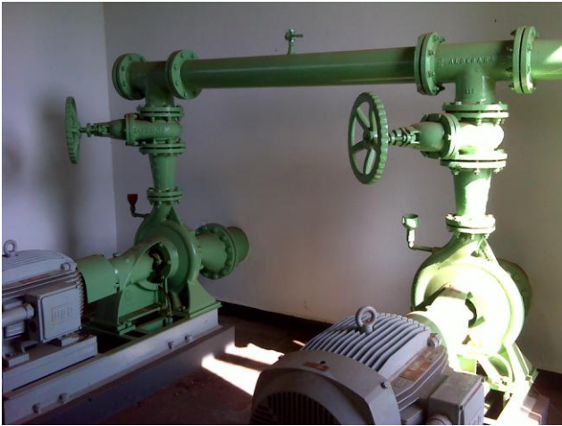
FOTO 4.7 – VISTA DAS BOMBAS DA EEAT 1
