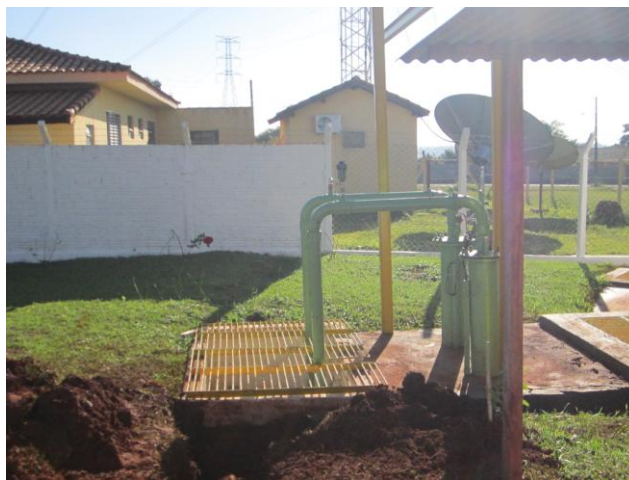
FOTO 4.9 – BOOSTER ZONA ALTA.
