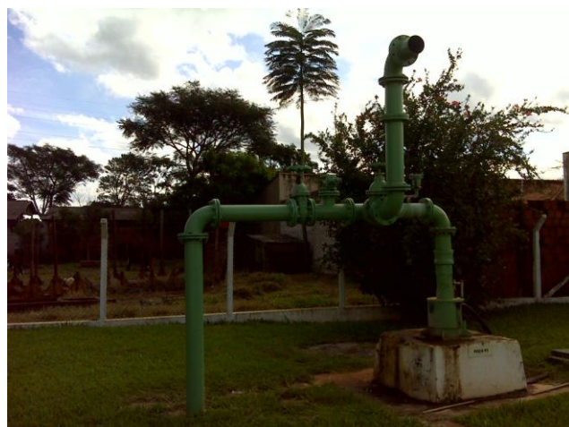
FOTO 4.2 – POÇO PROFUNDO P5
