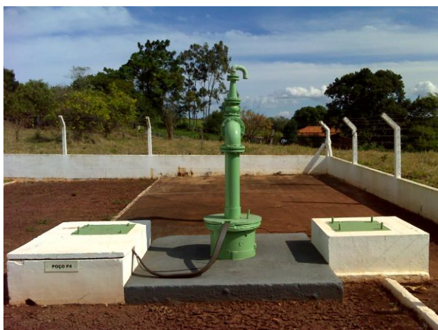
FOTO 4.1 – POÇO PROFUNDO P4
