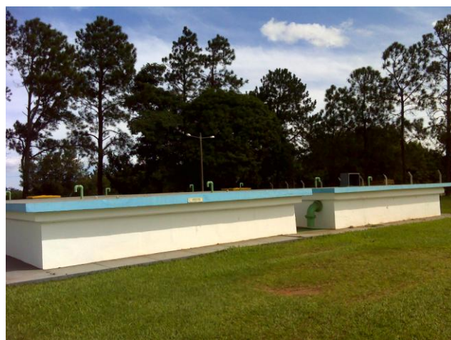
FOTO 4.4 – RESERVATÓRIOS SEMI-ENTERRADOS R1 E R2
