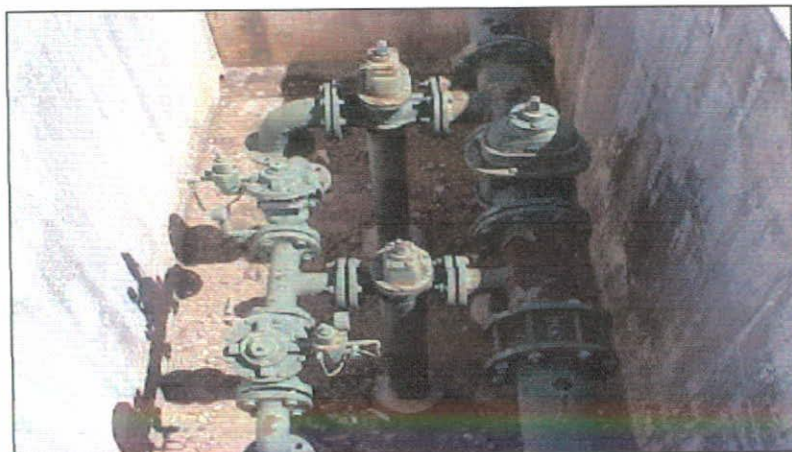
Foto 5 - Válvulas de proteção da AAB na saída da EEB02
