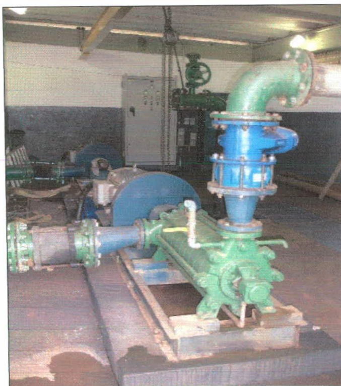
Foto 4 - Estação elevatória de água bruta - EEAB02
