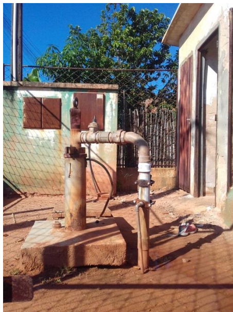
Foto 3.10 – Identificação do Poço: P09
