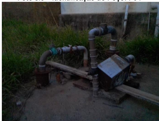
Foto 3.8 – Identificação do Poço: P07
