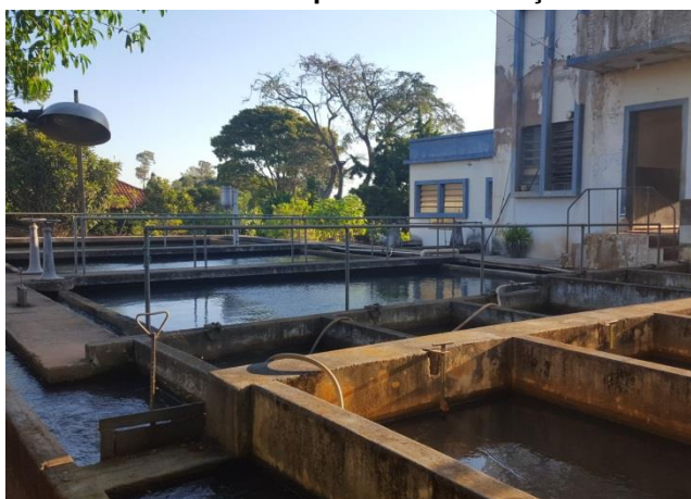
Foto 3.21 – Tanques de tratamento
