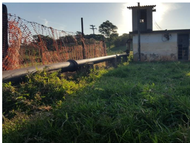
Foto 3.17 – Identificação da adutora de recalque
