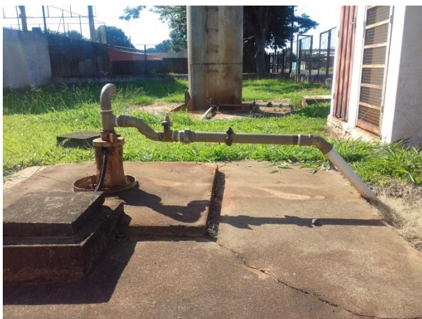
Foto 3.9 – Identificação do Poço: P08
