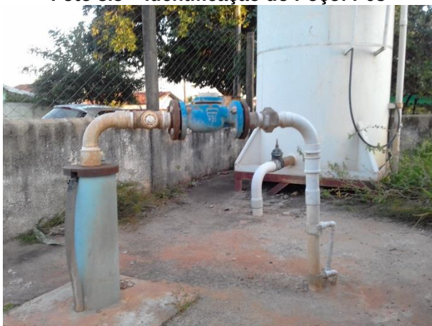
Foto 3.7 – Identificação do Poço: P05
