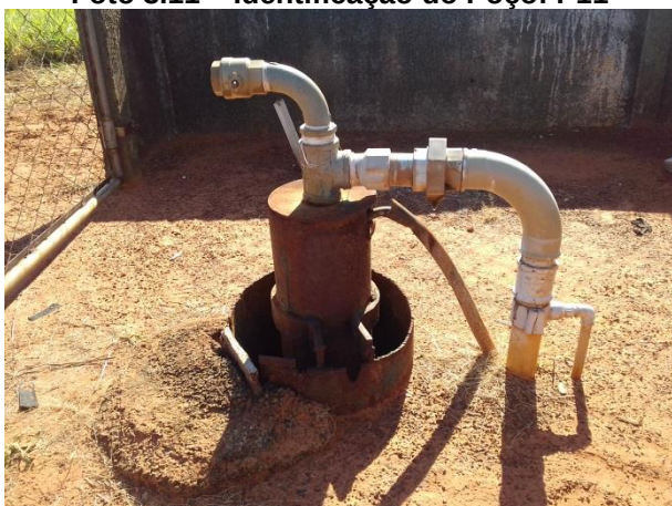
Foto 3.13 – Identificação do Poço: P13
