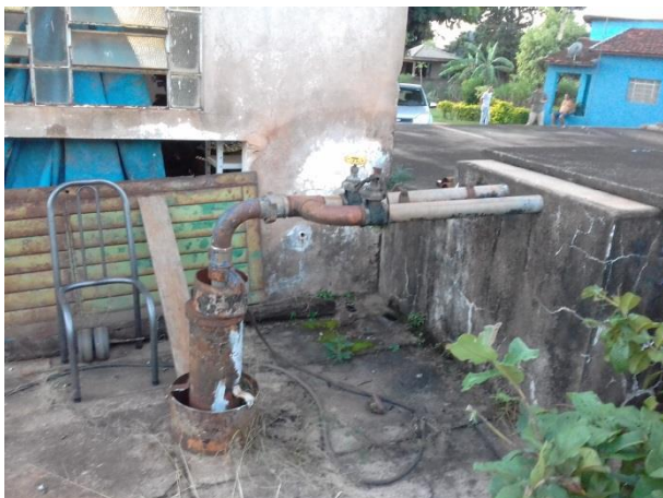
Foto 3.3 – Identificação do Poço: P01
