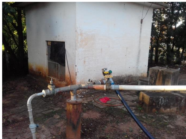
Foto 3.4 – Identificação do Poço: P02
