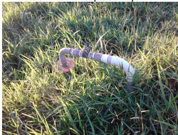
Foto 3.6 – Identificação do Poço: P04
