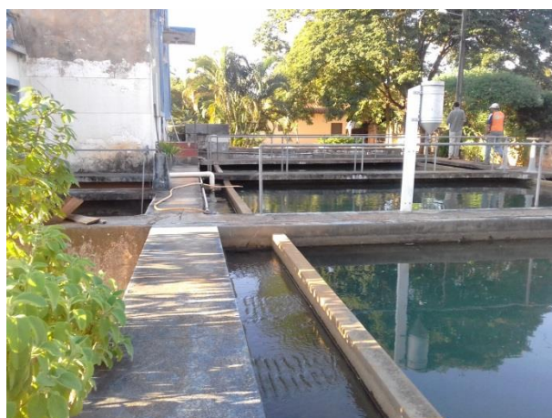
Foto 3.19 – Tanques de decantação
