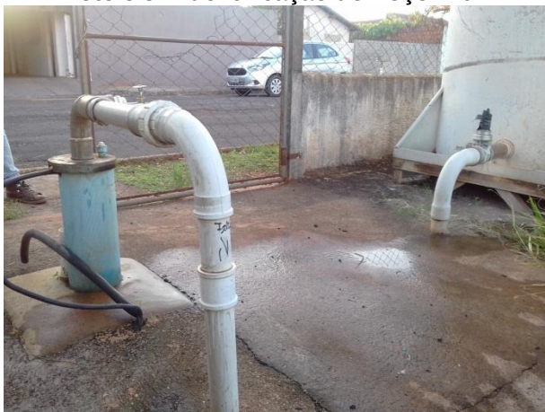
Foto 3.5 – Identificação do Poço: P03
