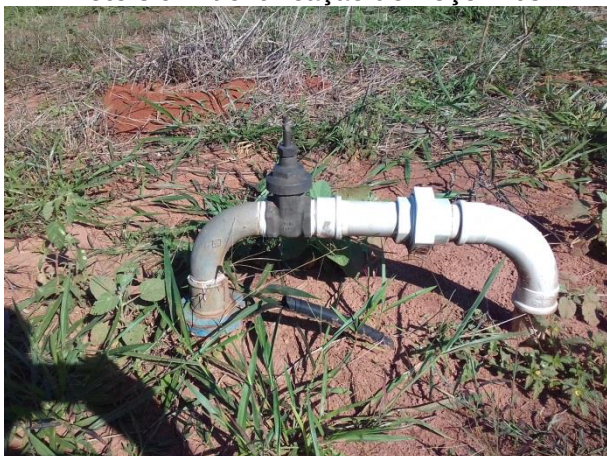
Foto 3.11 – Identificação do Poço: P11
