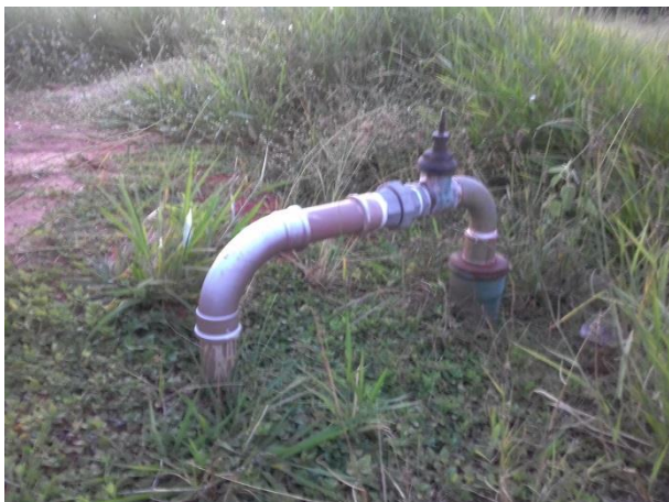
Foto 3.15 – Identificação do Poço: P16
