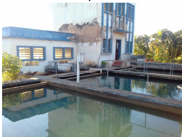
Foto 3.20 – Tanques de decantação
