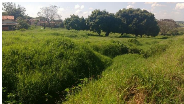
Foto 3.27 – Extensão do processo erosivo – COHAB 3
