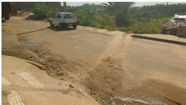
Foto 3.19 – Descarga superficial do sistema de microdrenagem – Rua Domingos Mareco de Souza
