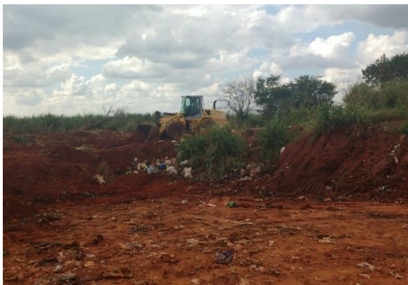
Foto 3.9 – Operação inadequada das valas – Aterro Iubatinga
