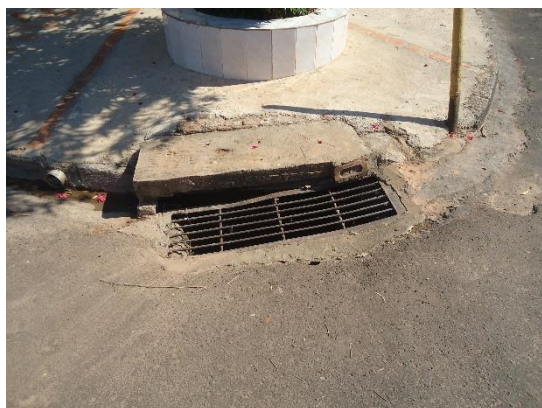
Foto 3.21 – Galeria que contribui para o processo erosivo – Bairro Sol Nascente
