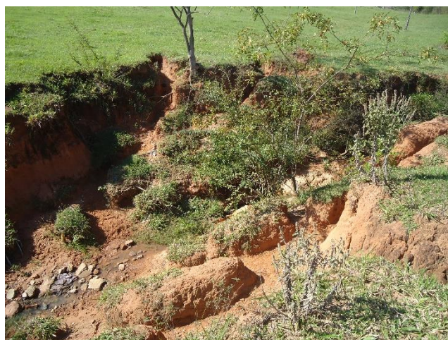
Foto 3.24 – Extensão do processo erosivo – Bairro Sol Nascente
