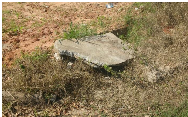
Foto 3.26 – Galeria que contribui para o processo erosivo – COHAB 3
