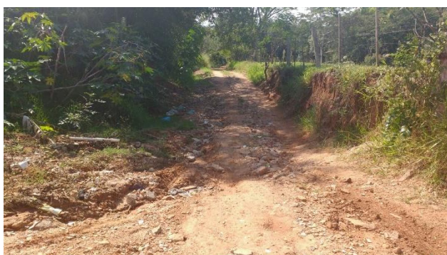
Foto 3.17 – Via sem pavimentação e drenagem – Rua Domingos Mareco de Souza
