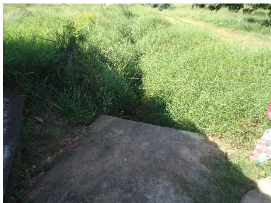
Foto 3.25 – Galeria que contribui para o processo erosivo – COHAB 3
