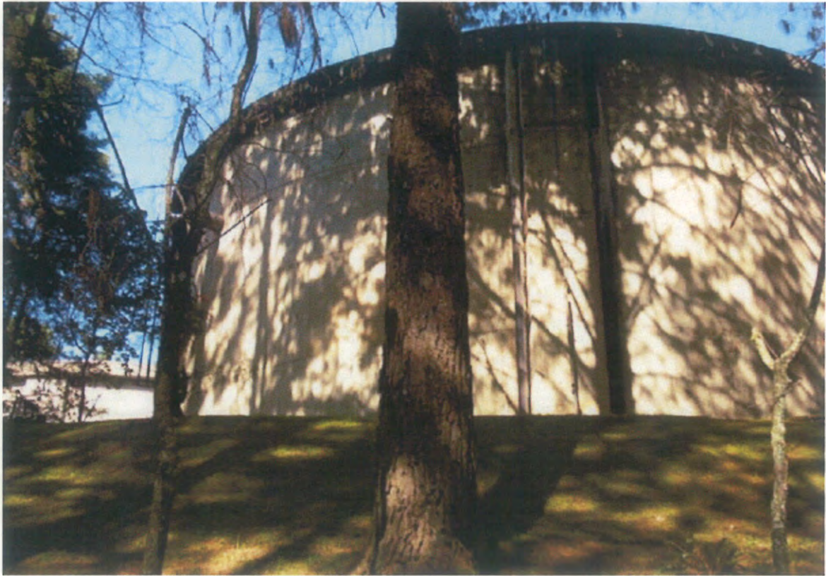
Reservatório 01– Centro de ReservaãoCaieiras
