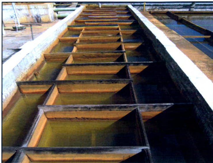
Foto 4 - Vista da estação de tratamento de água - Floculador
