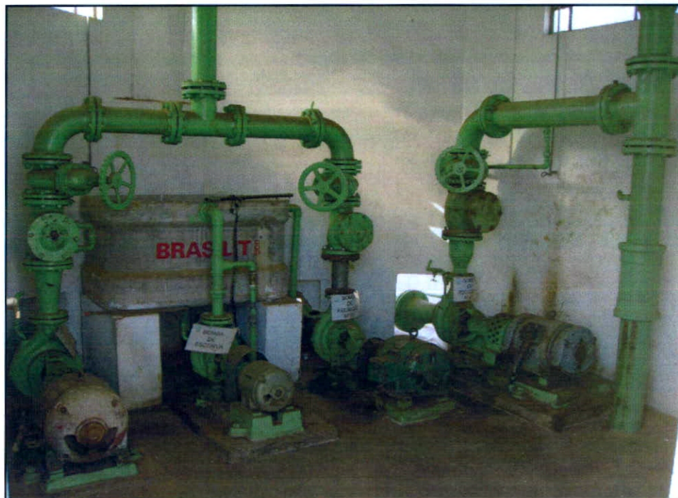
Foto 8 - Sistema de recalque da EEAT01
