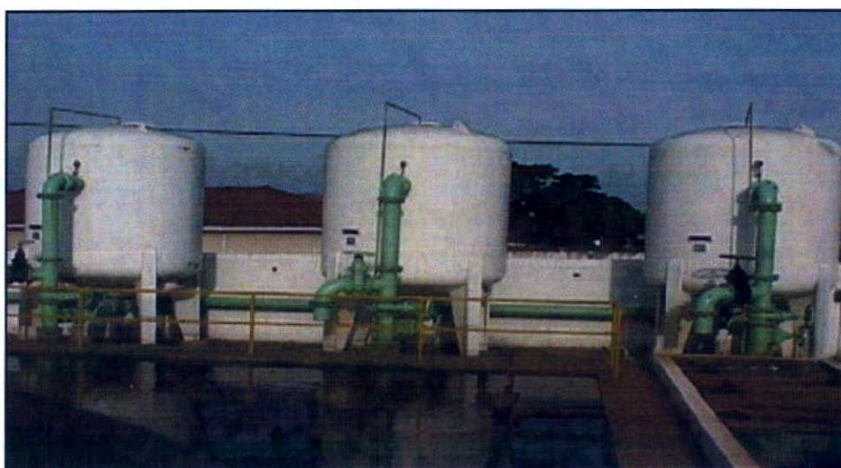
Foto 5 - Vista da estação de tratamento de água - Filtros
