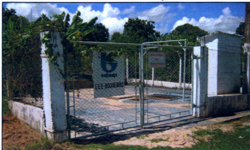
Foto 12 - Vista da EEE Boqueirão
