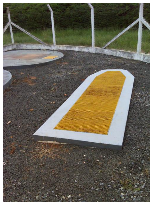
FOTO 4.9 - EEE SEDE IV – CAIXA DE AREIA
