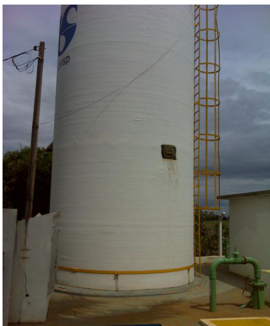
FOTO 4.5 - RESERVATÓRIO R1 (FIBRA) – SALTO DO PARANAPANEMA
