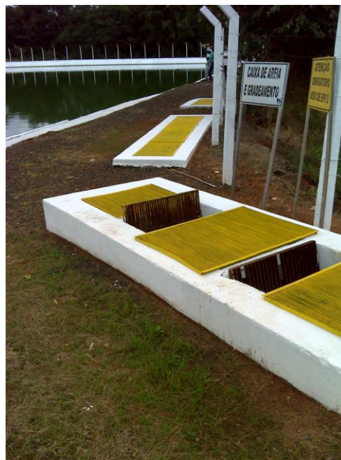
FOTO 4.13 – ETE – CAIXA DE AREIA E GRADEAMENTO
