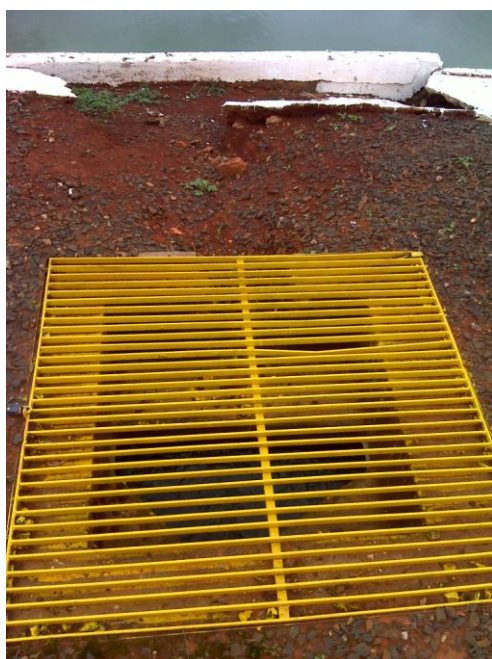
FOTO 4.14 – ETE – CAIXA DE PASSAGEM
