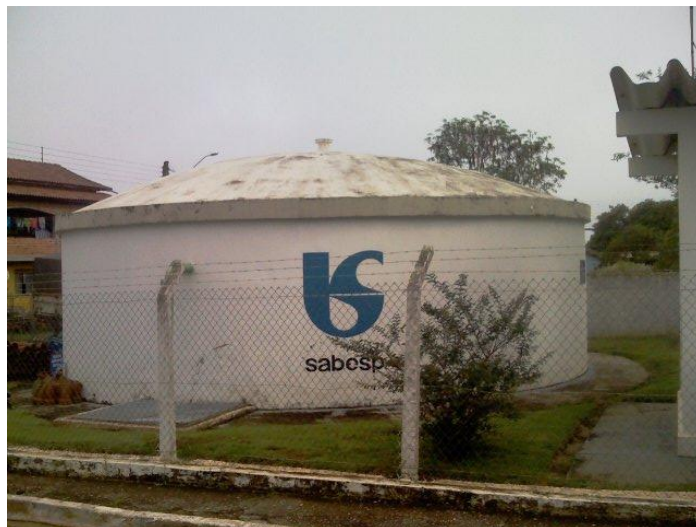
FOTO 4.4 - RESERVATÓRIO R2 - SEDE
