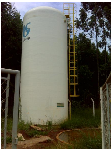
FOTO 4.7 - RESERVATÓRIO R2 - BAIRRO GUAREÍ VELHO - ANGATUBA
