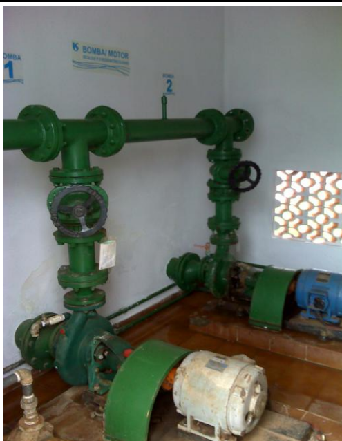
FOTO 4.2 - EEAT – SISTEMA SEDE
