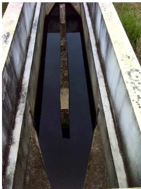
FOTO 4.19 – ETE SALTO DO PARANAPANEMA – CAIXA DE AREIA
