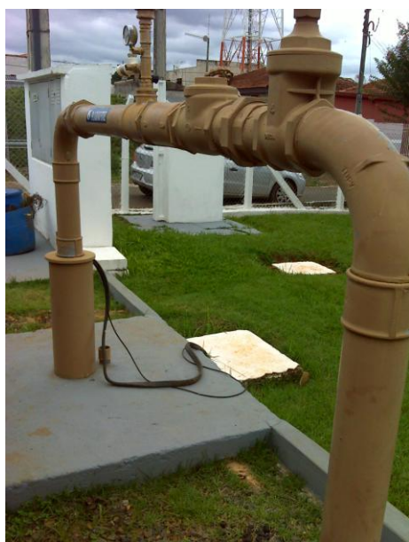
FOTO 4.1 - POÇO PROFUNDO DA SEDE DO MUNICÍPIO DE CAMPINA DO MONTE ALEGRE
