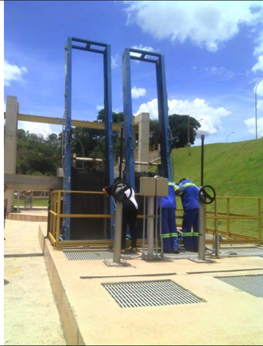
Figura 5.2.1.1. - Gradeamento de retenção de sólidos - ETE, Várzea Paulista/SP.
