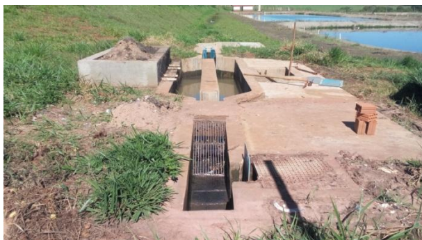
Foto 3.15 – Entrada de ETE – Gradeamento e caixa de areia
