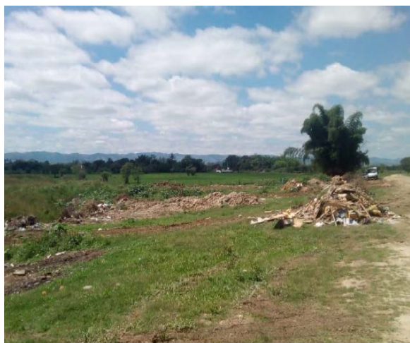
Figura 74. Resíduos sólidos da construção civil dispostos em "Bota-Fora"
