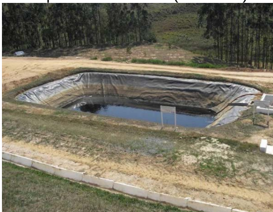
Figura 56. Tanque Reservatório de Líquidos Percolados (Chorume)
