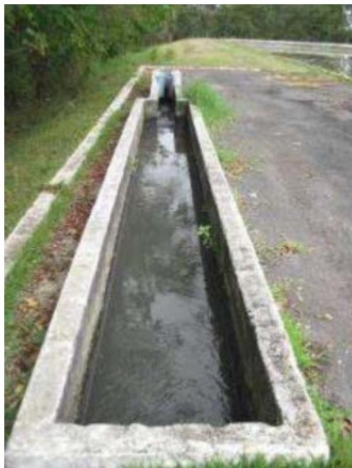
Figura 27. Entrada de Esgoto na Lagoa Facultativa
