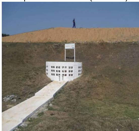
Figura 55. Poço de Captação de Líquidos Percolados (Chorume)
