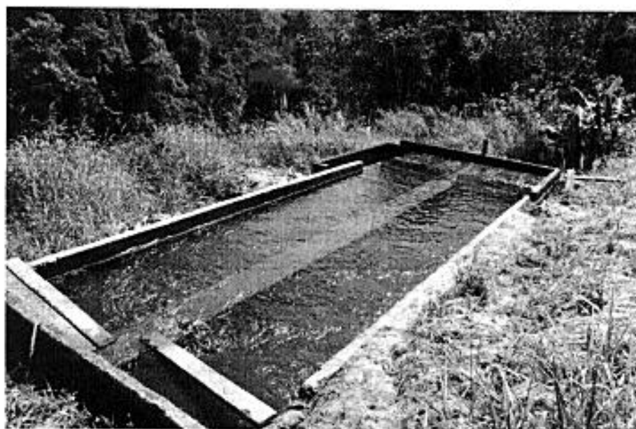
Foto 01 – Captação Alto Rio Claro (Fonte: SABESP)
