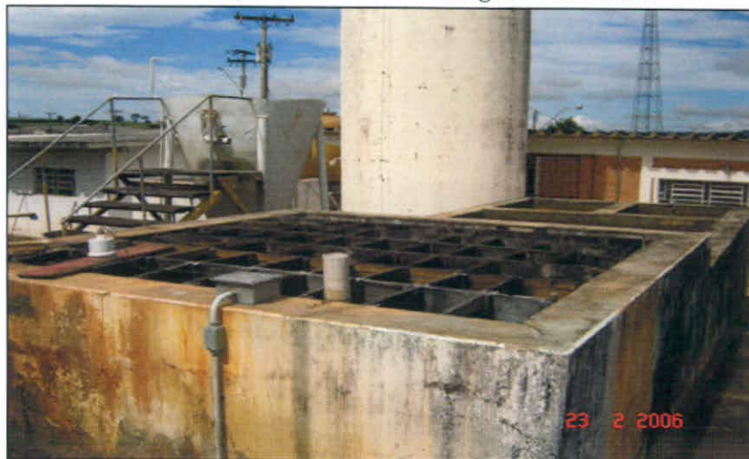
Foto 4- Estação de Tratamento de Água - Vista Geral
