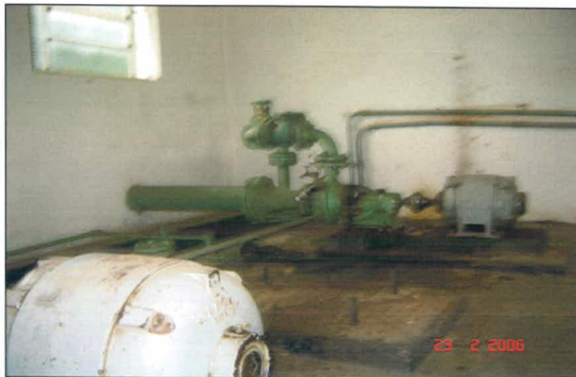
Foto 3 - Estação elevatória EEAB02 - Detalhe do conjuntos moto bombas
