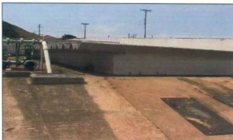
Foto 7 - Reservatório semi enterrado 150 m³ RS01
