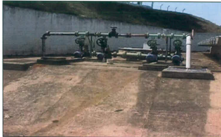
Foto 9- Elevatória de água EEAT02 e EEAT03- Recalque do RS01 para os reservatórios T01 e RA01
