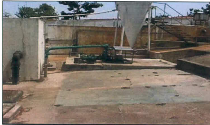
Foto 8- Elevatória de água EEAT01- Recalque da ETA para o reservatório RS01
