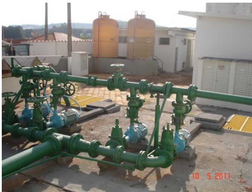
Figura 2.10 – EEAT02 e EEAT03 – Recalque do RS01 para o T01 e RA01.
