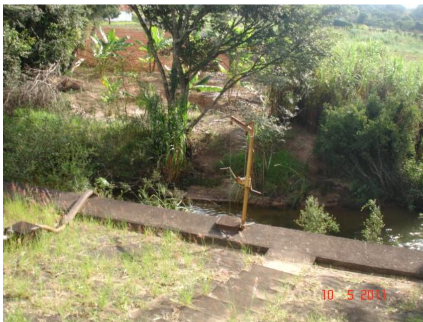
Figura 2.3– Captação de Água Bruta.
