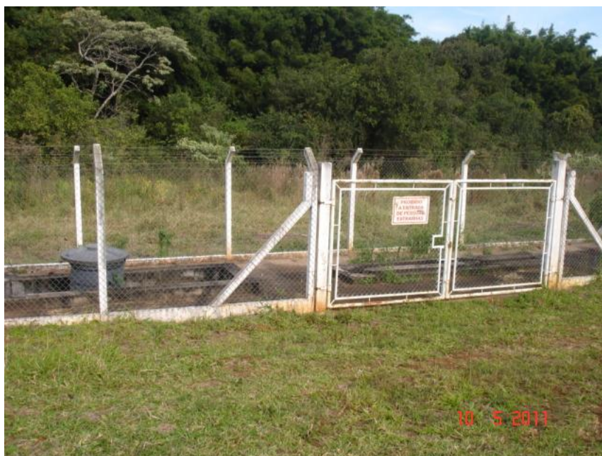
Figura 3.2 – Vista Geral do Sistema de Gradeamento do CDHU.
