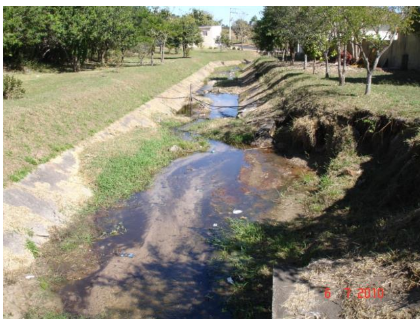
Figura 12.17 – Assoreamento ao longo do Córrego Tamanduá (trecho canalizado).
