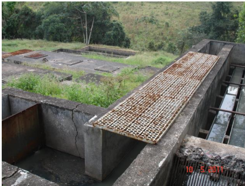
Figura 3.5 – Vista Parcial da ETE.
