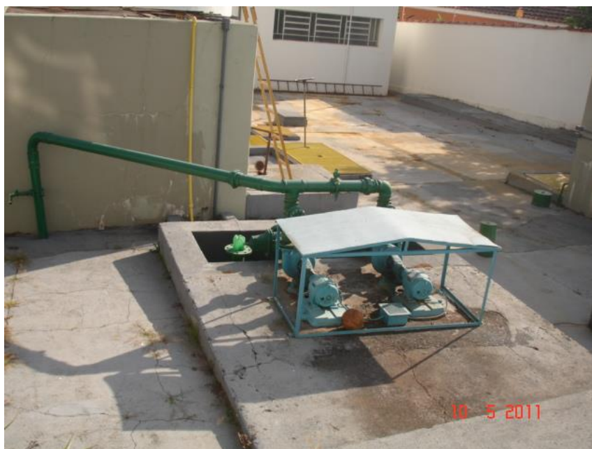
Figura 2.9 – EEAT01 – Recalque da ETA para o RS01.
