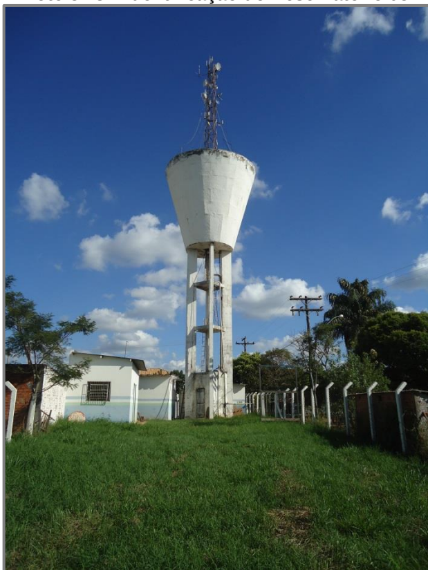
Foto 3.30 – Identificação do Reservatório 05
