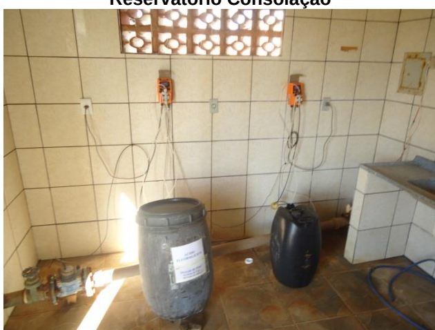
Foto 3.24 – Tratamento da Água Reservatório Planalto II
