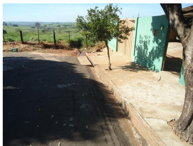
Foto 3.46 – Ponto de alagamento na Rua João Guilherme
