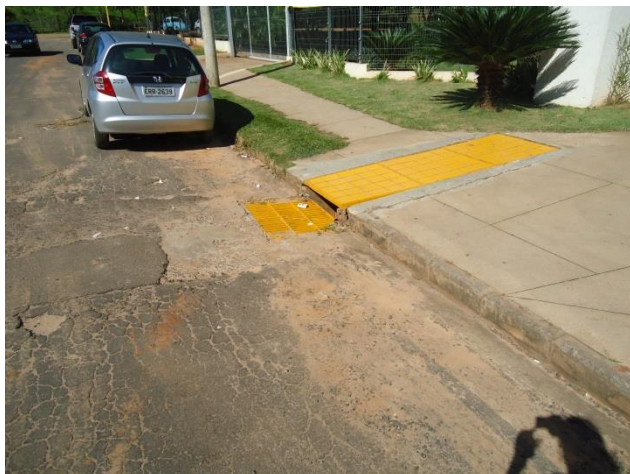
Foto 3.47 – Ponto de alagamento na Rua Rio Grande do Sul
