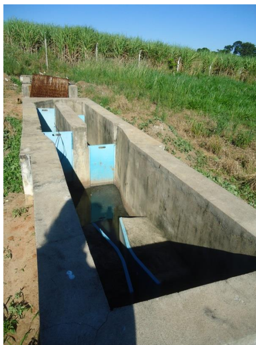
Foto 3.40 – Vista do desarenador ETE Guarani
