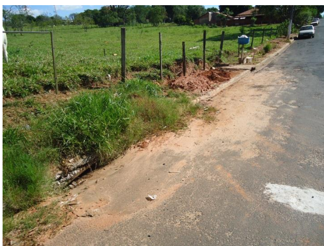
Foto 3.49 – Ponto de alagamento no cruzamento das Ruas Teodora Arias e Espírito Santo
