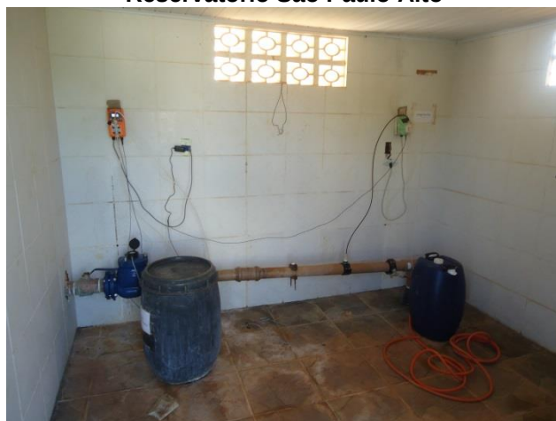
Foto 3.21 – Tratamento da Água Reservatório Vale do Sol
