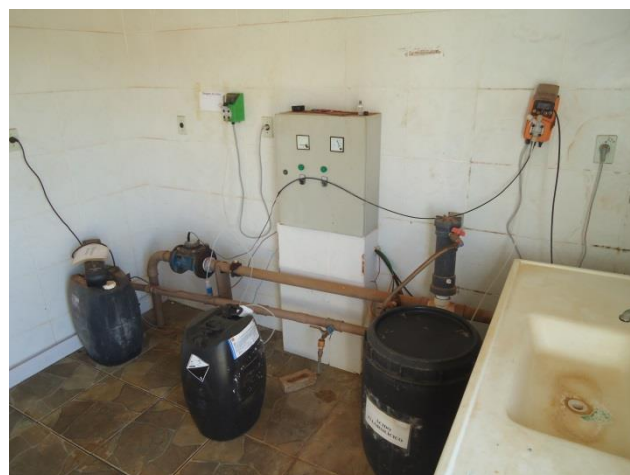
Foto 3.23 – Tratamento da Água Reservatório Lauro Pentead
