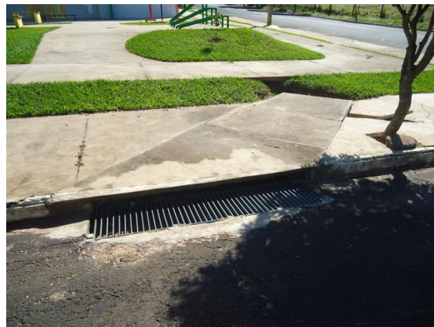
Foto 3.48 – Ponto de alagamento na Praça Academia da Saúde
