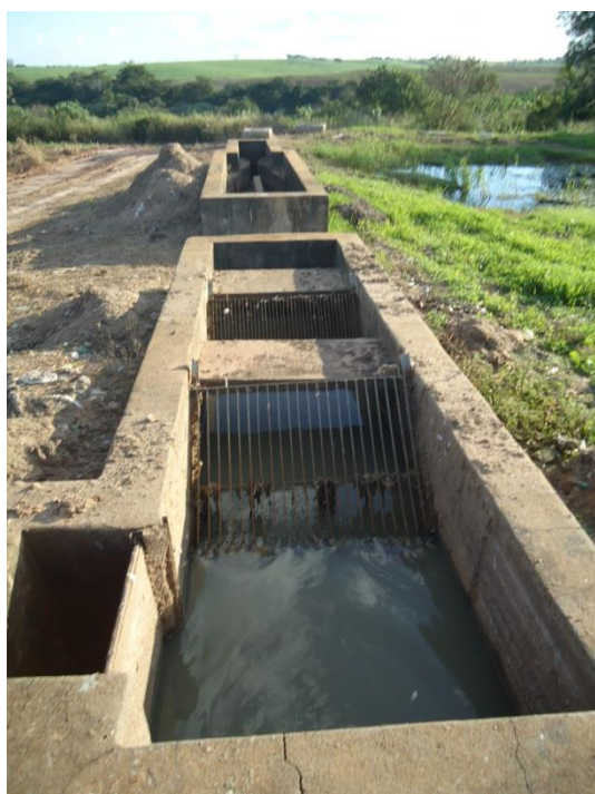
Foto 3.33 – Vista do sistema de gradeamento ETE Clealco
