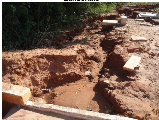
Foto 3.53 – Ponto de erosão no cemitério
