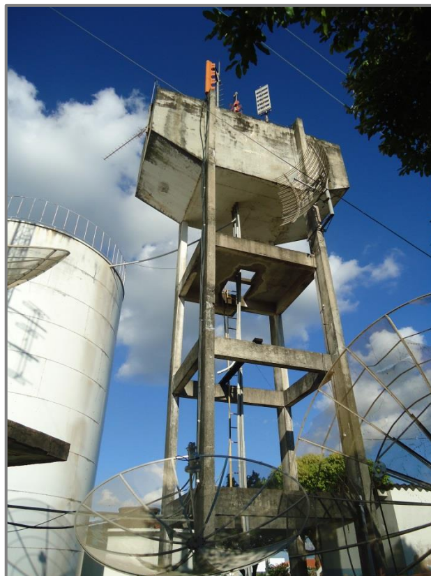
Foto 3.27 – Identificação do Reservatório 02
