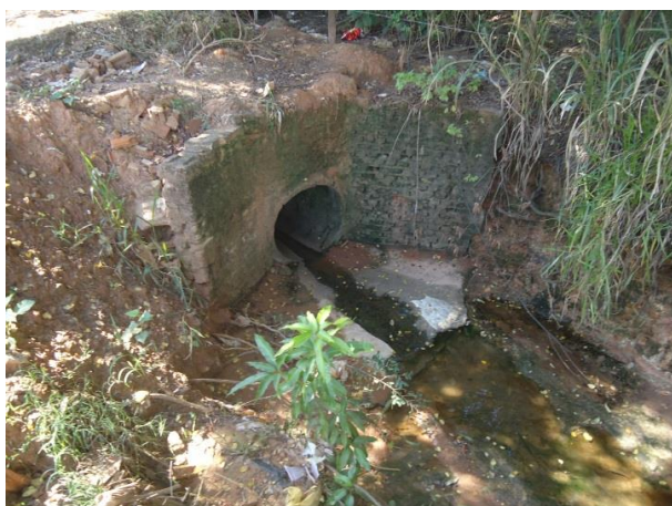
Foto 3.50 – Ponto de erosão na Rua Rio Grande do Sul
