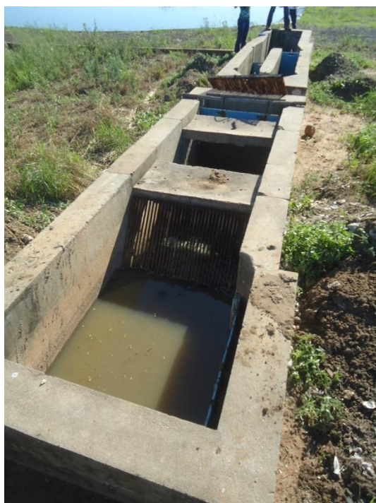
Foto 3.39 – Vista do sistema de gradeamento ETE Guarani
