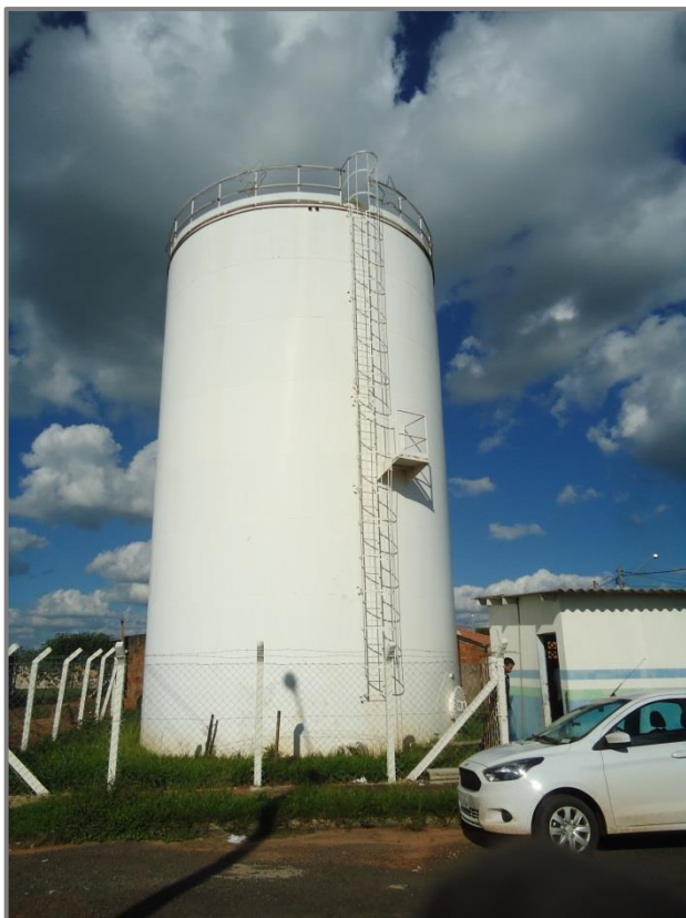
Foto 3.32 – Identificação do Reservatório 07
