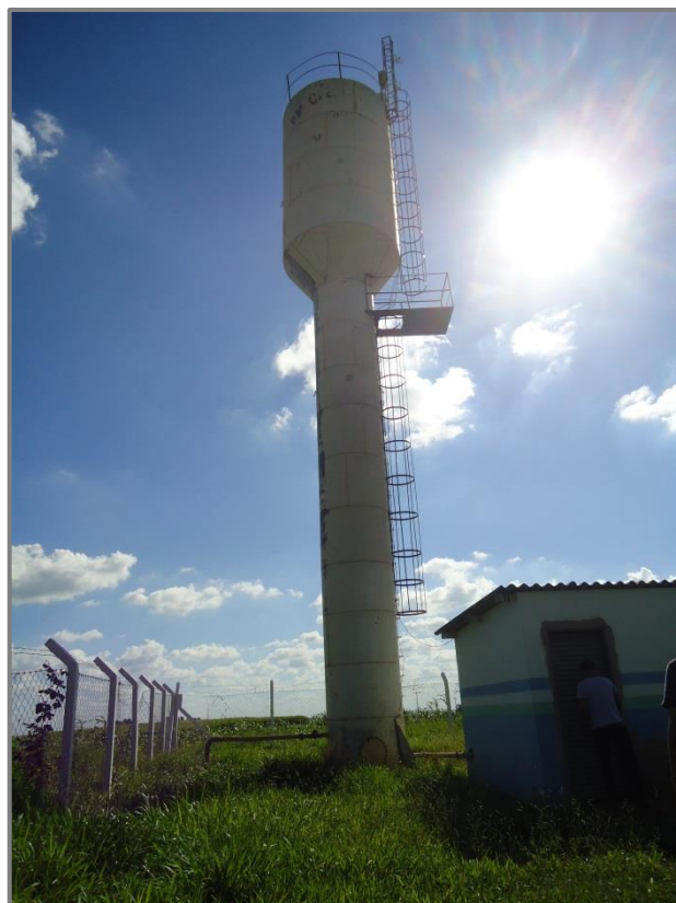
Foto 3.29 – Identificação do Reservatório 04
