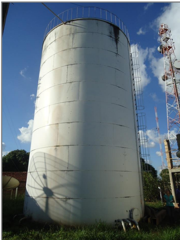
Foto 3.28 – Identificação do Reservatório 03
