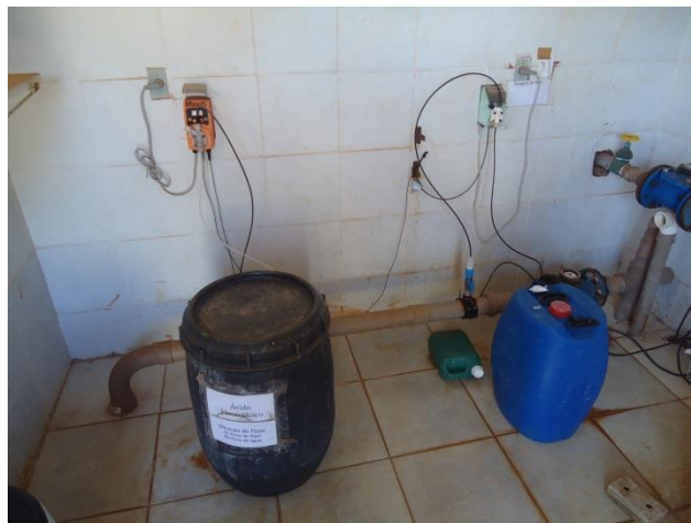
Foto 3.19 – Tratamento da Água Reservatório São Paulo Alto
