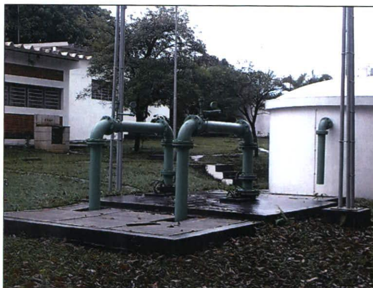
Foto 16 - Estação elevatória de água tratada EEAT01 - Colômbia
