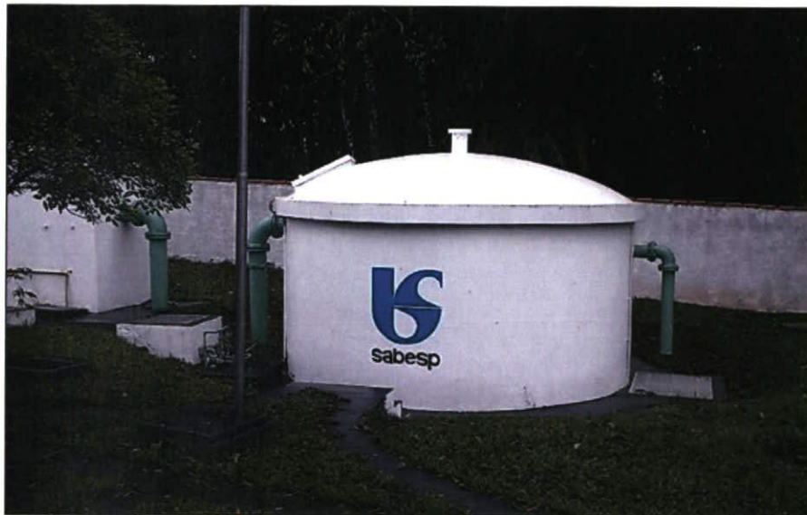
Foto 12 - Reservatório apoiado RA01 - Colômbia
