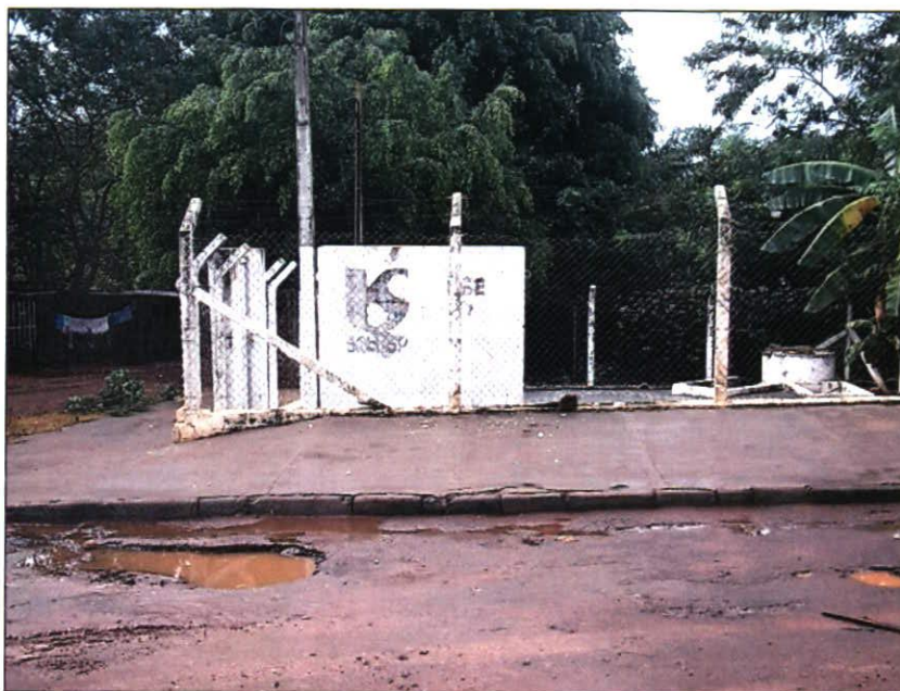
Foto 20 - Estação elevatória EEE 01
