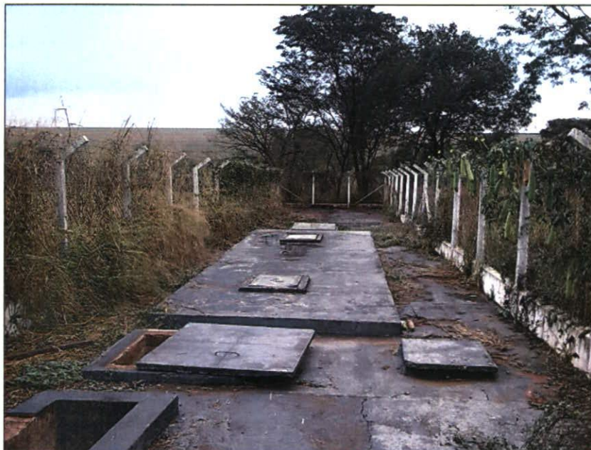
Foto 23 - Fossa Filtro - Laranjeiras
