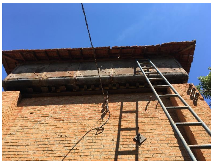
Foto 6.4 – Reservatório do SETOR 02- Estação em estado precário
