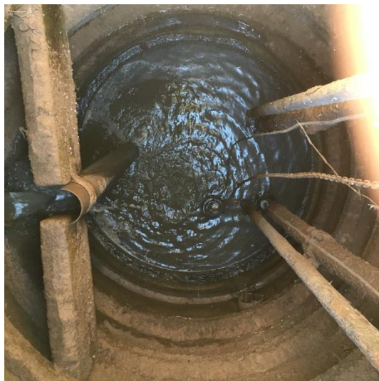
Foto 3.34 – Vista do poço de sucção EEEB Belim
