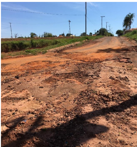
Foto 3.70 – Erosão Rua José Sanches Parra
