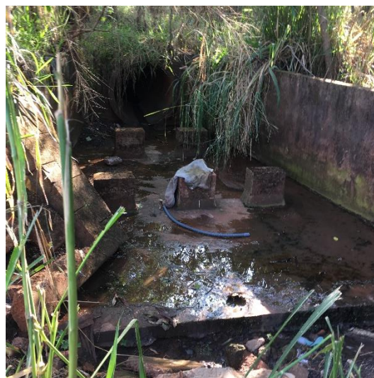
Foto 3.68 – Dissipador de energia
