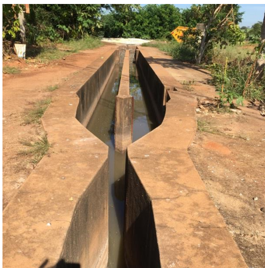
Foto 3.36 – Vista geral do tratamento preliminar ETE Cosmorama
