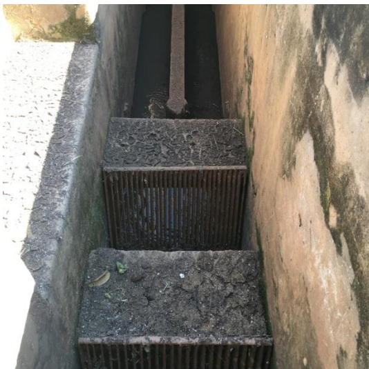
Foto 3.33 – Vista do tratamento preliminar EEEB Belim
