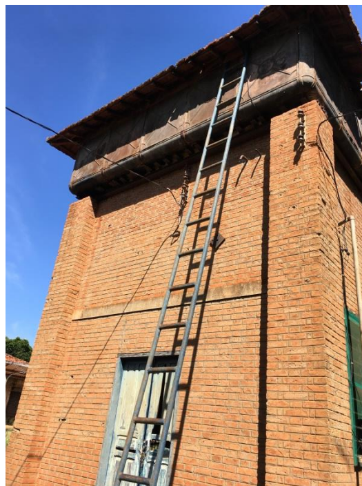
Foto 3.19 - Identificação do Reservatório: REL 04
