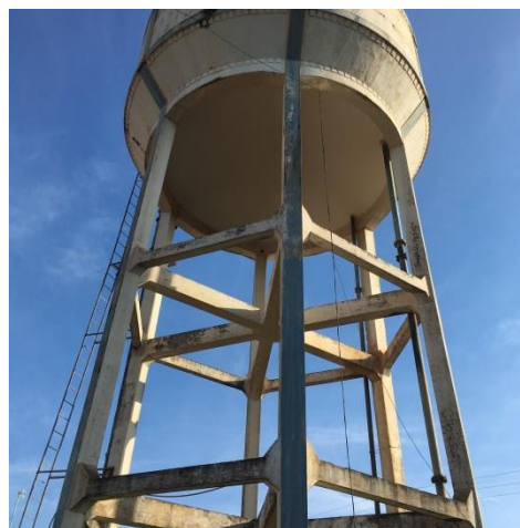
Foto 3.17 - Identificação do Reservatório: REL 02
