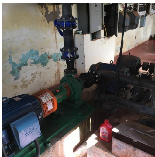
Foto 3.14 - Conjunto motor-bombas da EEAT 01
