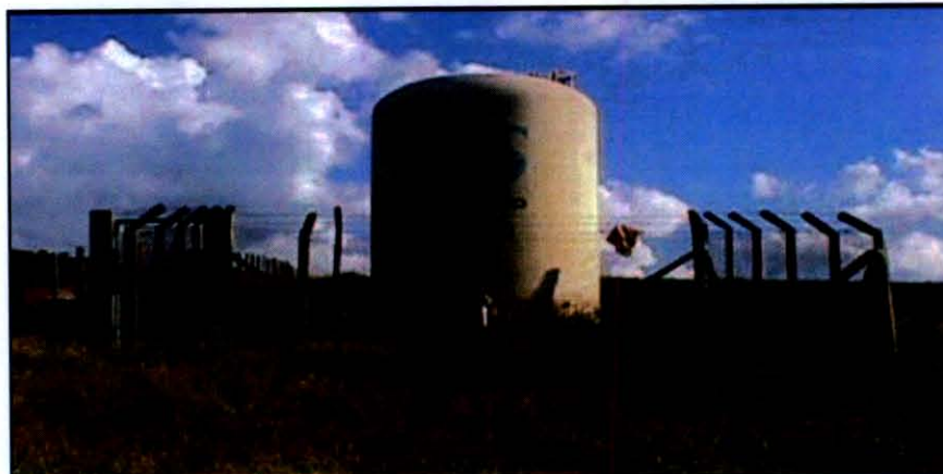
Foto 10 - Reservatório apoiado 04 (RA04) - Três Barras
