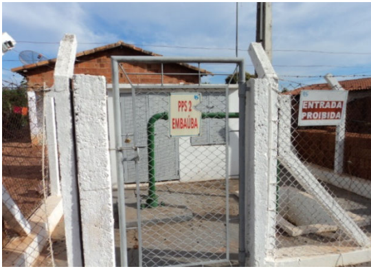
Poço 2 – 13 m 3 l/h vazão
