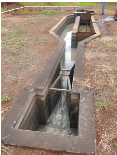
Foto 4.11 - Calha Parshall – Entrada ETE
