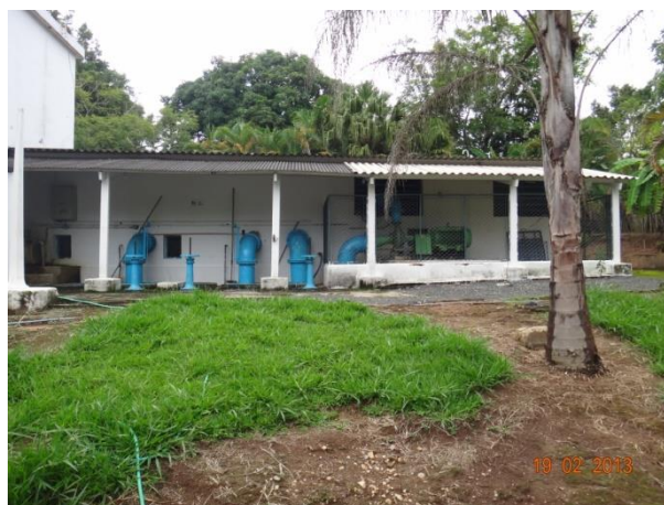
Foto 4.2 – EEAB01 - Casa de Bombas
