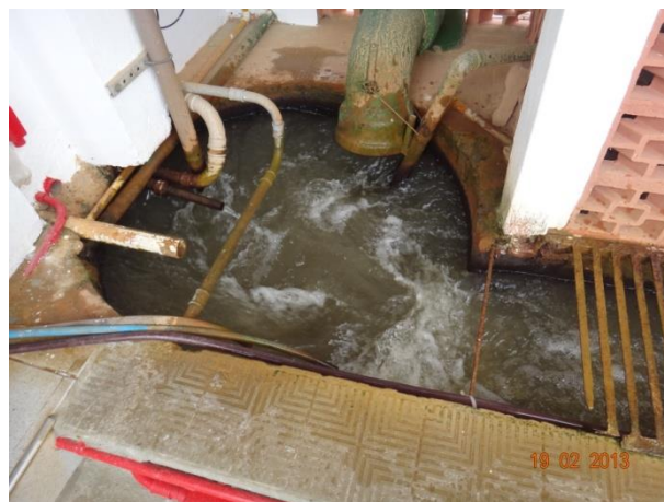
Foto 4.4 – Chegada da Água Bruta
