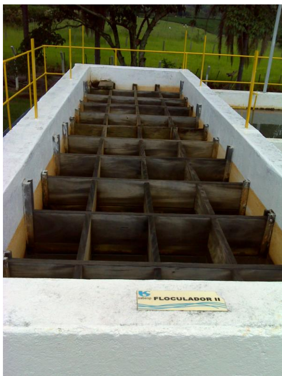
FOTO 4.4 - ESTAÇÃO DE TRATAMENTO DE ÁGUA (ETA) - FLOCULADORES
