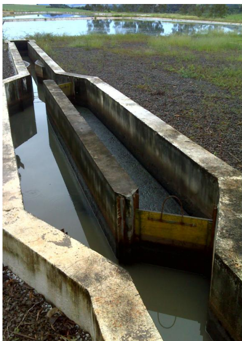
FOTO 4.24 - ESTAÇÃO DE TRATAMENTO DE ESGOTOS (ETE) – CAIXA DE AREIA
