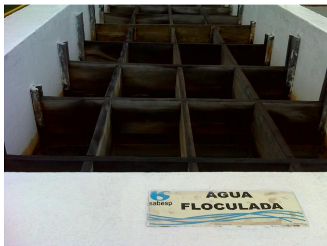
FOTO 4.5 - ESTAÇÃO DE TRATAMENTO DE ÁGUA (ETA) - FLOCULADORES
