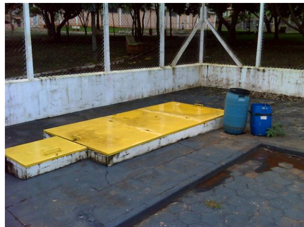
FOTO 4.21 - EEE – PQ DAS FLORES – CAIXA DE AREIA
