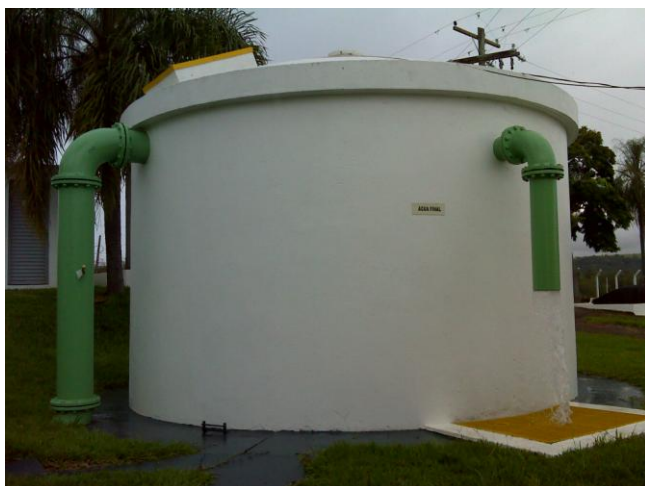
FOTO 4.9 - RESERVATÓRIO R4 – ETA
