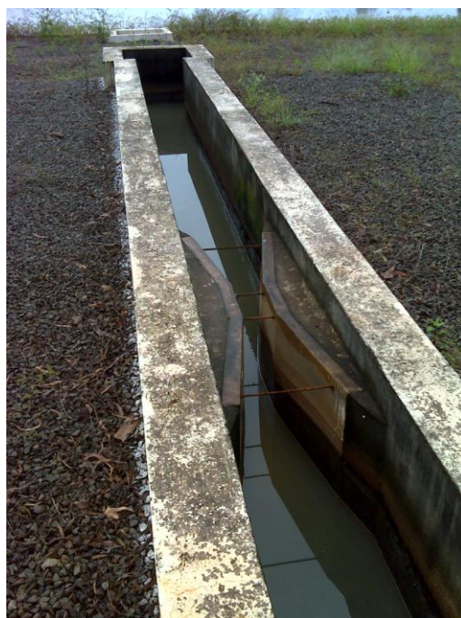
FOTO 4.25 - ETE – CALHA PARSHALL
