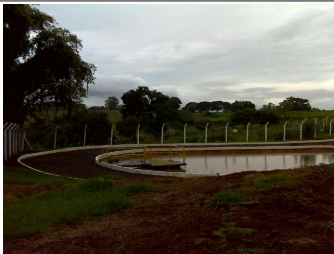
FOTO 4.8 - ESTAÇÃO DE TRATAMENTO DE ÁGUA (ETA) - LAGOA DE RETENÇÃO DAS ÁGUAS DE LAVAGEM DA ETA
