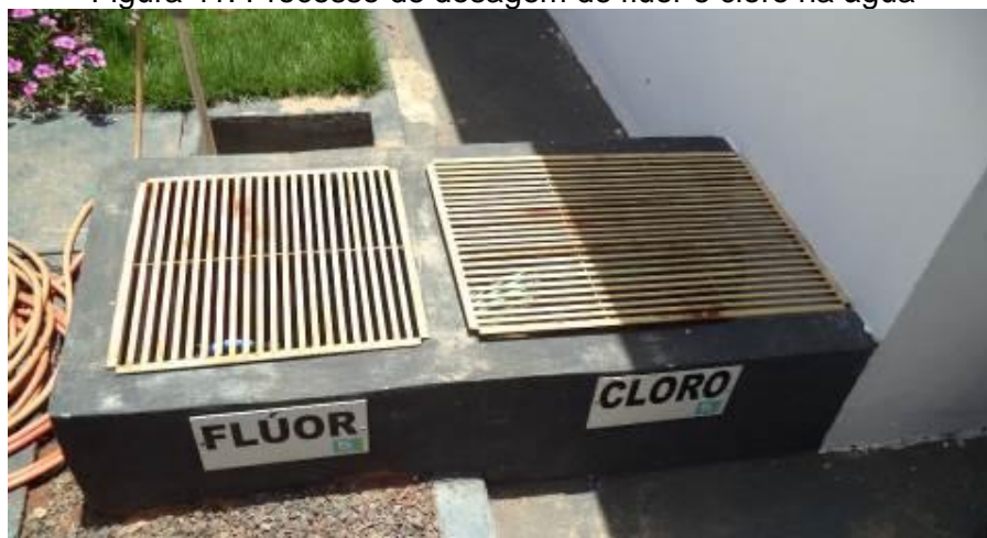
Figura 41. Processo de dosagem de flúor e cloro na água
