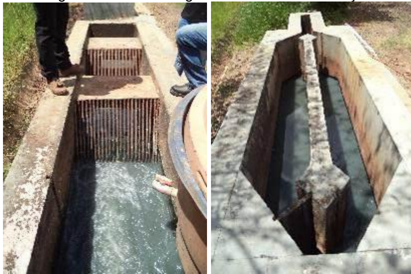
Figura 48. Caixas de gradeamento e desarenação
