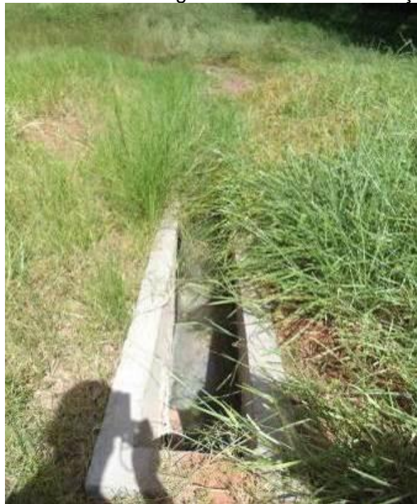
Figura 50. Escada de aeração
