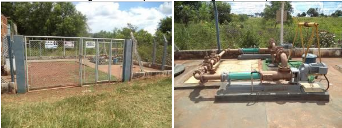
Figura 54. Estação elevatória esgoto (EEE - 2)
