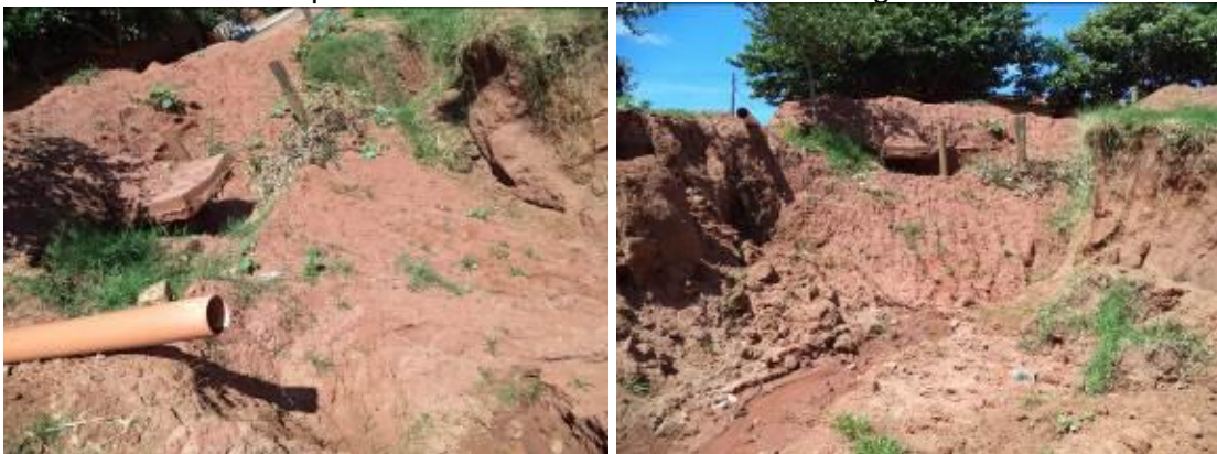
Figura 65. Erosão dentro de propriedade particular provocada por águas de chuva proveniente da Rua Fioravante Segati
