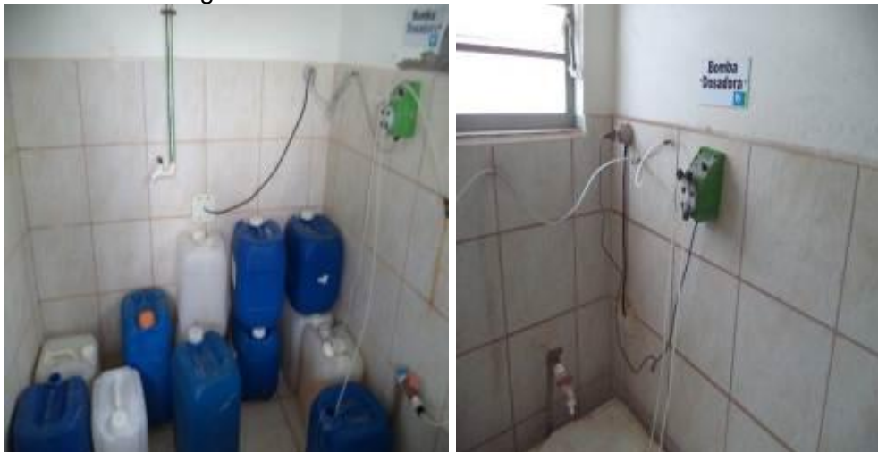
Figura 40. Bombas dosadoras de cloro e flúor
