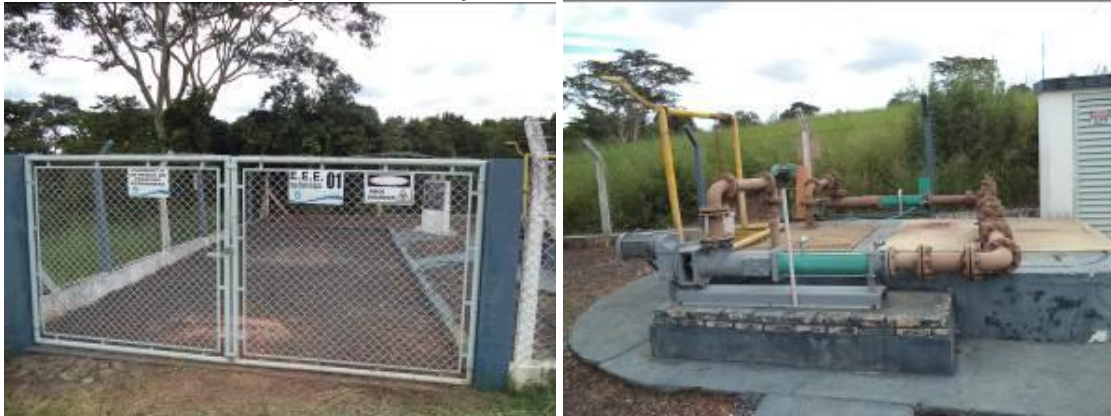
Figura 53. Estação elevatória esgoto (EEE - 1)
