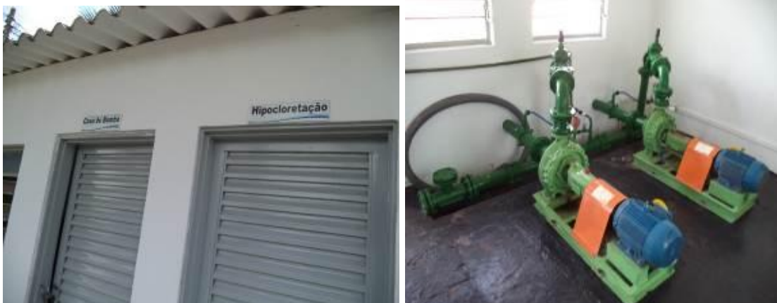
Figura 38. Casa de bombas, casa de hipocloreção e bombas elevatórias, respectivamente
