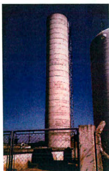
Foto 37 - Centro de reservação Jardim das Paineiras - RP1 - 70 m³
