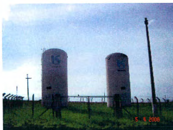
Foto 27 - Reservatório apoiado Restinga: 2 x 100 m 3
