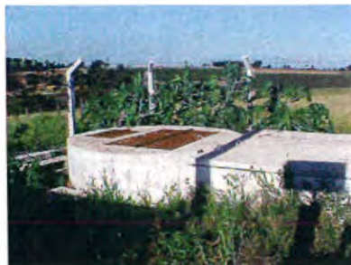
EEE Aeroporto - Poço
