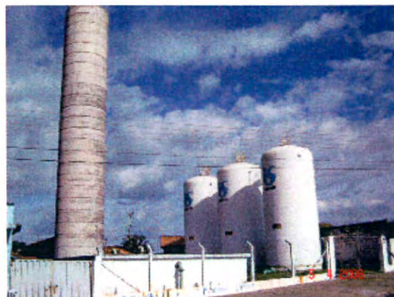
Foto 38 - Centro de reservação Jardim das Paineiras - RP3 - 3 x 100 m³
