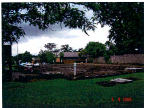
Foto 23 - Centro de reservação na ETA - R3
