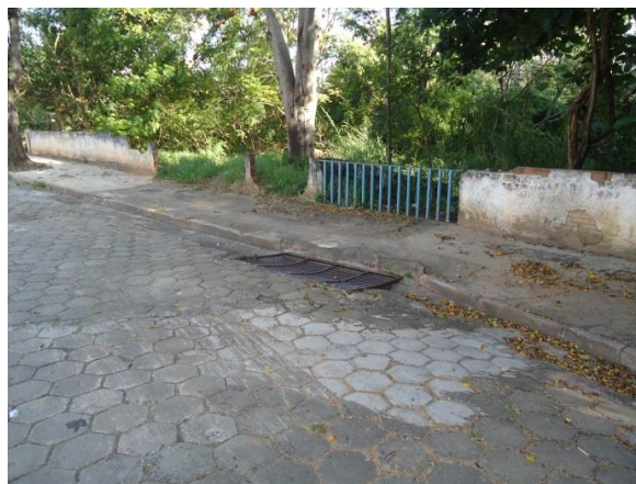
Foto 3.30 – Estrutura de Microdrenagem insuficiente
