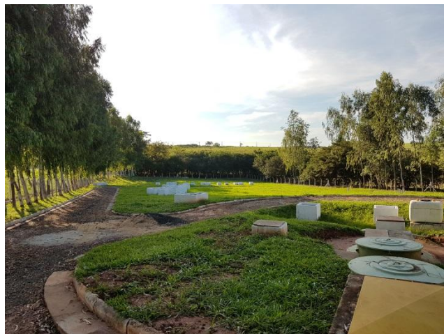
Foto 3.22 – Vista geral – Reatores
