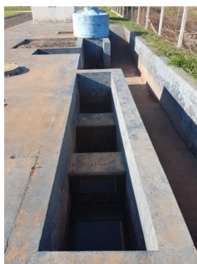
Foto 3.19 – Tratamento Preliminar – Entrada ETE
