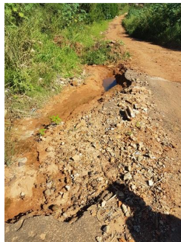
Foto 3.36 – Erosão provocada pelo escoamento superficial
