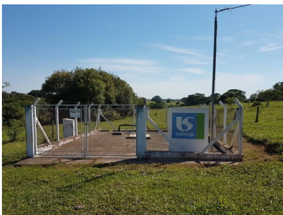
Foto 3.3 - Identificação do Poço: Poço-14
