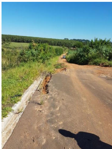
Foto 3.35 – Erosão provocada pelo escoamento superficial
