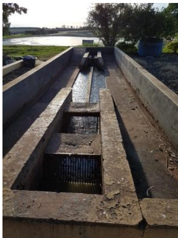
Foto 3.17 – Tratamento Preliminar – Entrada ETE
