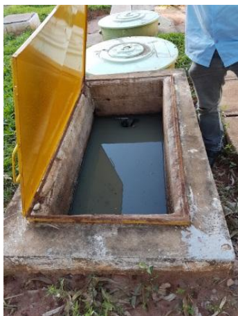
Foto 3.21 – Tratamento Preliminar – Entrada ETE
