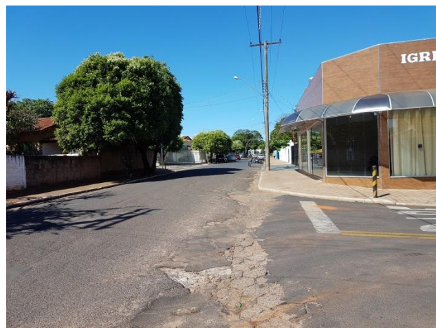
Foto 3.32 – Área de alagamento Av. Jose Candido da Silva
