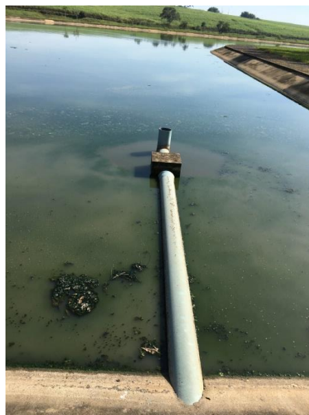
Foto 6.5 – Nível de água tubulação de distribuição afluyente- lado esquerdo da lagoa facultativa
