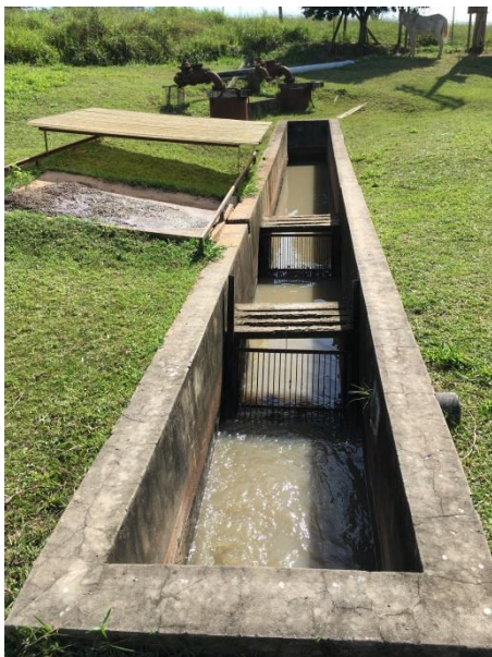
Foto 3.27 – Vista do tratamento preliminar
