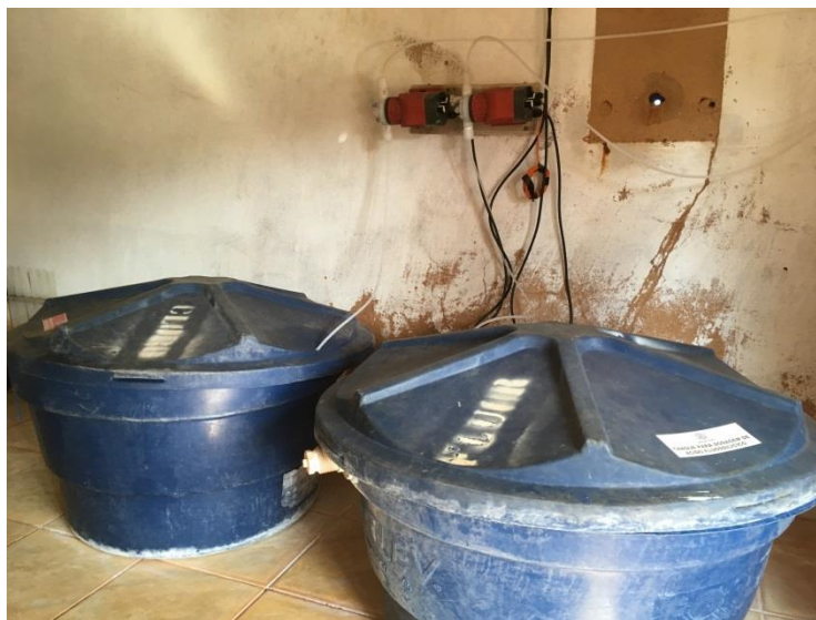
Foto 3.14 – Unidades de Fluoretação e Cloração com bomba dosadora
