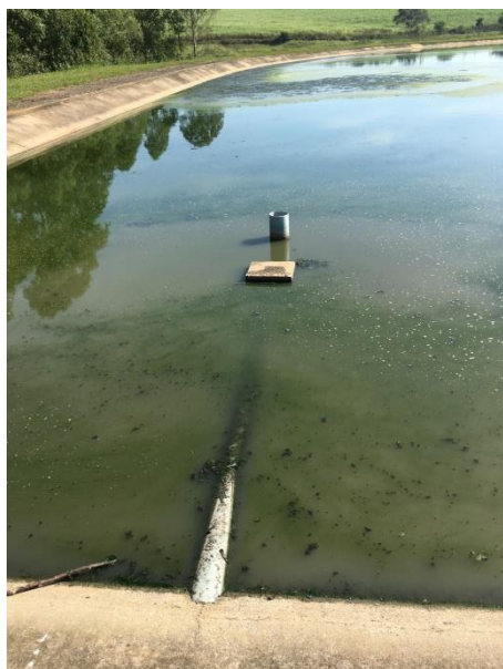
Foto 6.4 – Nível de água tubulação de distribuição afluyente- lado direito da lagoa facultativa
