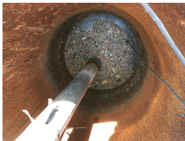
Foto 3.26 – Vista do poço de sucção
