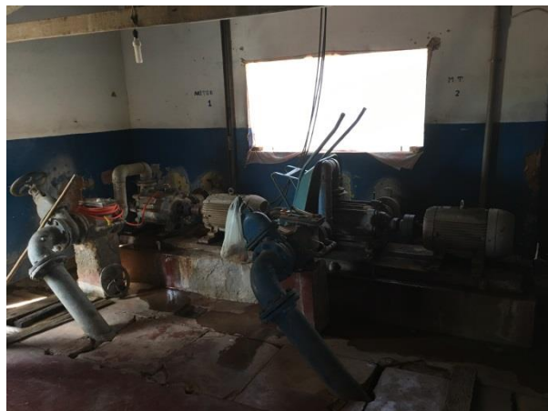
Foto 3.13 – Vista dos conjuntos motor-bombas
