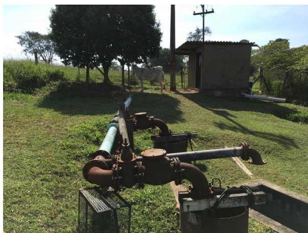
Foto 3.29– Vista da tubulação de recalque
