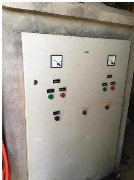
Foto 3.28 – Vista do painel elétrico das bombas
