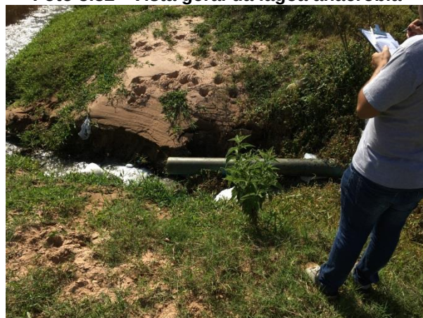
Foto 3.34 – Vista do lançamento do efluente tratado no corpo receptor
