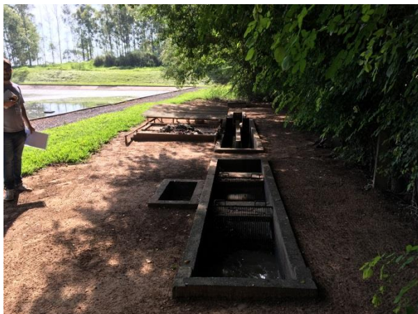
Foto 3.31 – Vista geral do tratamento preliminar
