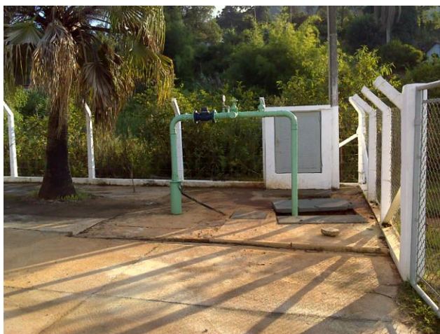
FOTO 4.10 – POÇO PROFUNDO BAIRRO DOS ELIAS
