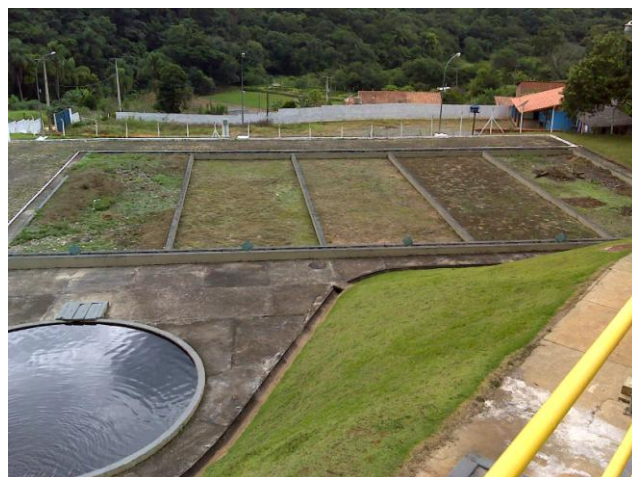
FOTO 4.21 – ETE SEDE – TANQUE DE REUSO DE ÁGUA E TANQUES DE SECAGEM DO LODO
