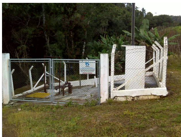
FOTO 4.12 – EEAB BAIRRO FAZENDINHA
