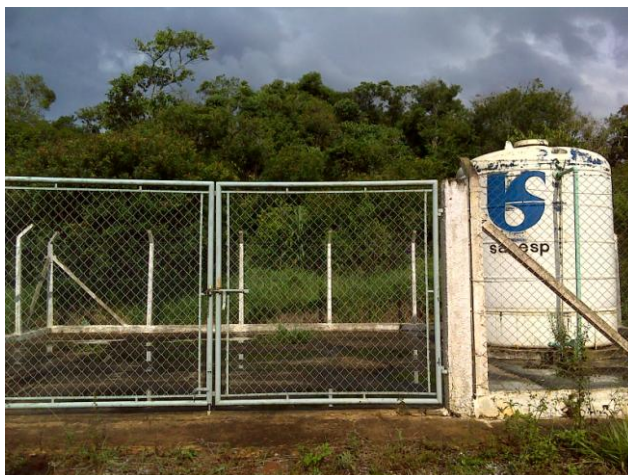
FOTO 4.7 - RESERVATÓRIO BAIRRO PINHEIROS
