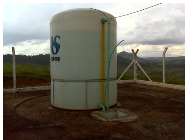
FOTO 4.6 - RESERVATÓRIO BAIRRO CLAUDINOS
