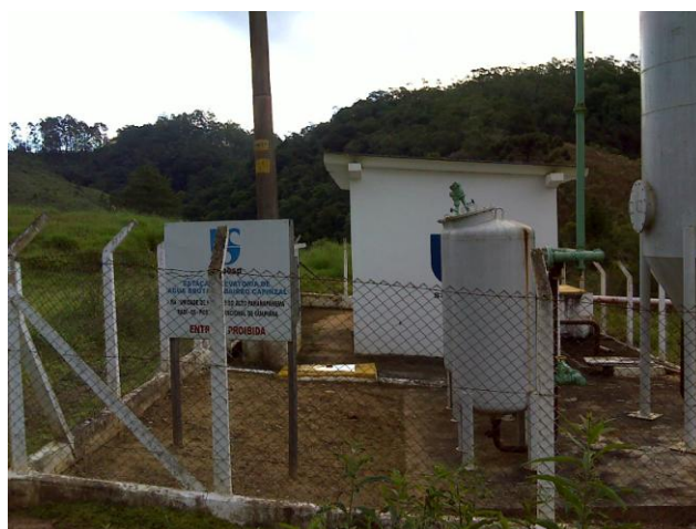
FOTO 4.8 – ETA BAIRRO CAPINZAL E FILTROS
