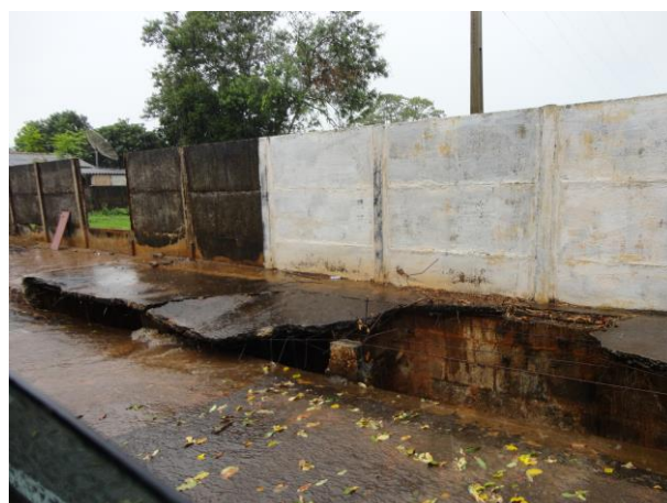
Foto 3.11 – Muro e sistema de microdrenagem danificados por conta dos alagamentos na área
