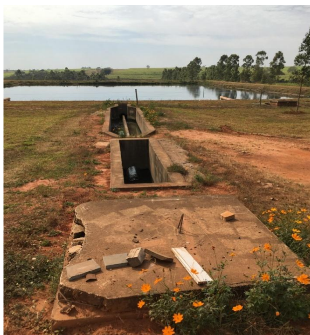
Foto 3.60 – Vista da caixa de chegada, gradeamento e caixa de areia que antecedem as lagoas da ETE Frutal
