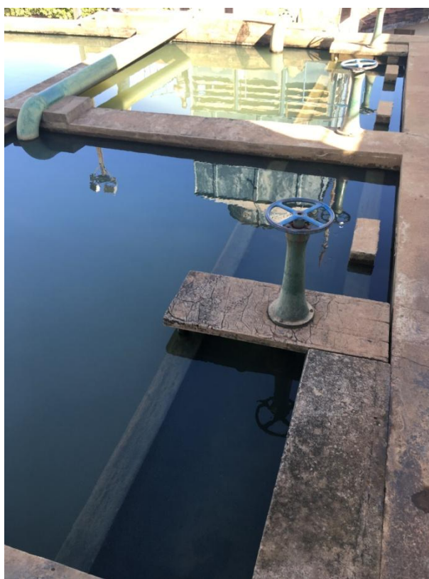
Foto 3.19 – Vista dos filtros 2 e 3
