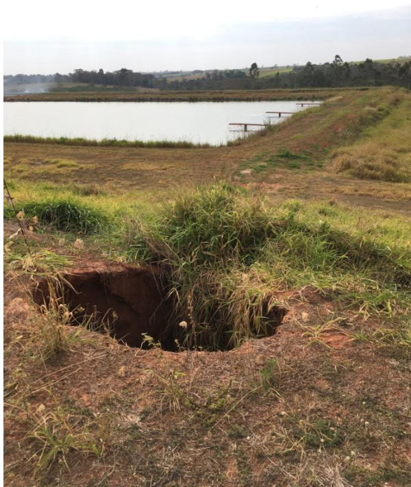
Foto 3.67– Vista da erosão causada pelo vazamento de esgotos da tubulação que interliga uma lagoa à outra
