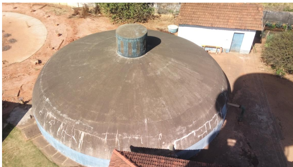
Foto 3.31 – Vista do Reservatório Semi-enterrado de 750m 3 localizado na área da ETA
