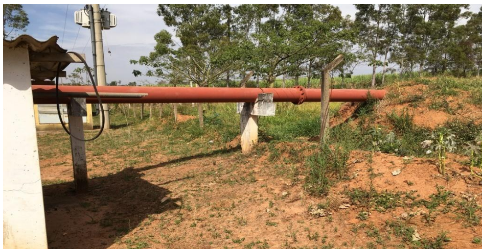
Foto 3.58 – Vista da linha de recalque da EEE Final
