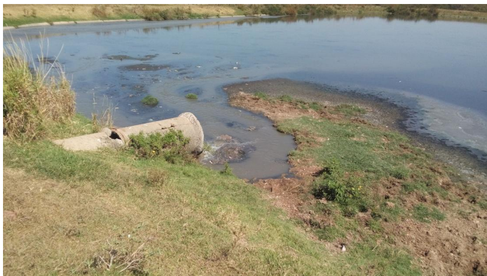
Foto 3.72 – Vista do assoreamento da lagoa anaeróbia
