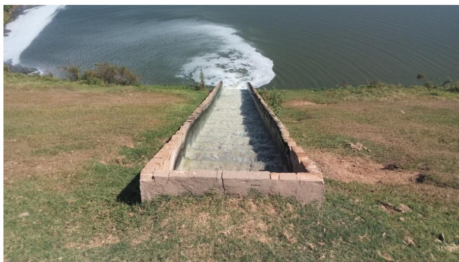
Foto 3.75 – Detalhe da escada hidráulica de entrada da primeira lagoa facultativa (Aeração)
