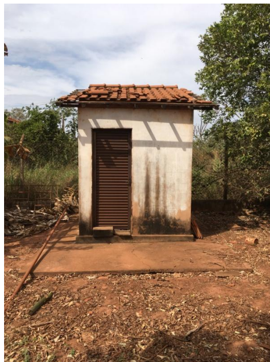
Foto 3.48 – Abrigo dos dosadores de cloro e flúor do Distrito de Ribeiro do Vale
