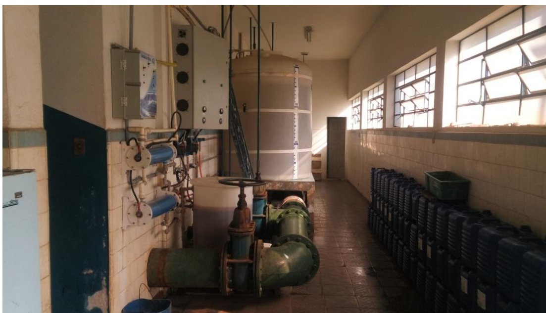
Foto 3.21 – Detalhe das saídas dos filtros
