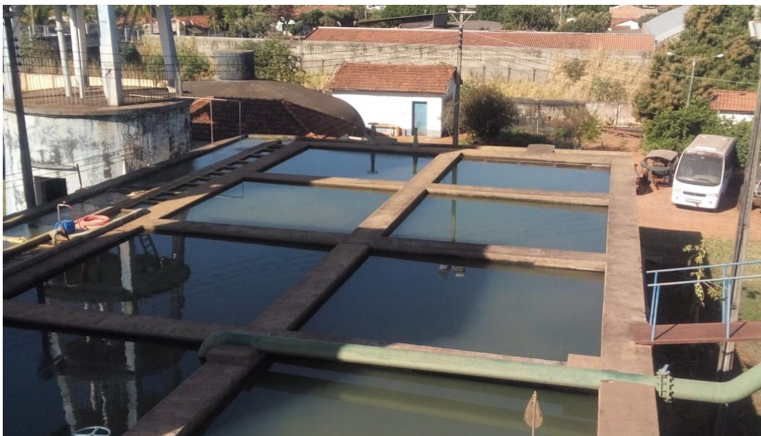
Foto 3.18 – Vista dos decantadores
