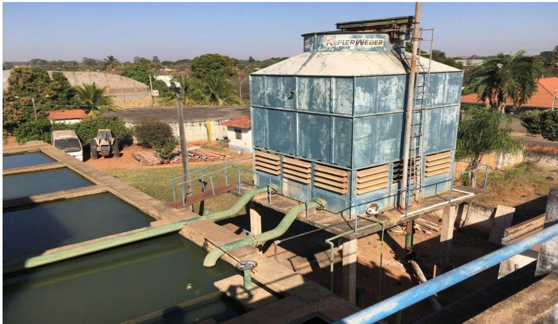
Foto 3.25 – Vista do resfriador de água, desativado, localizado na ETA
