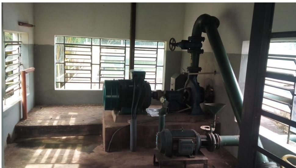
Foto 3.13 – Detalhe das bombas da sala 01 da EEAB
