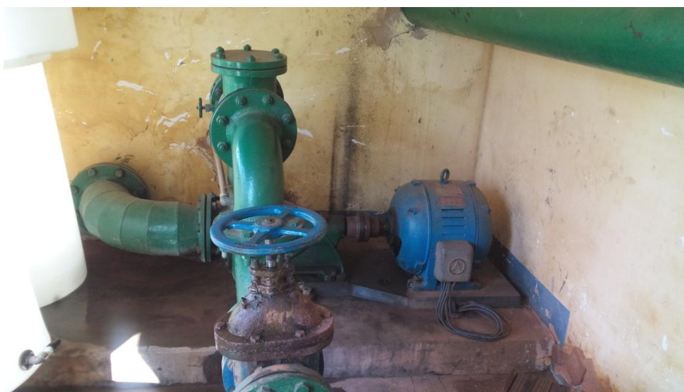
Foto 3.44 – Detalhe da bomba de recalque junto ao almoxarifado da ETA
