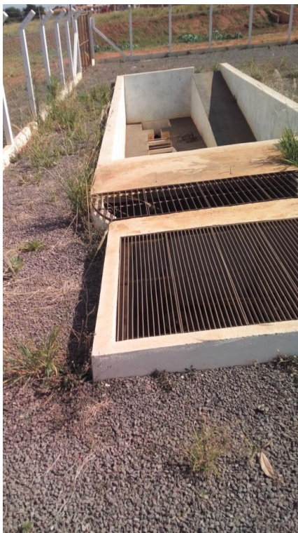
Foto 3.51 – Vista da caixa de areia e do poço de sucção da EEE Jardim Itália
