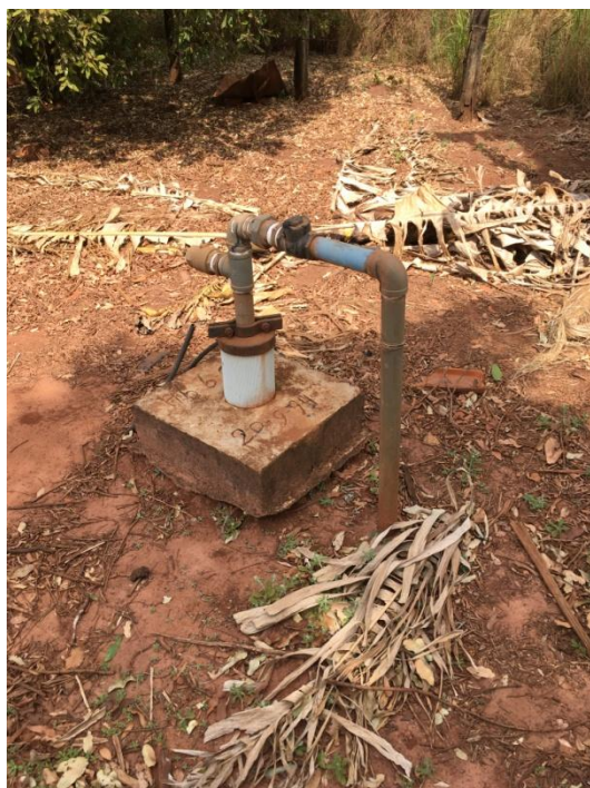
Foto 3.47 – Poço Subterrâneo do Distrito de Ribeiro do Vale
