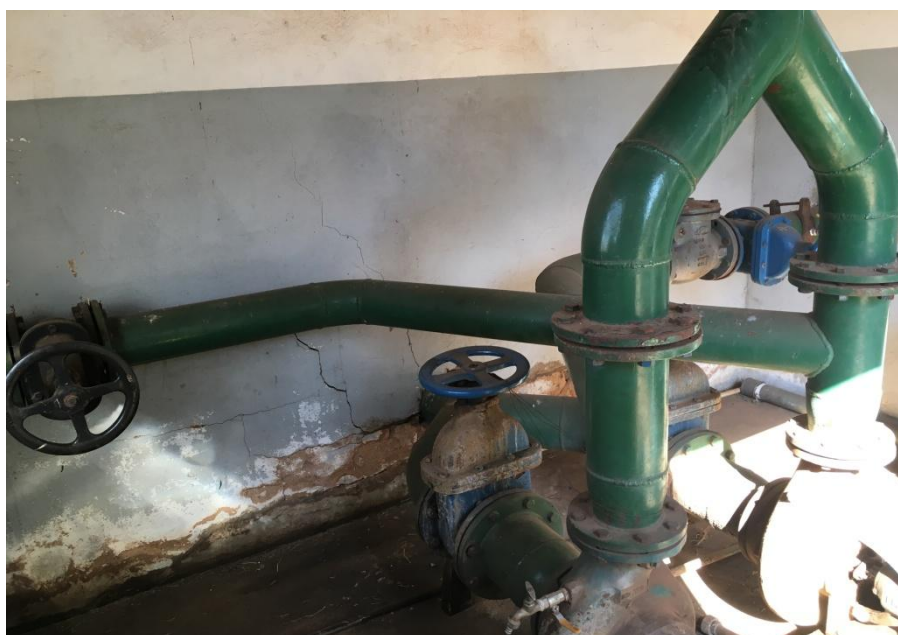
Foto 3.46 – Detalhe das bombas de recalque junto ao reservatório de 1.250 m 3
