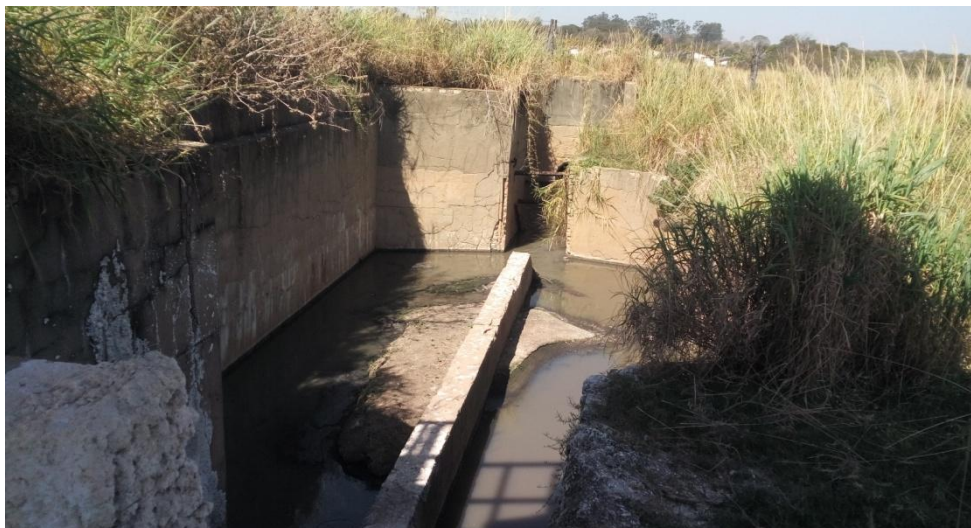
Foto 3.70 – Vista da caixa de areia da ETE Barra Grande
