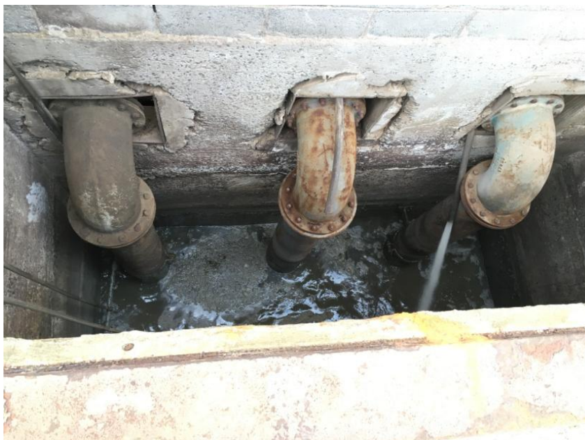
Foto 3.53 – Poço de Sucção da EEE Final – ETE Frutal
