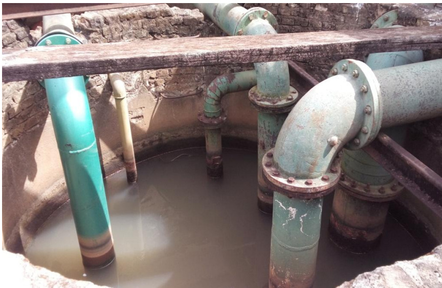
Foto 3.10 – Detalhe do poço de sucção da captação
