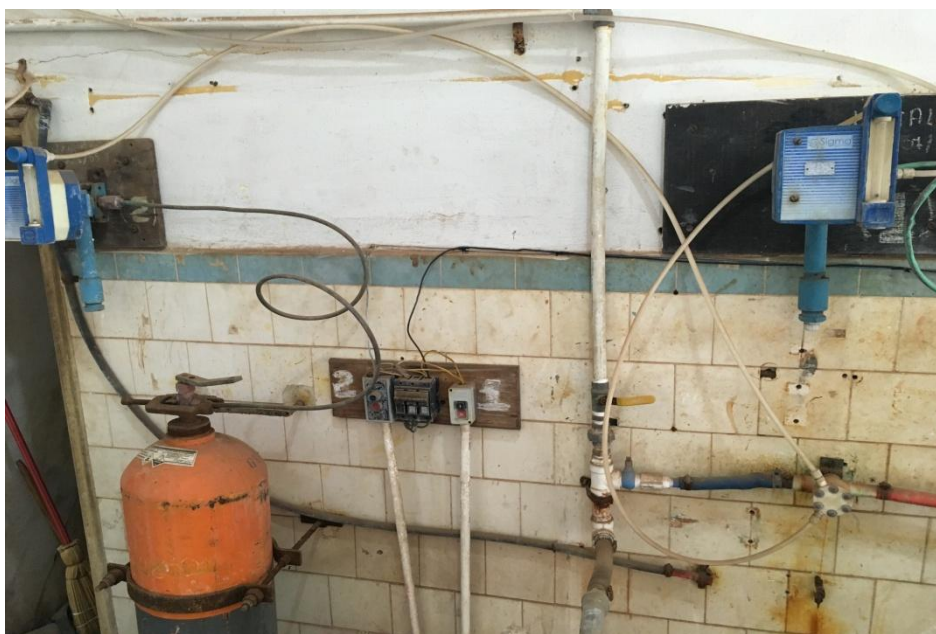
Foto 3.23 – Detalhe dos dosadores de cloro
