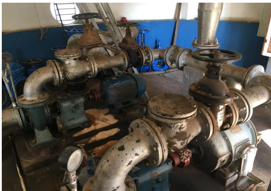
Foto 3.45 – Detalhe da EEAT localizada junto ao reservatório elevado de 75 m 3
