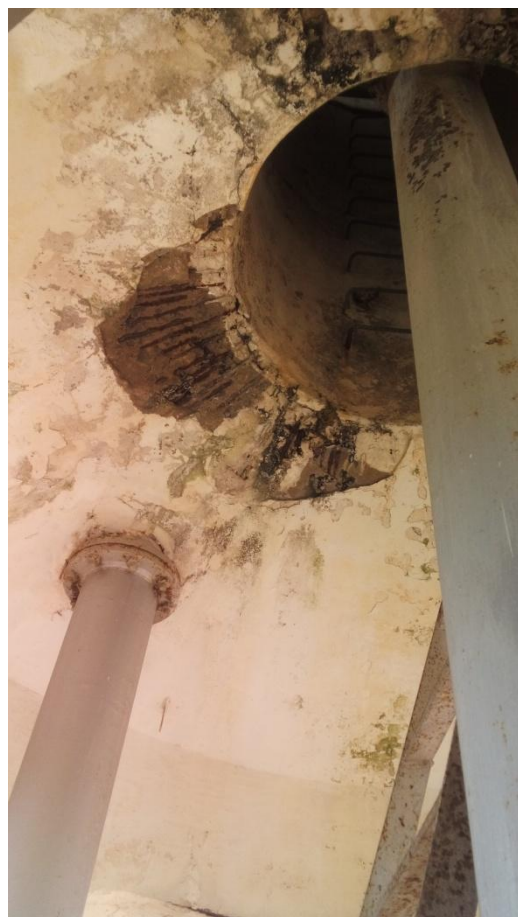
Foto 3.30 – Vista do fundo de Reservatório Elevado em condições precárias - ETA
