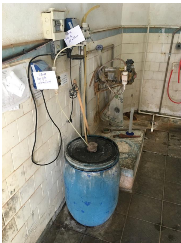
Foto 3.22 – Detalhe dos dosadores de flúor
