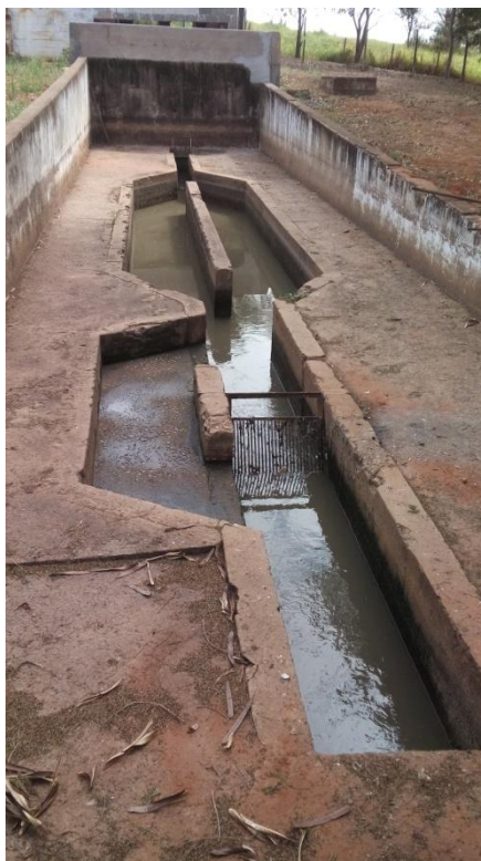
Foto 3.52 – Vista do gradeamento e caixa de areia que antecede ao Poço de Sucção da EEE Final – ETE Frutal
