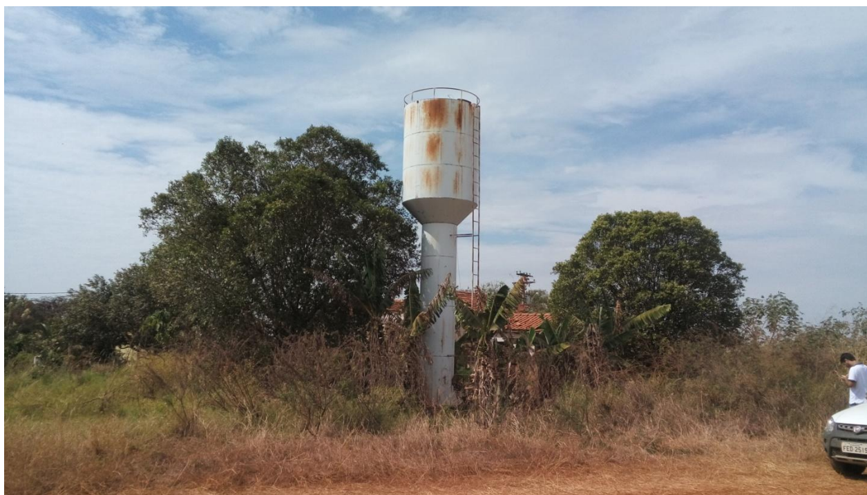
Foto 3.49 – Reservatório do Distrito de Ribeiro do Vale na área do poço
