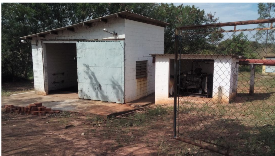
Foto 3.56 – Vista da EEE Final e do abrigo do gerador de energia
