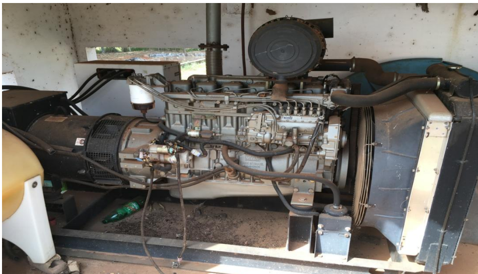
Foto 3.57 – Detalhe do gerador de energia da EEE Final
