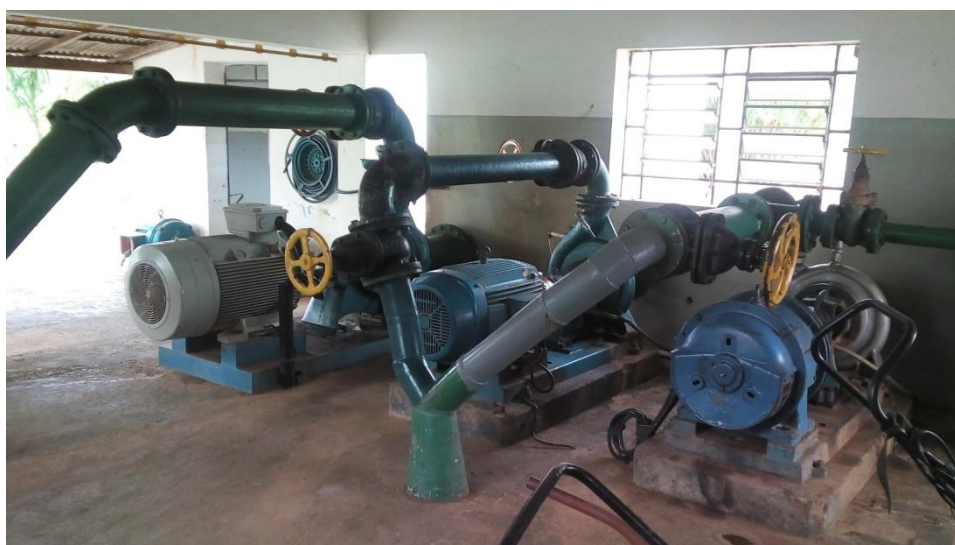
Foto 3.14 – Detalhe das bombas da sala 02 da EEAB
