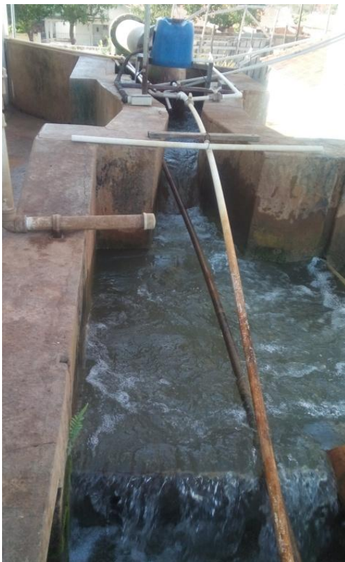
Foto 3.16 – Vista da entrada de água da ETA e a calha Parshall com adição dos produtos químicos
