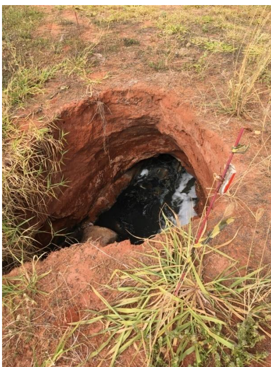
Foto 3.68 – Detalhe da erosão provocada pelo vazamento de esgotos na ETE Frutal
