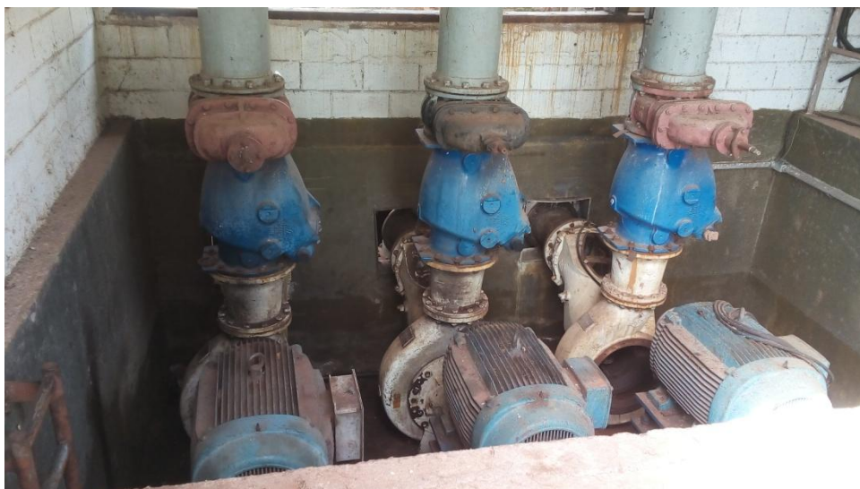
Foto 3.55 – Detalhe dos conjuntos motobomba da EEE Final – ETE Frutal
