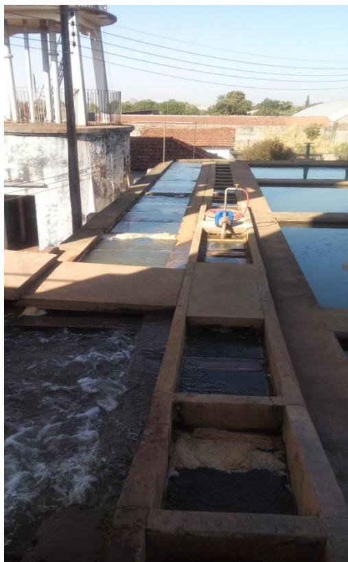
Foto 3.17 – Vista dos Floculadores
