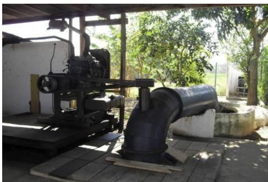
Foto 36 - Estação de Bombeamento Gráfica Dias.
