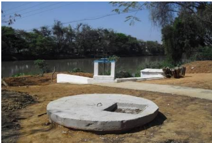
Foto 33 - Estação de Bombeamento Campo do Galvão.
