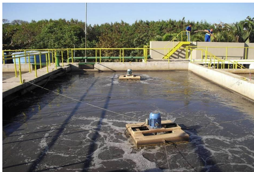
Foto 08 - ETE Campo do Galvão – Tanque de Aeração.
