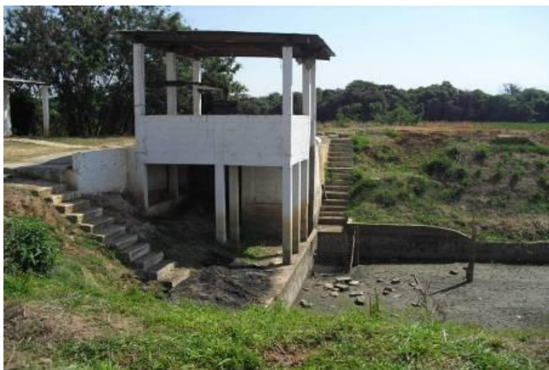
Foto 31 - Estação de Bombeamento Chácara Selles – Bairro Campo do Galvão.
