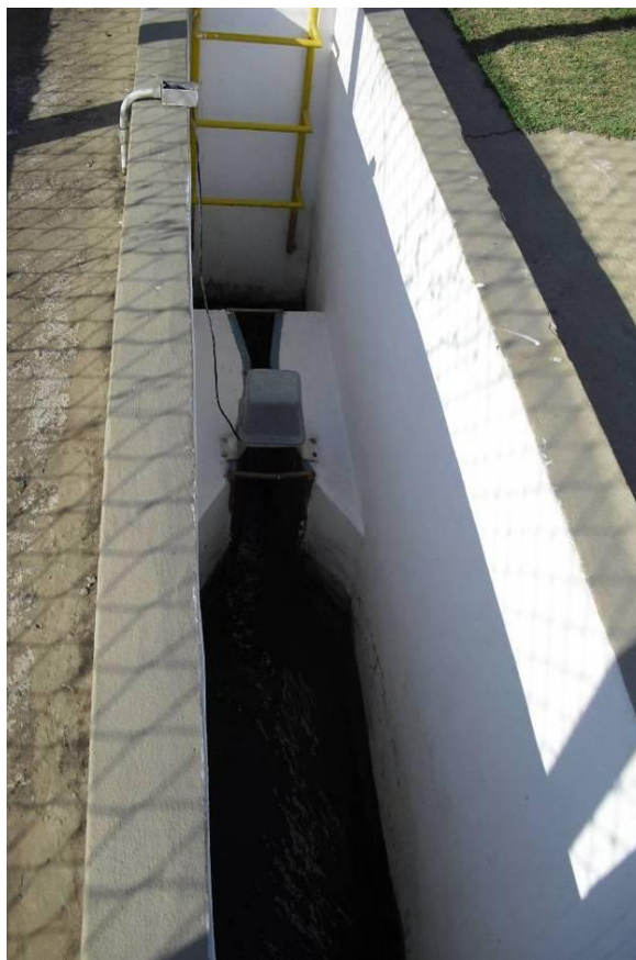
Foto 07 - ETE Campo do Galvão – Calha Parshall.
