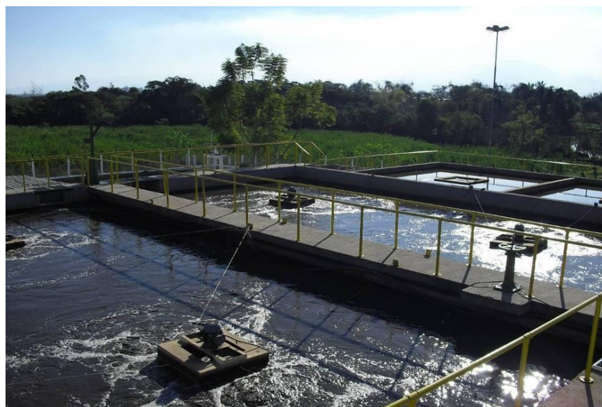
Foto 10 - ETE Campo do Galvão – Tanques de Aeração.
