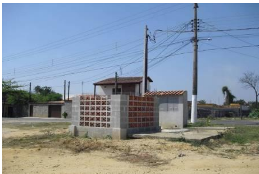
Foto 25 - Estação de Bombeamento Parque das Árvores.
