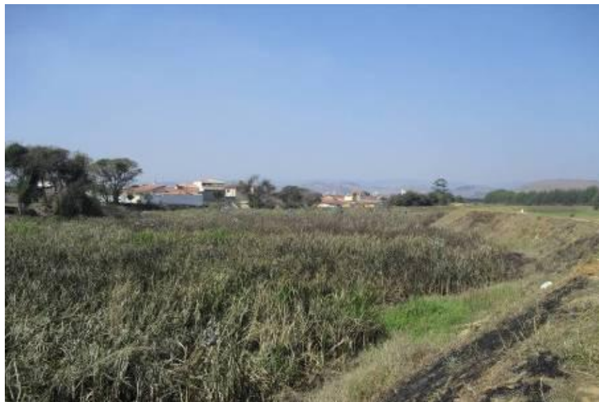
Foto 22 - Dique de Contenção no Parque das Árvores – direciona as águas pluviais para a Estação de Bombeamento do Rony.
