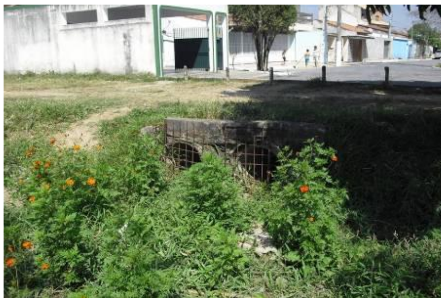
Foto 19 - Tubulação de Coleta e Transporte da Água Pluvial – passa sob a Rua José Amilca Bedaque e conduz sua vazão para a Estação de Bombeamento Rony.
