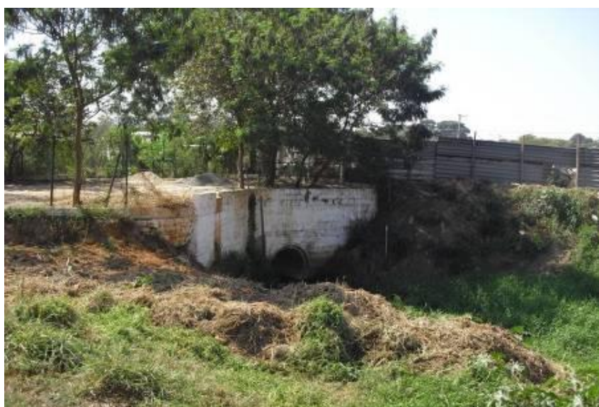
Foto 35 - Entrada da Água para o Poço de Sucção da Estação de Bombeamento Gráfica Dias.
