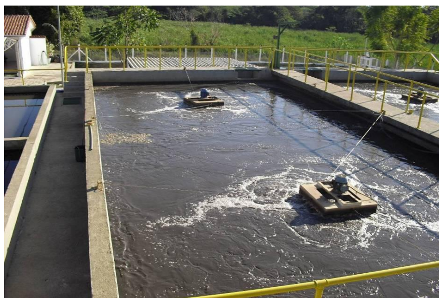
Foto 09 - ETE Campo do Galvão – Tanques de Aeração.
