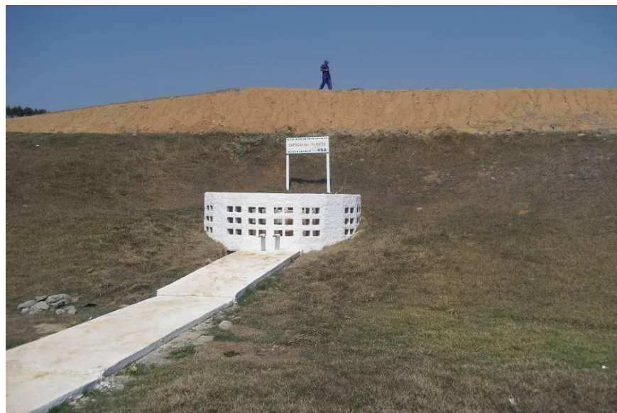
Foto 15 - Poço de Captação de Líquidos Percolados.
