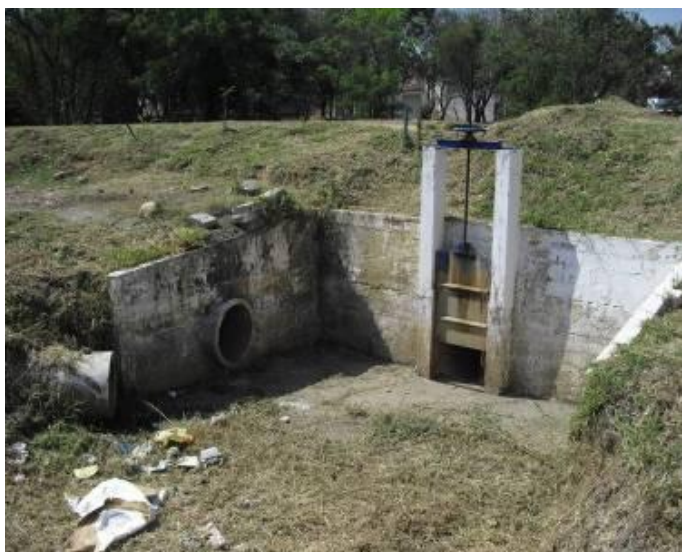
Foto 29 - Estação de Bombeamento do Nino – uso de bomba agrícola (trator) para recalque das águas Pluviais.
