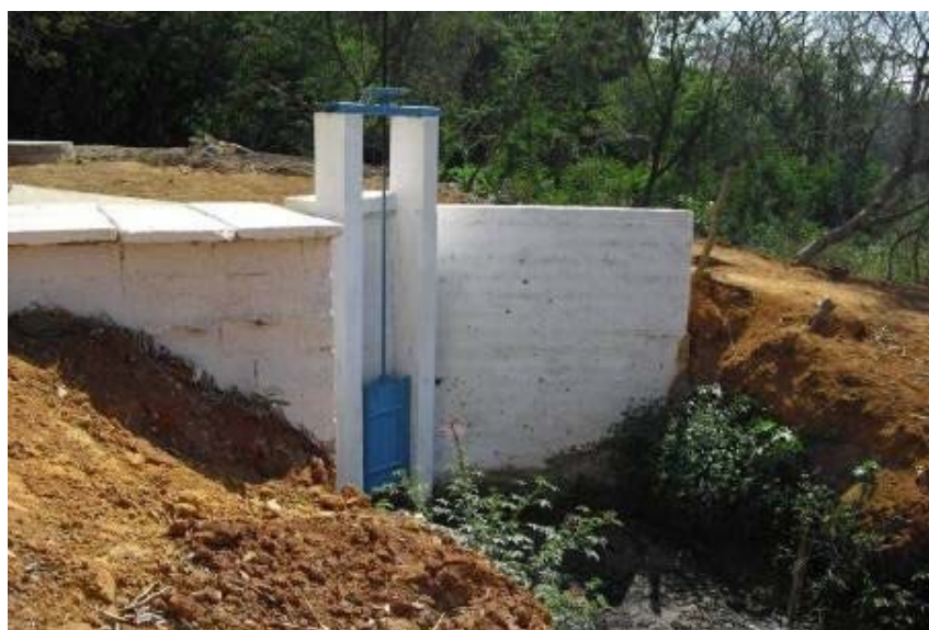
Foto 34 - Comporta da Estação de Bombeamento Campo do Galvão.
