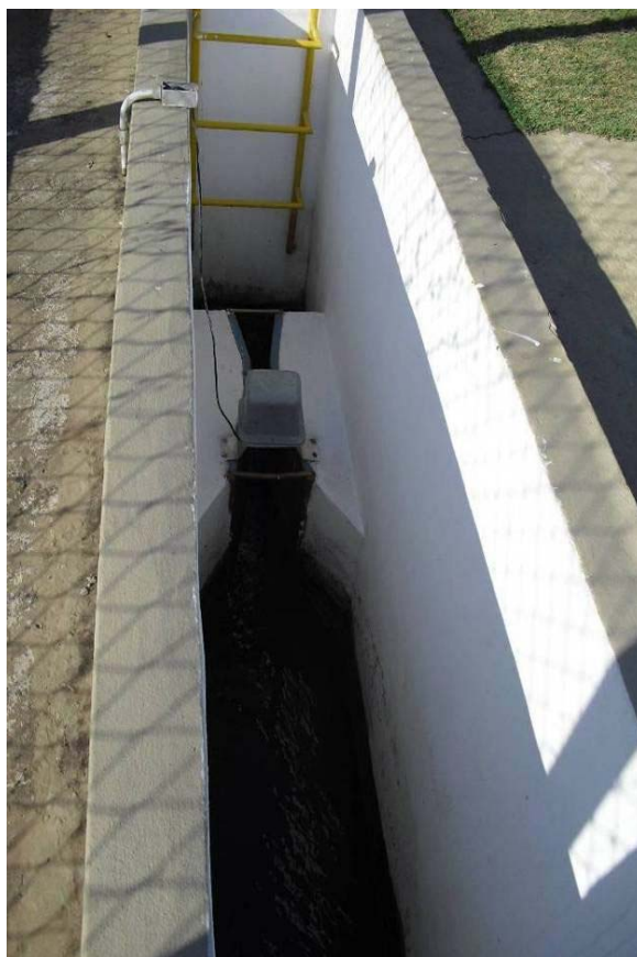
Foto 07 - ETE Campo do Galvão – Calha Parshall.
