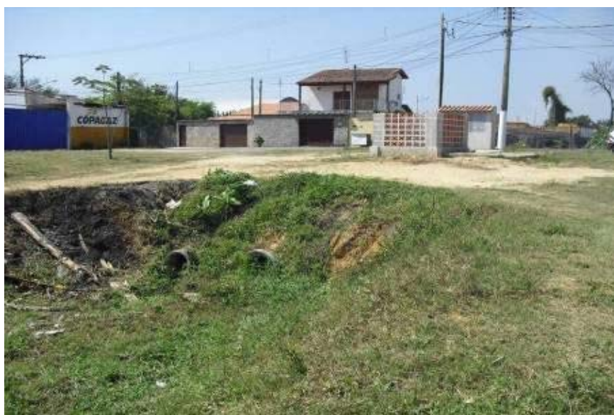
Foto 26 - Tubulação de Coleta das Águas Pluviais Ligadas ao Poço de Sucção da Estação de Bombeamento – Parque das Árvores.
