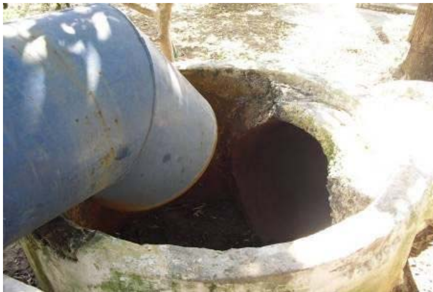
Foto 37 - Saída da Água – Estação de Bombeamento Gráfica Dias.
