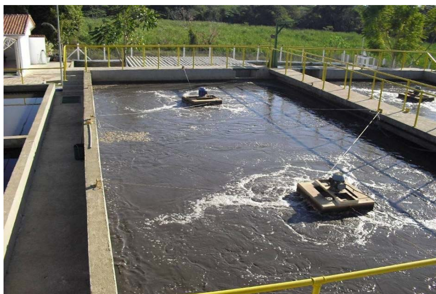
Foto 09 - ETE Campo do Galvão – Tanques de Aeração.
