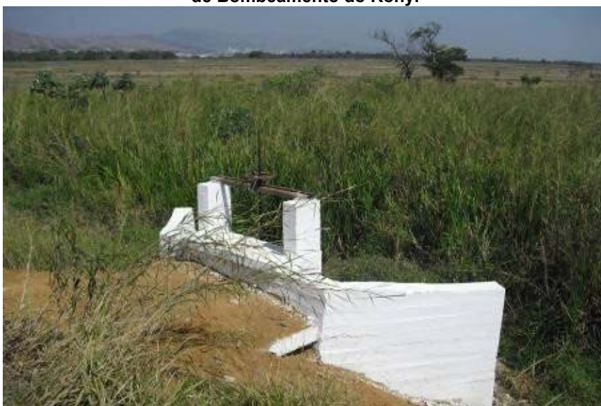
Foto 21 - Comporta Localizada no Dique Parque das Árvores – é fechada quando da elevação das águas do Rio Paraíba.
