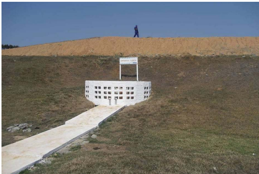
Foto 15 - Poço de Captação de Líquidos Percolados.
