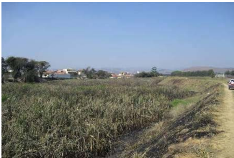
Foto 20 - Dique de Proteção do Parque das Árvores – as águas são direcionadas para a Estação de Bombeamento do Rony.
