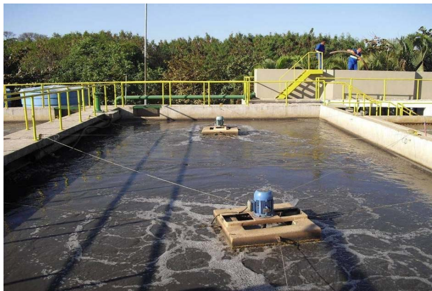
Foto 08 - ETE Campo do Galvão – Tanque de Aeração.
