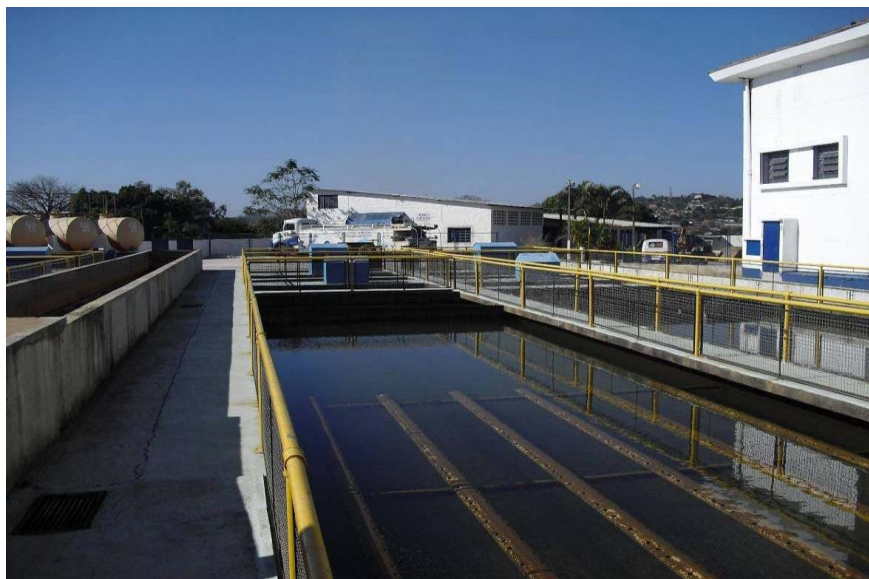
Foto 03 - Estação de Tratamento de Água – SAEG.
