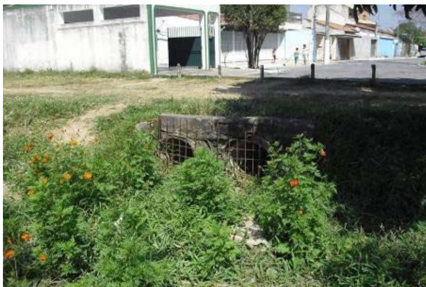
Foto 19 - Tubulação de Coleta e Transporte da Água Pluvial – passa sob a Rua José Amílcar Bedaque e conduz sua vazão para a Estação de Bombeamento Rony.
