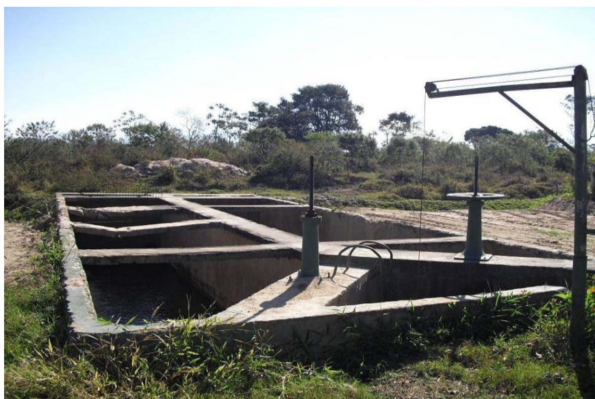
Foto 02 - Caixa de Areia junto à Captação do Ribeirão Guaratinguetá.
