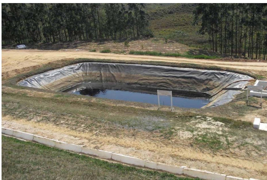
Foto 16 - Tanque Reservatório de Líquidos Percolados.
