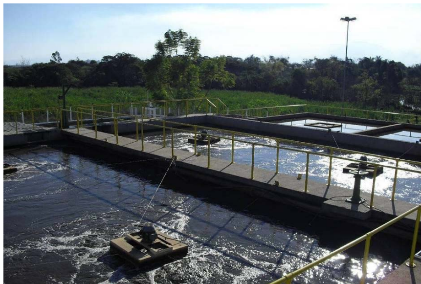
Foto 10 - ETE Campo do Galvão – Tanques de Aeração.
