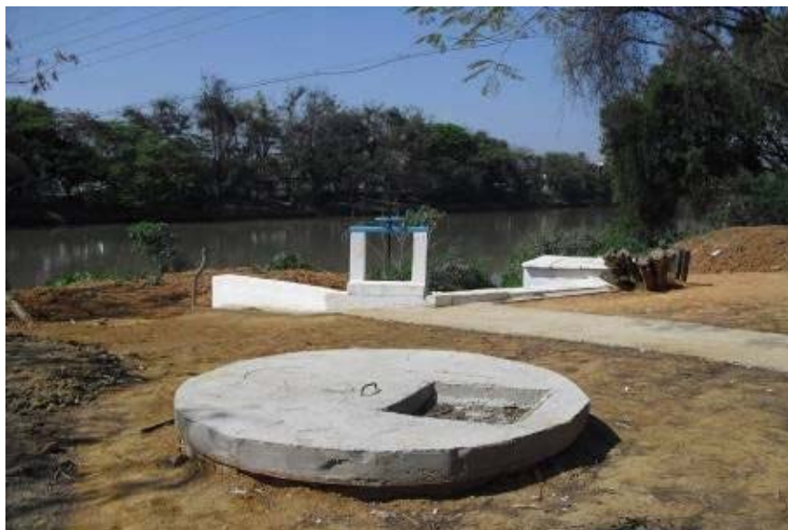
Foto 33 - Estação de Bombeamento Campo do Galvão.
