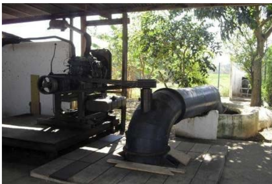
Foto 36 - Estação de Bombeamento Gráfica Dias.
