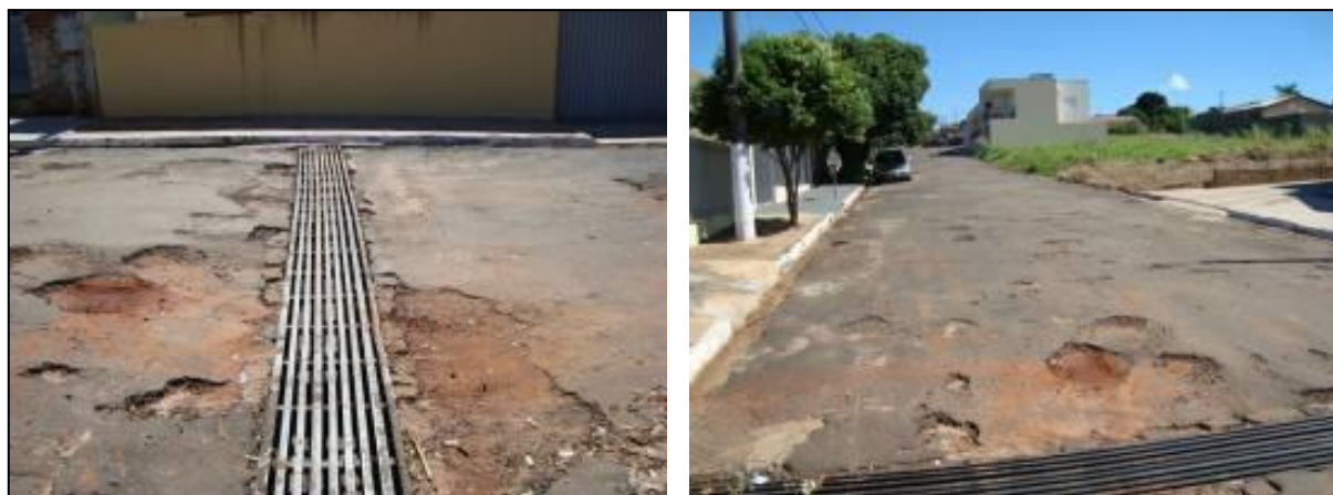
Figura 79. Alagamento e destruição de pavimento na Avenida São João e Rua Castro Alves
