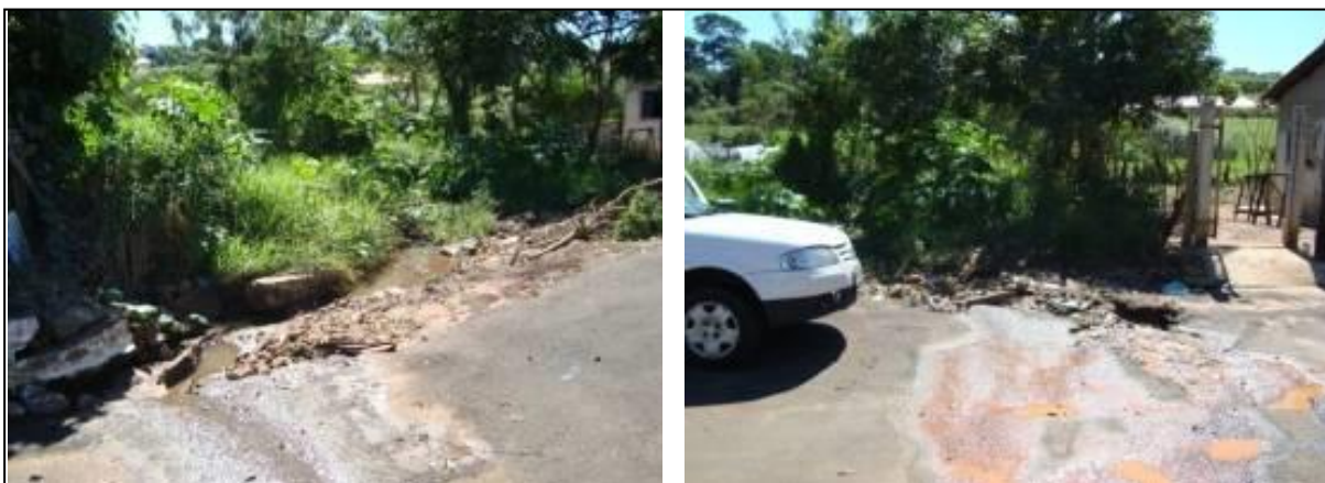
Figura 72. Alagamento e destruição de pavimento na Rua Arthur Gonçalves Salgado
