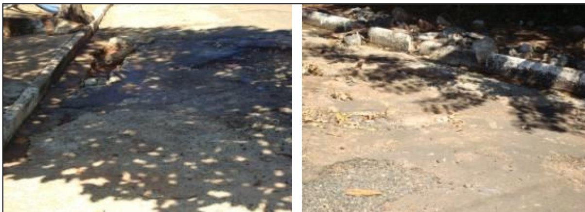
Figura 70. Alagamento e destruição de pavimento na Rua Benjamin Hadba
