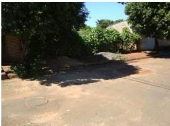
Figura 80. Alagamento e destruição de pavimento na Avenida São João e Rua Castro Alves
