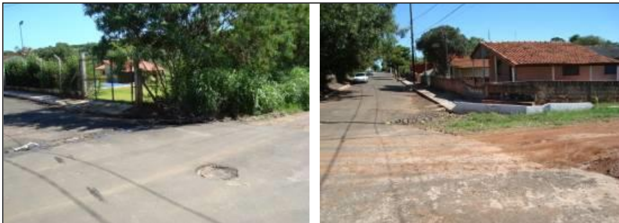
Figura 76. Alagamento na Avenida Rui Barbosa e Rua Antônio Chechim
