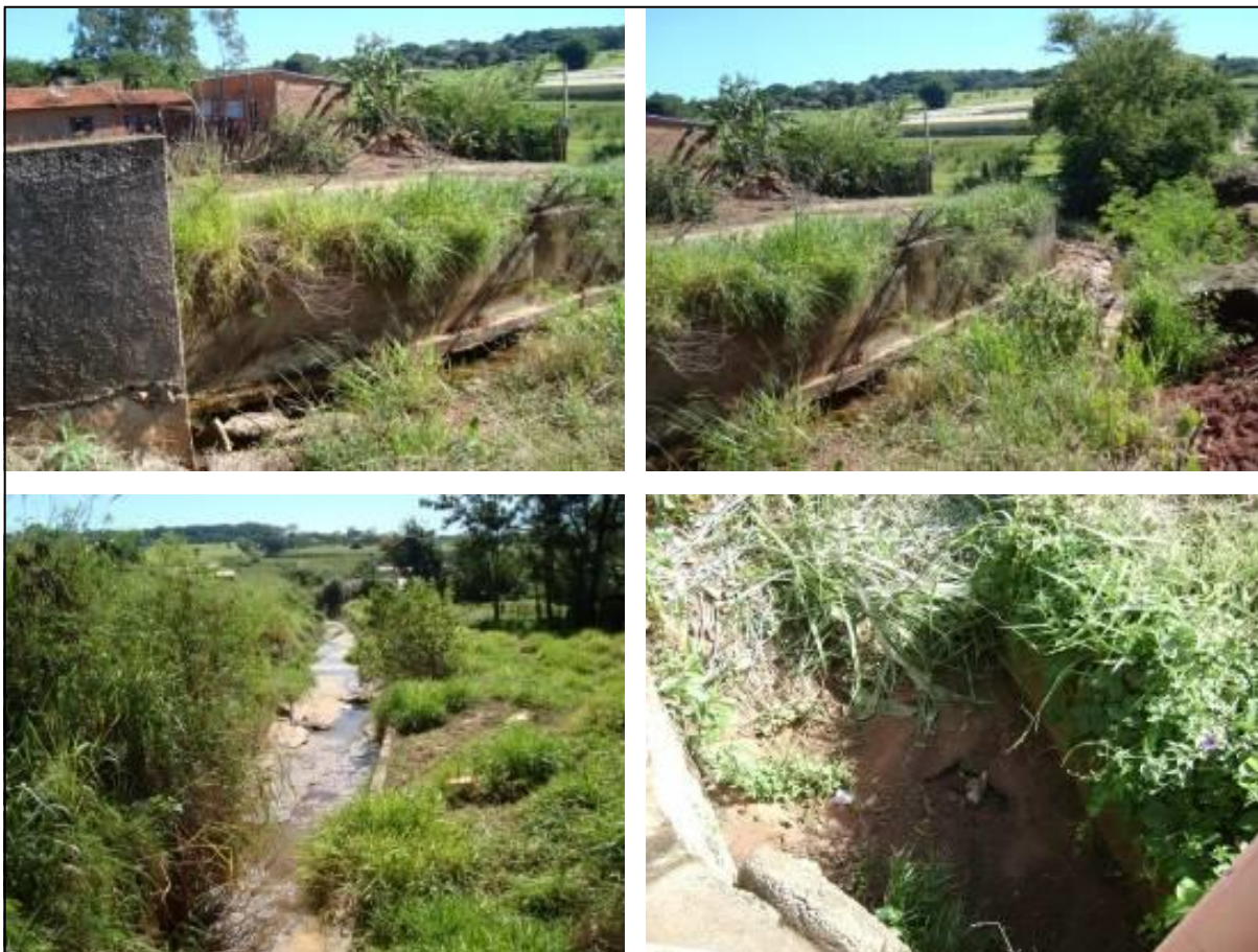
Figura 62. Trecho de erosão e destruição de galerias sob a Rua Monsenhor João Felipe (ponte) e Avenida Laemert Garcia dos Santos
