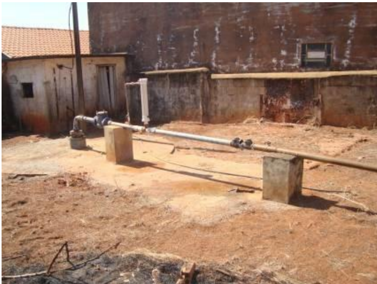
Figura 19. Poço tubular (P1) - desativado
