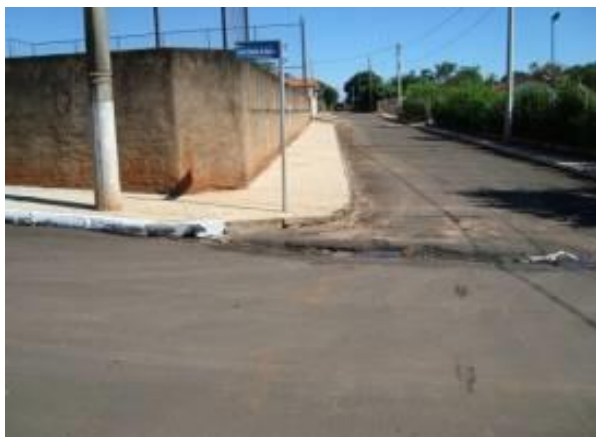
Figura 75. Alagamento e destruição de pavimento na Rua José Caldas de Souza
