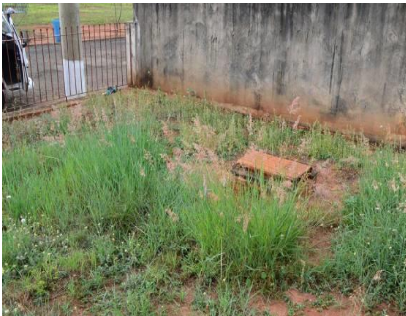
Figura 46. Fossa séptica do loteamento Vale das Águas
