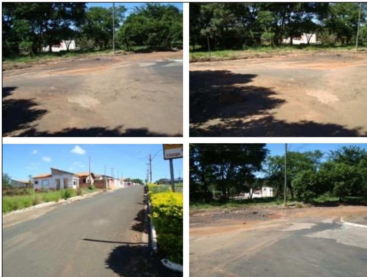
Figura 83. Alagamento e destruição de pavimento na Avenida São João e Avenidas das Acácias
