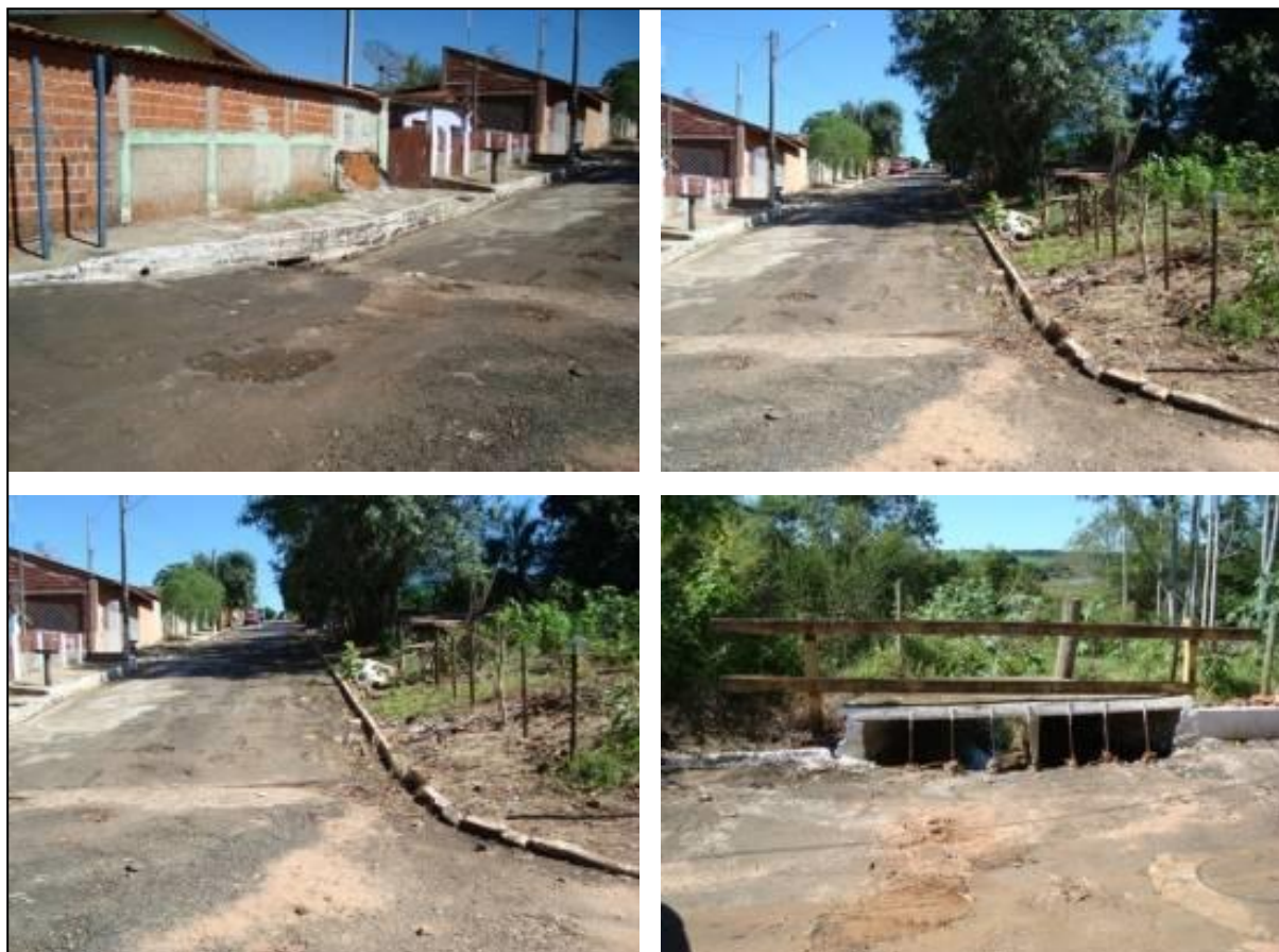
Figura 77. Alagamento e destruição de pavimento na Avenida São João e Rua Paulo da Silveira Bello
