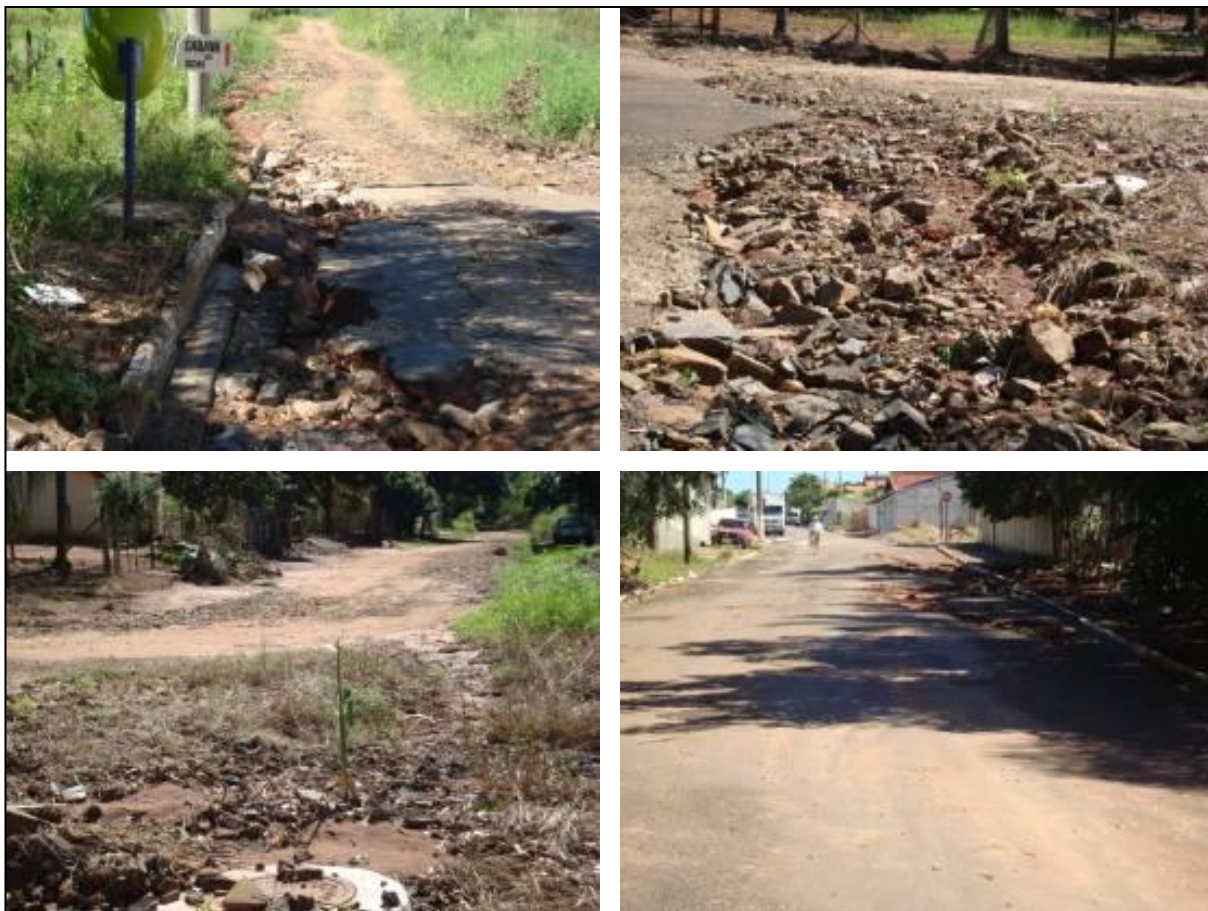
Figura 81. Alagamento e destruição de pavimento na Avenida São João e Rua dos Pinheiros
