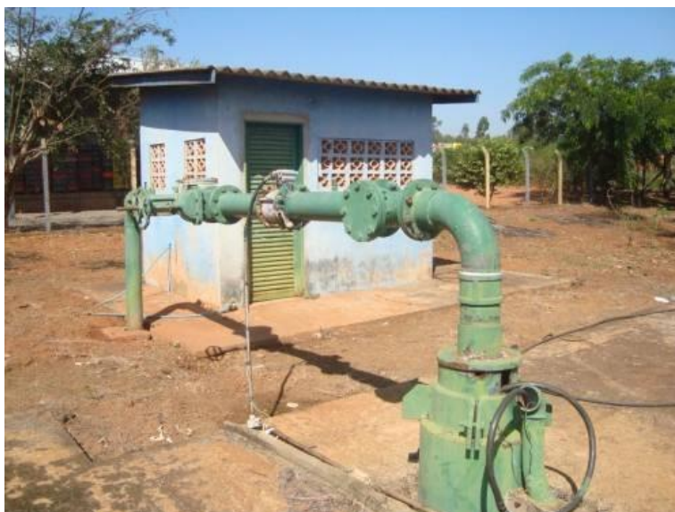
Figura 20. Poço tubular (P2)
