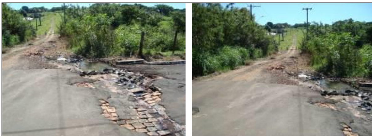
Figura 74. Alagamento e destruição de pavimento na Rua José Caldas de Souza
