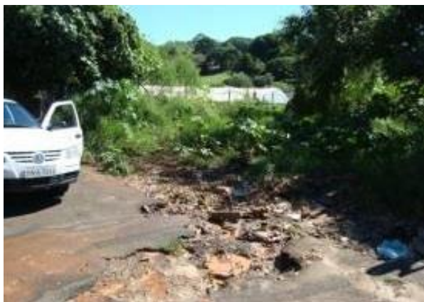
Figura 73. Alagamento e destruição de pavimento na Rua Arthur Gonçalves Salgado
