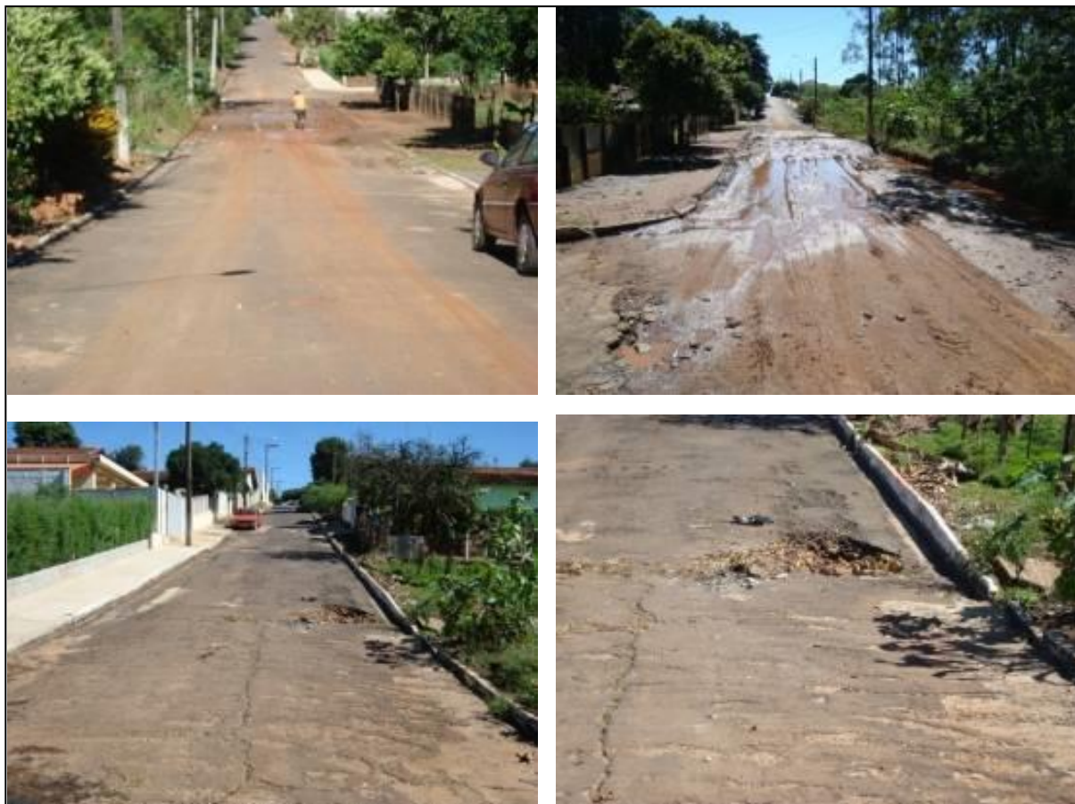
Figura 78. Alagamento e destruição de pavimento na Avenida São João e Rua Rodrigo de Campos
