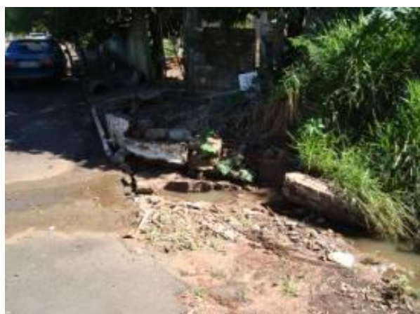
Figura 71. Alagamento e destruição de pavimento na Rua Benjamin Hadba
