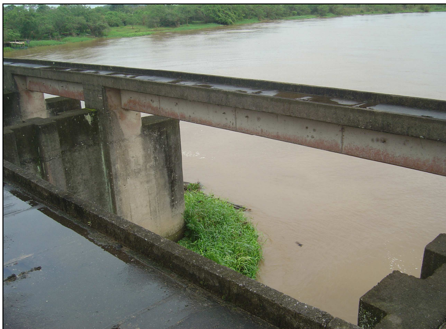
Foto 2 – Estrutura hidráulica junto à ponte sobre o Valo Grande. Note-se a ausência de comportas para o controle de vazões
