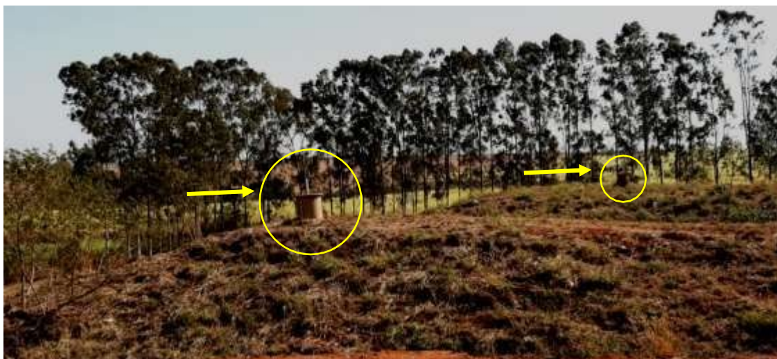
Figura 40. Drenos de liberação de gás proveniente da decomposição dos resíduos.
