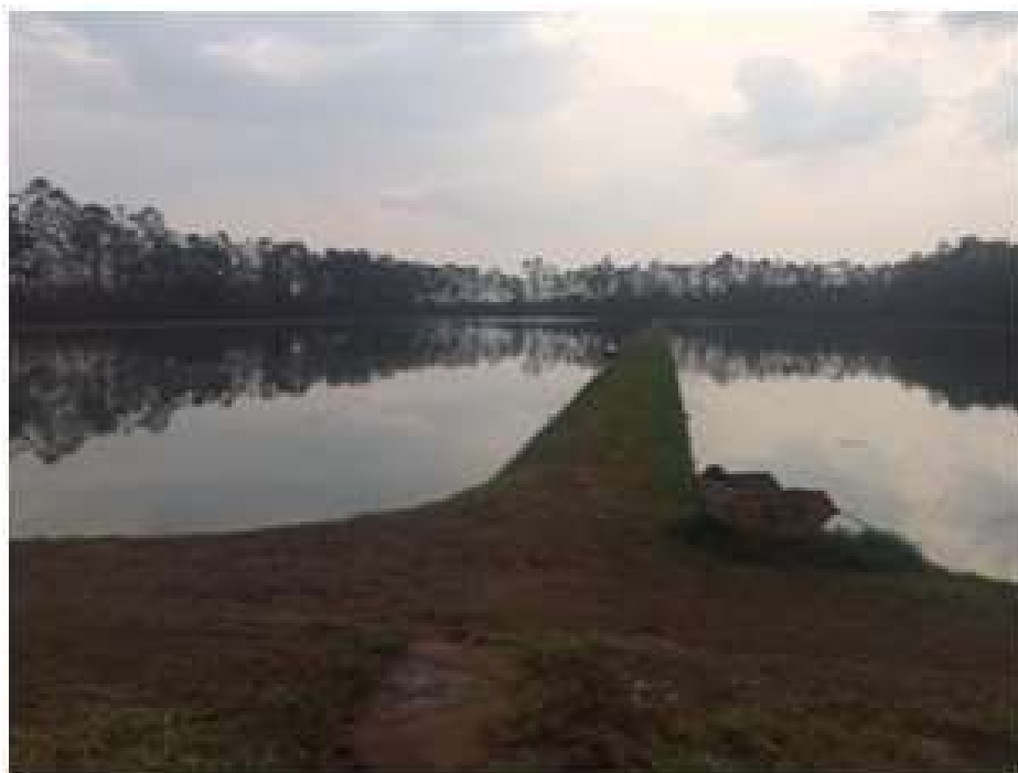
Figura 112. Registro do Talude das lagoas de tratamento de Esgoto.
