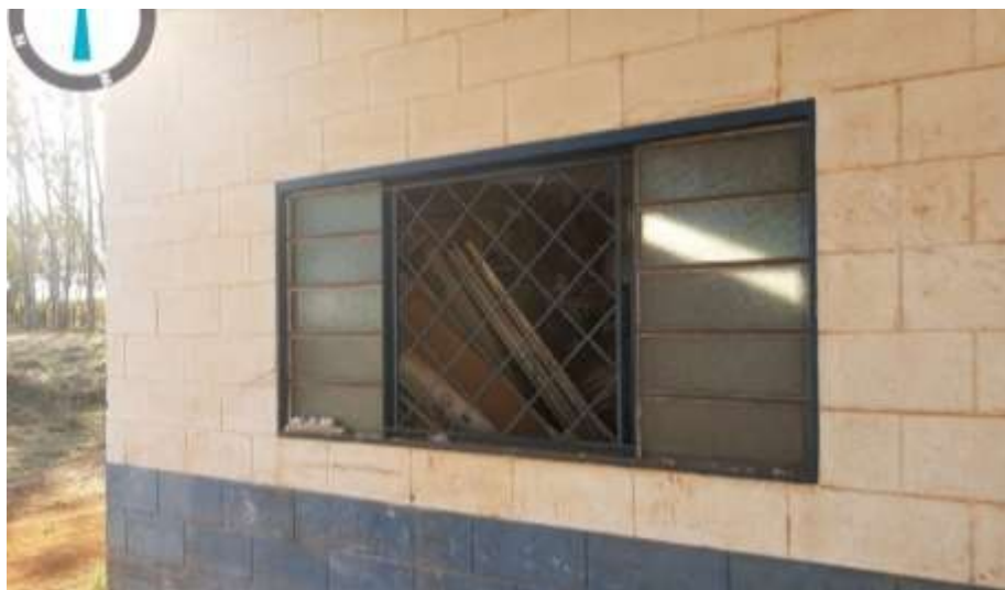
Figura 130. Local onde são armazenadas as lâmpadas nas dependências do aterro sanitário.
