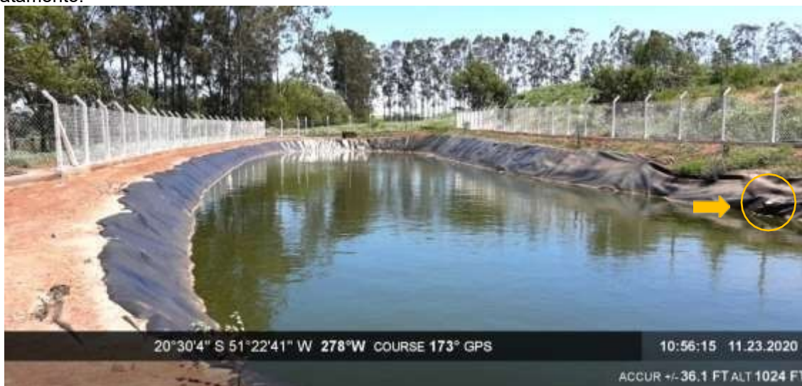
Figura 41. Duto de saída do chorume conduzido por gravidade das células para a lagoa de tratamento.
