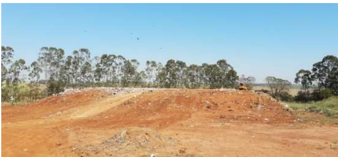
Figura 35. Vista geral da célula em operação.
