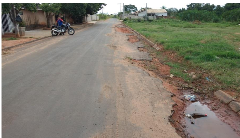
Foto 3.22 – Rua Valentim Gentil x Rua Visconde do Rio Branco (no mesmo local onde há uma erosão)
