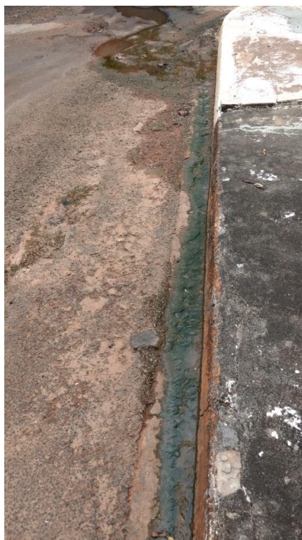
Foto 3.12 – Esgoto na Rua José Orlandeli
