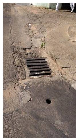
Foto 3.13 – Estrutura de microdrenagem insuficiente
