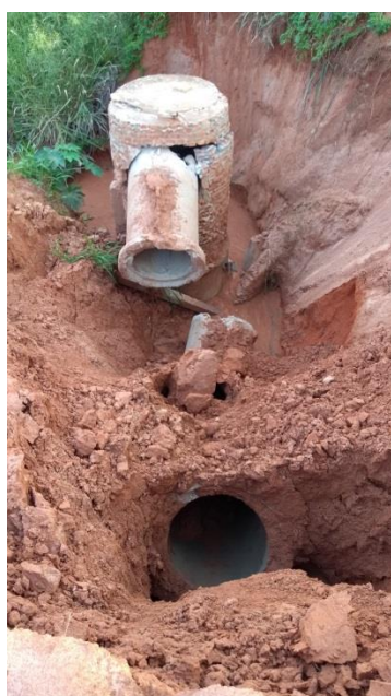
Foto 3.32 – Erosão causada pelo rompimento de galeria
