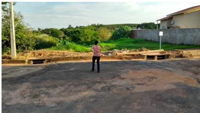
Foto 3.38 – Ponto de alagamento e carreamento de materiais
