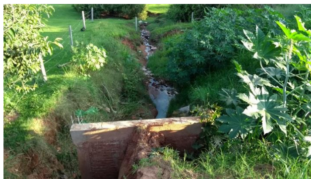
Foto 3.39 – Erosão no lançamento da galeria
