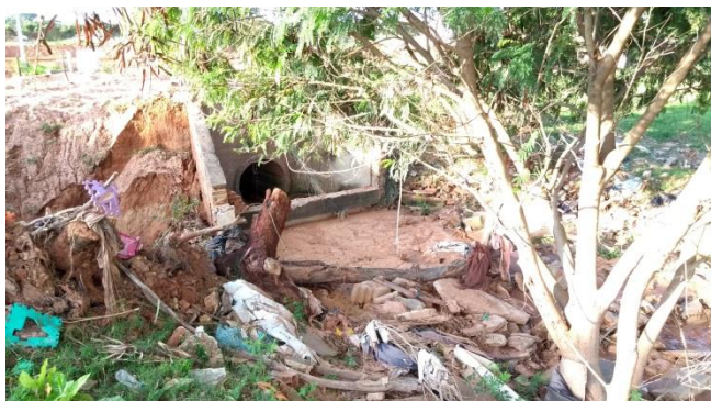
Foto 3.34 – Erosão e assoreamento de galeria
