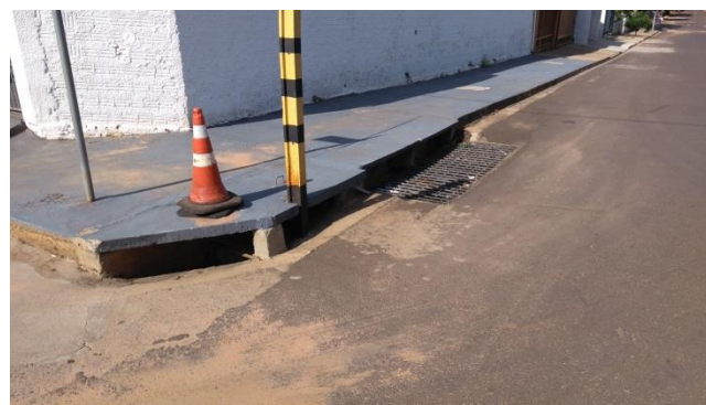
Foto 3.15 – Estrutura de microdrenagem
