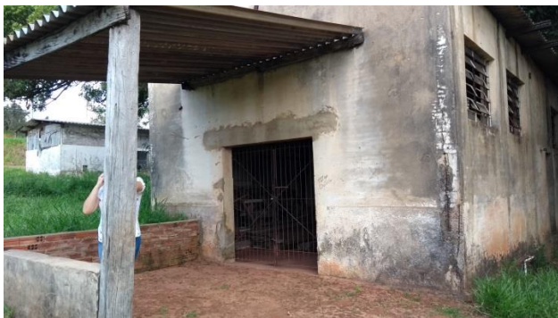
Foto 3.8 – Vista da área de armazenamento de pneus
