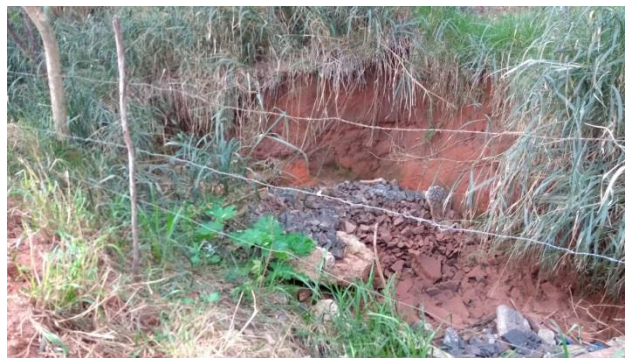
Foto 3.43 – Assoreamento e erosão
