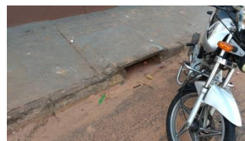
Foto 3.11 – Estrutura de microdrenagem
