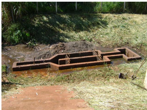
FOTO 4.25 – GRADEAMENTO E CAIXA DE AREIA DA ETE IPAUSSU
