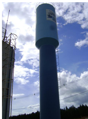
FOTO 4.13 – RESERVATÓRIO DO BAIRRO CÔNEGO NAZARENO
