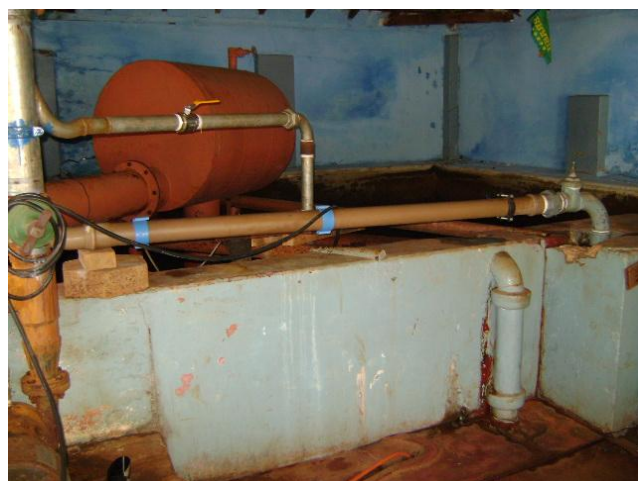
FOTO 4.2 – POÇO P4 QUE ABASTECE O SISTEMA CENTRAL
