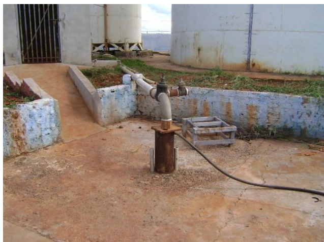
FOTO 4.7 – POÇO DO SISTEMA JOÃO MARTINS
