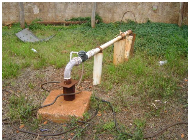
FOTO 4.20 – POÇO P9 DO SISTEMA COCAJÁ II
