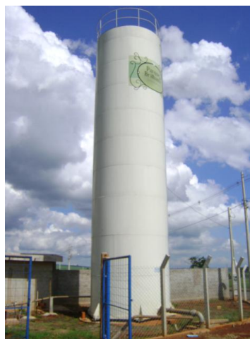
FOTO 4.22 – RESERVATÓRIO DO SISTEMA JARDIM DOS BRILHANTES II
