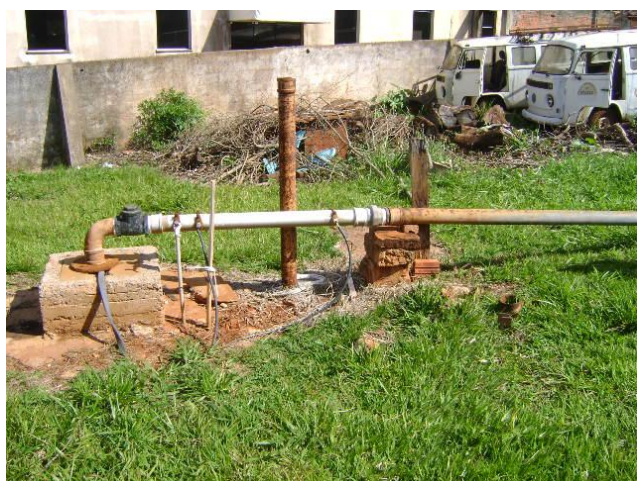
FOTO 4.1 – POÇO P3 QUE ABASTECE O SISTEMA CENTRAL
