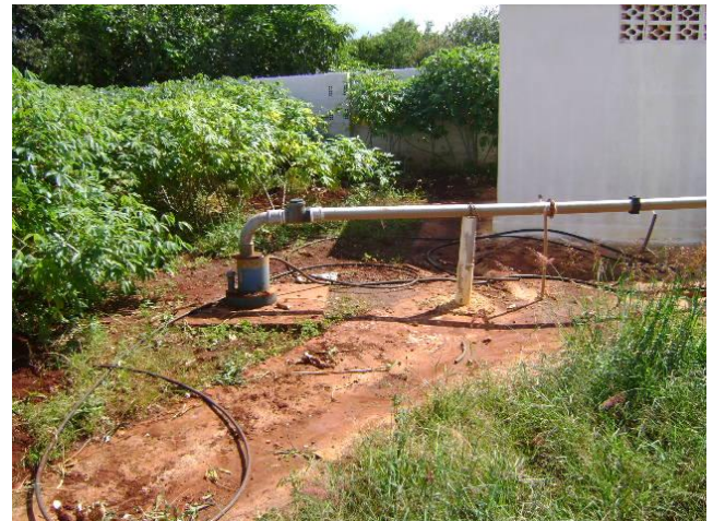
FOTO 4.17 – POÇO P6 QUE ABASTECE O SISTEMA ESTAÇÃO E O SISTEMA CENTRAL DE IPAUSSU
