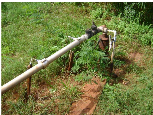
FOTO 4.10 – POÇO P7 QUE ABASTECE O SISTEMA DO DISTRITO INDUSTRIAL
