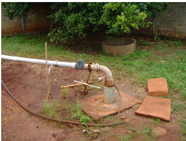
FOTO 4.14 – POÇO P8 QUE ABASTECE O SISTEMA COCAJÁ I
