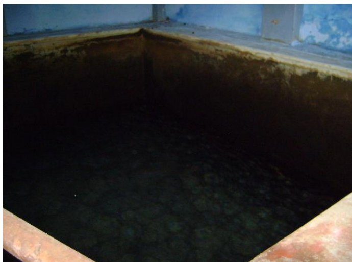
FOTO 4.5 – RESERVATÓRIO SEMIENTERRADO R2 CENTRAL
