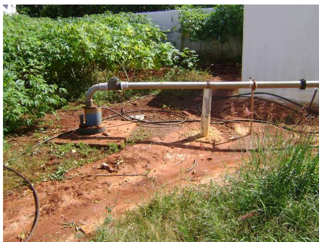
FOTO 4.3 – POÇO P6 QUE ABASTECE O SISTEMA CENTRAL E O SISTEMA ESTAÇÃO
