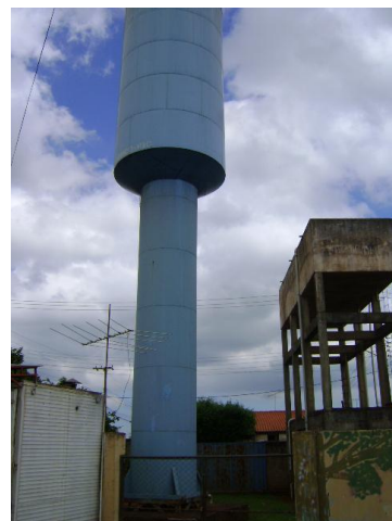
FOTO 4.15 – RESERVATÓRIO DO SISTEMA COCAJÁ I
