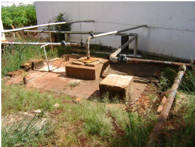
FOTO 4.16 – POÇO P5 QUE ABASTECE O SISTEMA ESTAÇÃO
