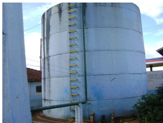
FOTO 4.4 – RESERVATÓRIO METÁLICO R RESERVA DE 250M 3
