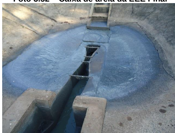
Foto 3.54 – Problema de transbordamento de esgoto no horário de pico da EEE
