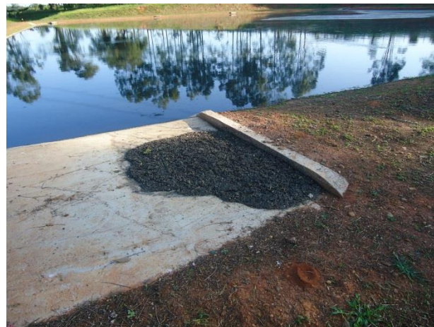
Foto 3.58 – Baía de concreto para disposição do sobrenadante da lagoa anaeróbia
