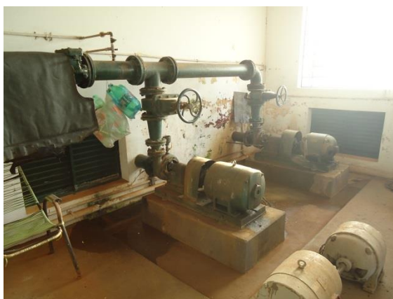
Foto 3.48 – Conjuntos motobombas - EEAT
