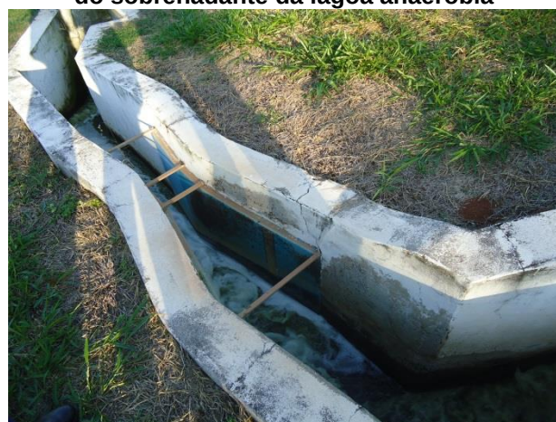
Foto 3.60 – Calha Parshall de saída do tratamento
