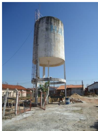
Foto 3.11 - Reservatório elevado – R-04
