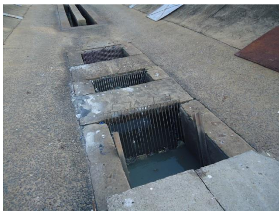
Foto 3.51 – Gradeamento da EEE Final
