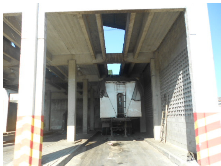
Foto 2- Estação de transbordo - vista do poço com carreta Fonte: Prefeitura, 2014
