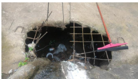
Foto 3.4 – Quebra da tampa da boca de lobo
