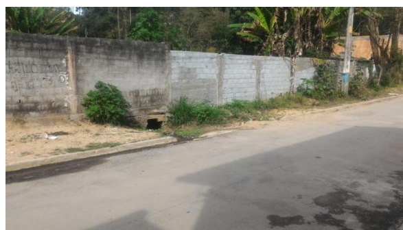
Foto 3.5 – Orifício feito por moradores para desviar o escoamento
