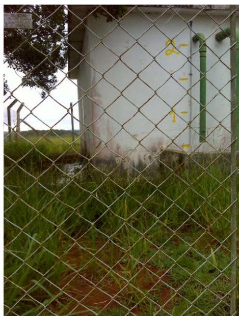
FOTO 4.46: RESERVATÓRIO SÃO ROQUE
