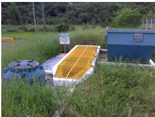
FOTO 4.102: ETE – GRADEAMENTO, CAIXA DE AREIA E RESERVATÓRIOS DE ACÚMULO DE MATERIAL GRADEADO E AREIA
