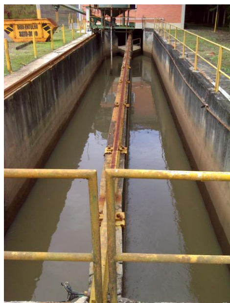
FOTO 4.67: SISTEMA SEDE - EEE FINAL – CAIXA DE AREIA
