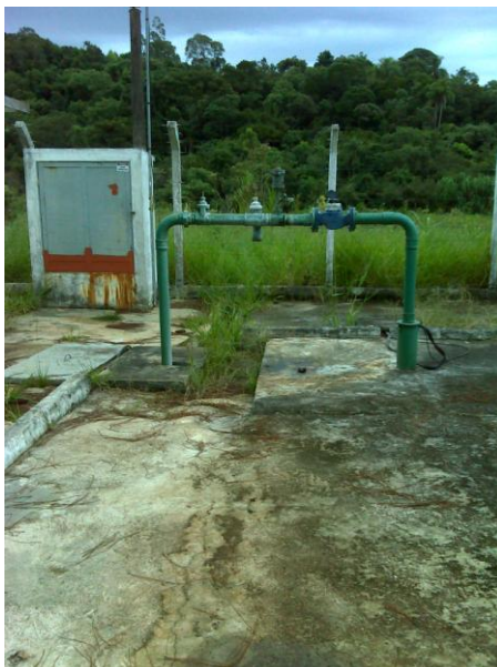
FOTO 4.51: POÇO PROFUNDO – DISTRITO CONCEIÇÃO
