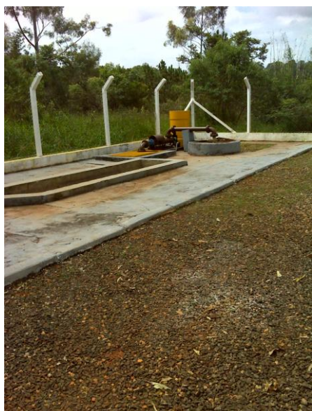
FOTO 4.61: SISTEMA SEDE - EEE SOTEMO
