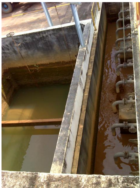
FOTO 4.17: ETA 2 – CAIXA DE RETENÇÃO DAS ÁGUAS DE LAVAGEM DA ETA
