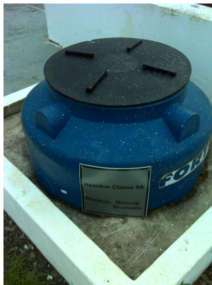
FOTO 4.81: RESERVATÓRIO DE RESÍDUO GRADEADO
