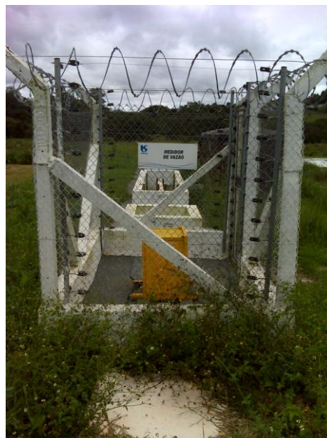
FOTO 4.100: ETE - CALHA PARSHALL
