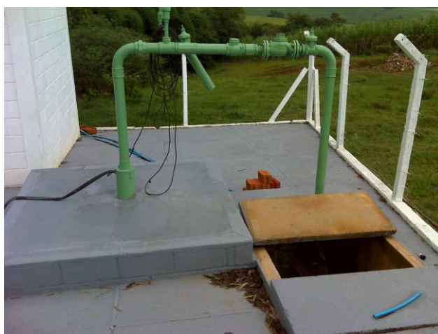
FOTO 4.41: POÇO PROFUNDO – DISTRITO MORRO DO ALTO
