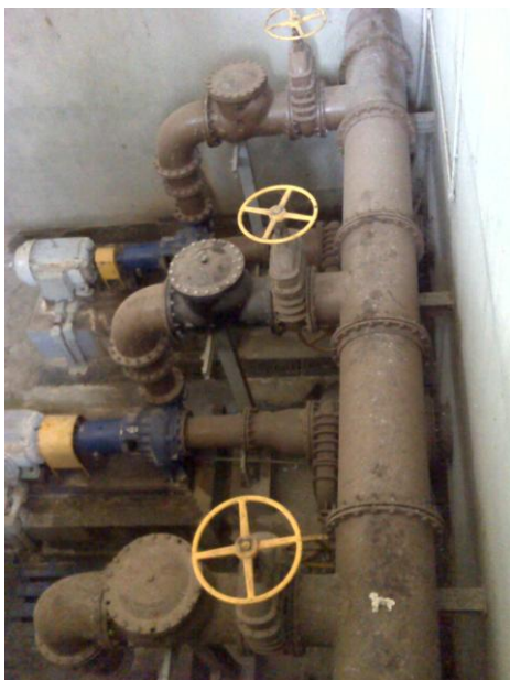
FOTO 4.69: SISTEMA SEDE - EEE FINAL – CASA DE BOMBAS
