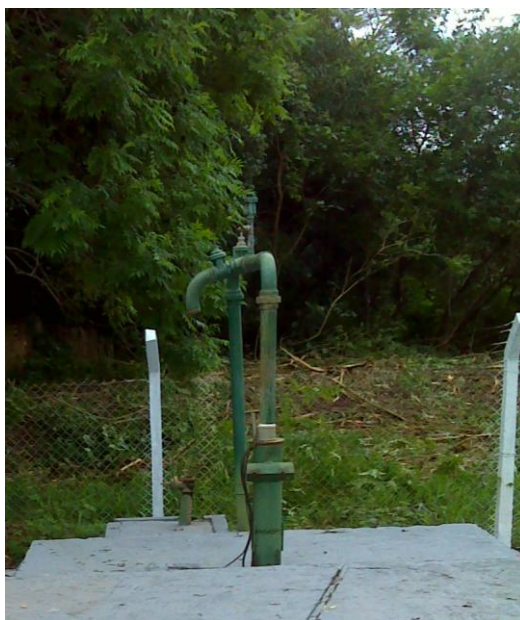
FOTO 4.37: POÇO PROFUNDO – DISTRITO TUPY
