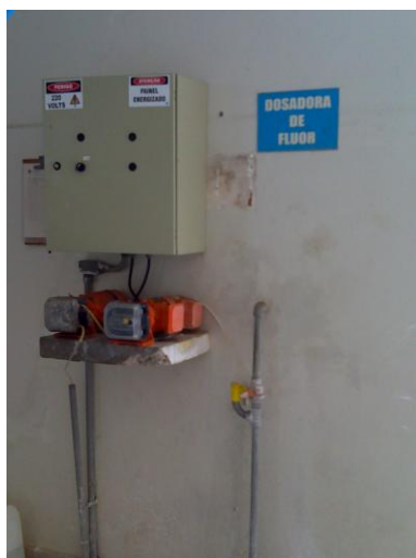
FOTO 4.32 – SISTEMA SEDE - BOMBA DOSADORA DE FLUOR
