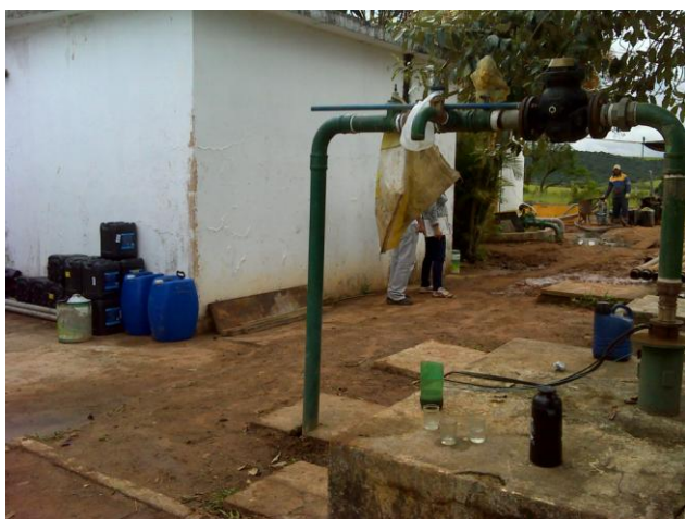
FOTO 4.34: POÇO PROFUNDO EM OPERAÇÃO– BAIRRO BISCOITO DURO
