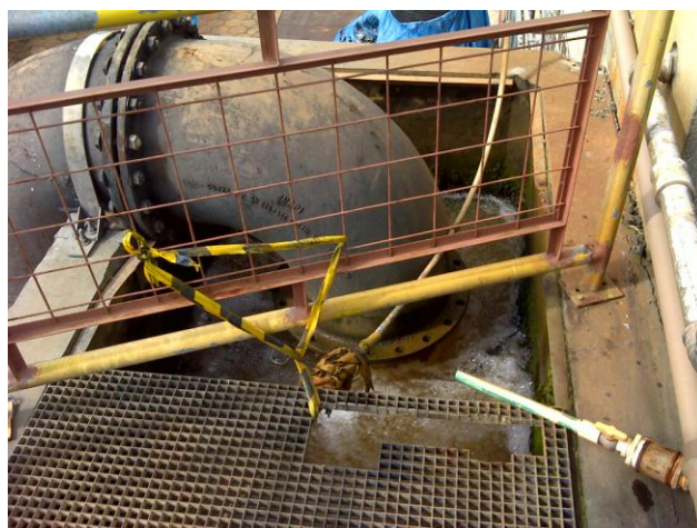
FOTO 4.12 ETA 2 – ENTRADA DE ÁGUA BRUTA
