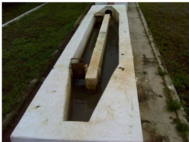
FOTO 4.85: CAIXA DE AREIA
