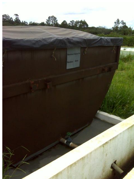
FOTO 4.96: ETE – RESERVATÓRIO DE ACÚMULO DE AREIA
