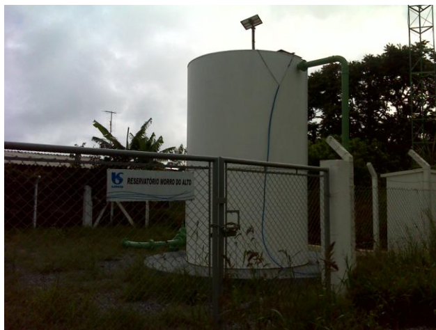
FOTO 4.42: RESERVATÓRIO – DISTRITO MORRO DO ALTO
