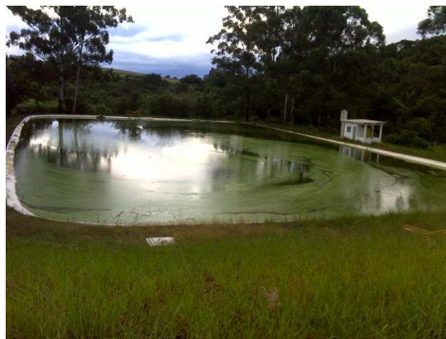
FOTO 4.103: ETE – LAGOA FACULTATIVA
