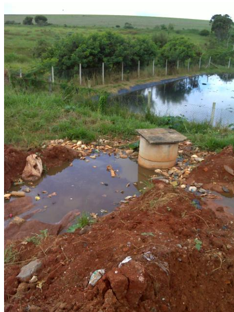
FOTO 4.107: ATERRO SANITÁRIO - CAPTAÇÃO E LAGOA DE CHORUME
