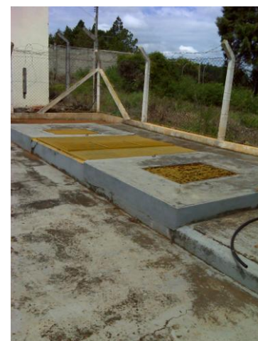
FOTO 4.56: SISTEMA SEDE - EEE BELA VISTA E BRÁS
