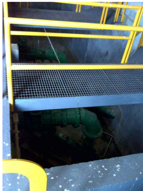
FOTO 4.19: EEAT – NOVA ITAPETININGA – CASA DE BOMBAS
