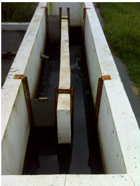
FOTO 4.95: ETE CAIXA DE AREIA
