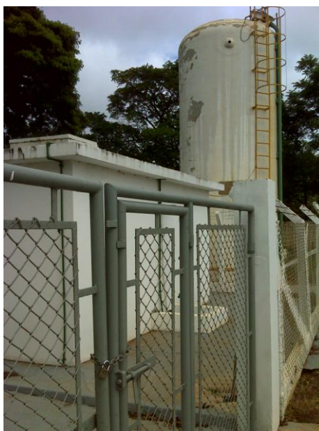
FOTO 4.38: RESERVATÓRIOS – DISTRITO TUPY
