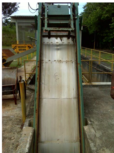
FOTO 4.66: SISTEMA SEDE - EEE FINAL – GRADEAMENTO MECÂNICO
