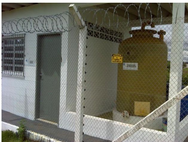
FOTO 4.99: ETE - RESERVATÓRIO DE SOLUÇÃO DE HIPOCLORITO
