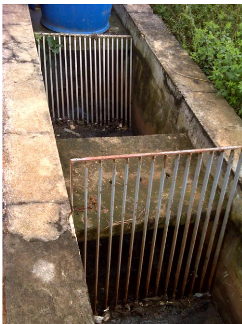
FOTO 4.88: SISTEMA DE GRADEAMENTO
