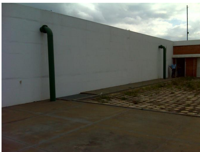
FOTO 4.27: RESERVATÓRIO – ETA – VILA NASTRI
