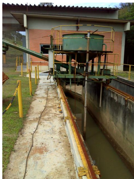
FOTO 4.68: SISTEMA SEDE - EEE FINAL DESARENADOR
