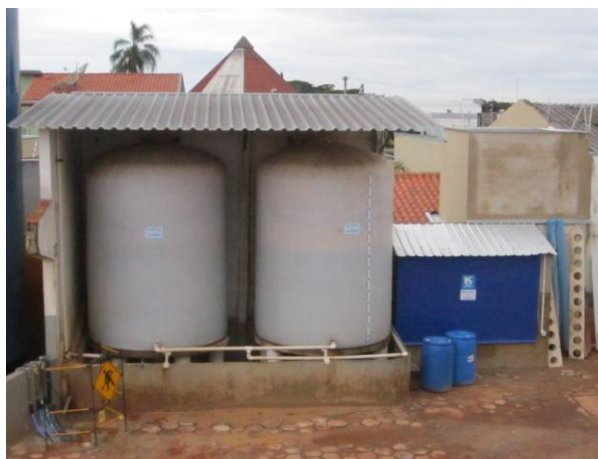
FOTO 4.33 – SISTEMA SEDE - TANQUES DE SULFATO DE ALUMÍNIO
