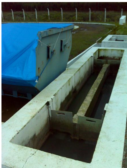
FOTO 4.80: CAIXA DE AREIA E RESERVATÓRIO DE ACÚMULO DE AREIA
