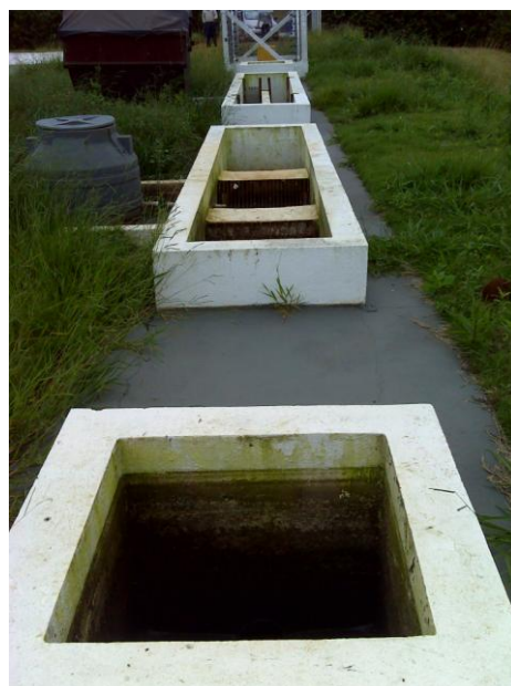
FOTO 4.94: ETE – GRADEAMENTO E RESERVATÓRIO DE RESÍDUO GRADEADO
