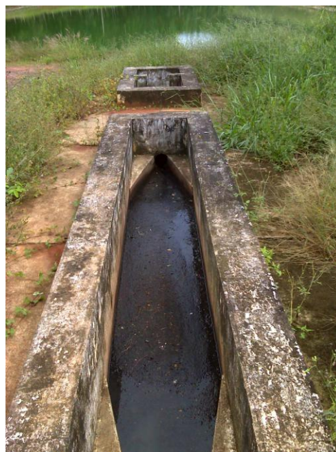
FOTO 4.89: CAIXA DE AREIA
