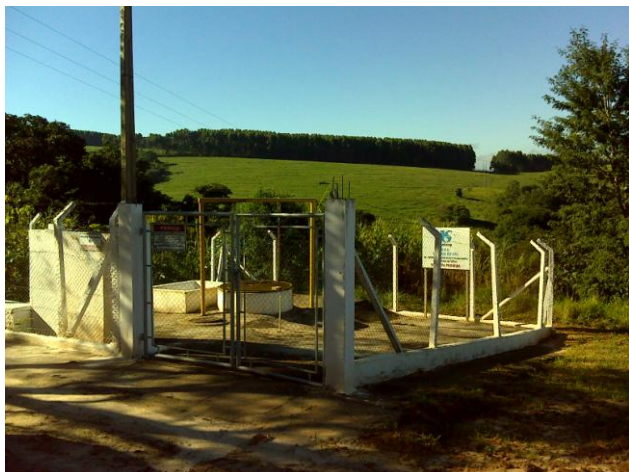
FOTO 4.53 – VISTA GERAL DA EEE 05 - MORADA DO SOL
