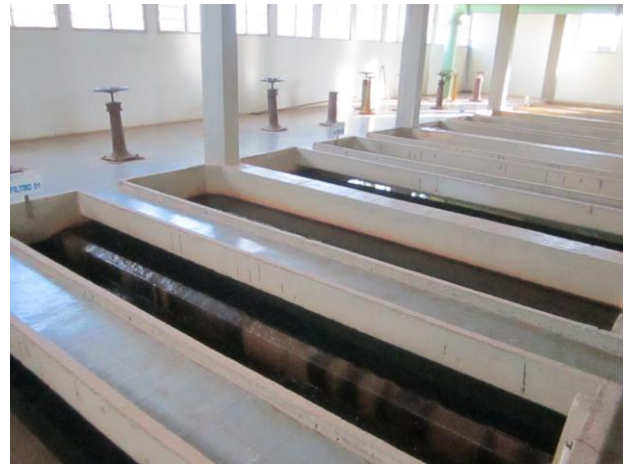
FOTO 4.4 – DETALHE DOS FILTROS DA ETA PILÃO D'ÁGUA
