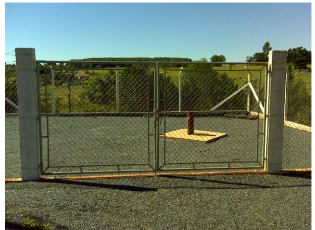
FOTO 4.40 – VISTA DO POÇO PROFUNDO PPS02 DE CERCADINHO - DESATIVADO
