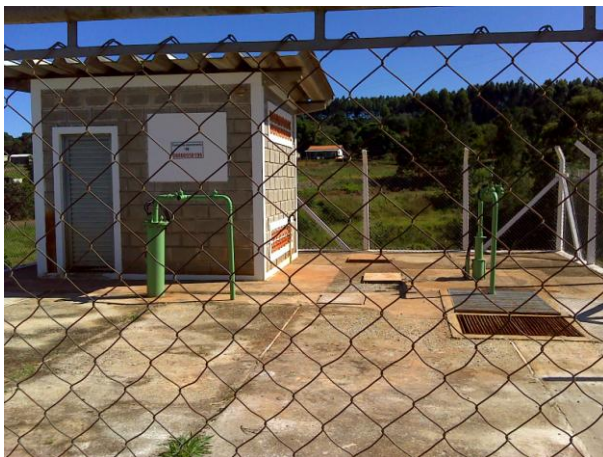
FOTO 4.39 – VISTA DO POÇO PROFUNDO PPS01 DE AMARELA VELHA
