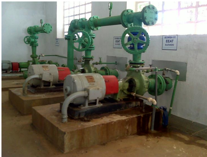
FOTO 4.11 – DETALHE DA EEAT ELEVADO
