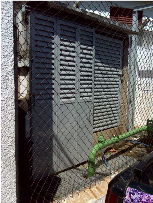
FOTO 4.19 – DETALHE DO BOOSTER DO JARDIM GRAJAÚ
