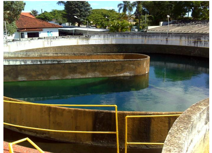
FOTO 4.6 – DETALHE DOS FILTROS DA ETA SEDE
