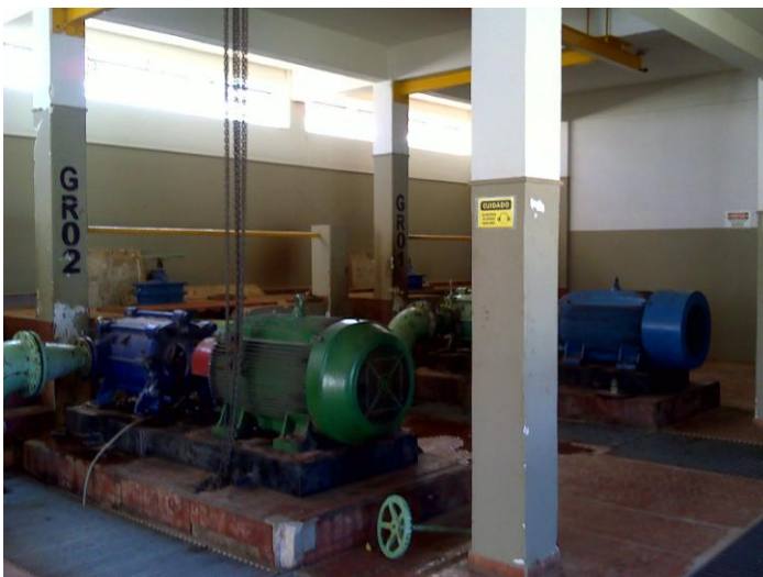
FOTO 4.9 – DETALHE DA EEAT CENTRAL
