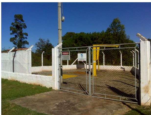
FOTO 4.55 – VISTA GERAL DA EEE 07 – CURTUME
