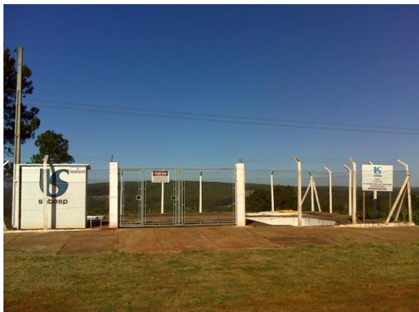
FOTO 4.56 – VISTA GERAL DA EEE 08 – KANTIAN
