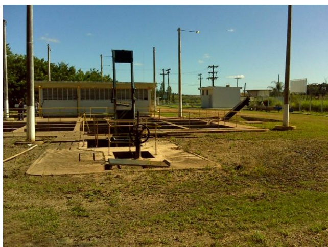
FOTO 4.57 – VISTA GERAL DA EEE 09 – FINAL
