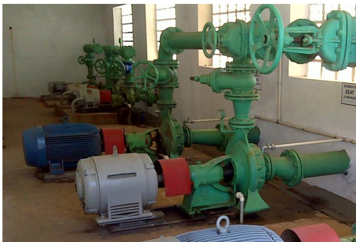
FOTO 4.12 – DETALHE DA EEAT JARDIM MARINGÁ
