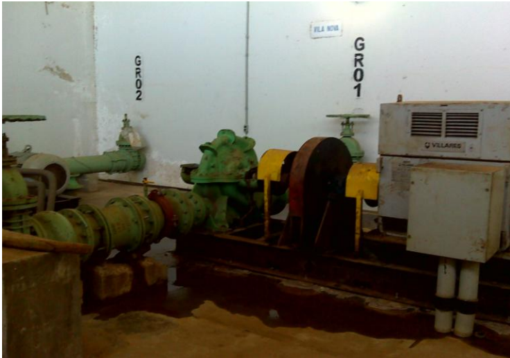
FOTO 4.7 – DETALHE DA EEAT VILA NOVA
