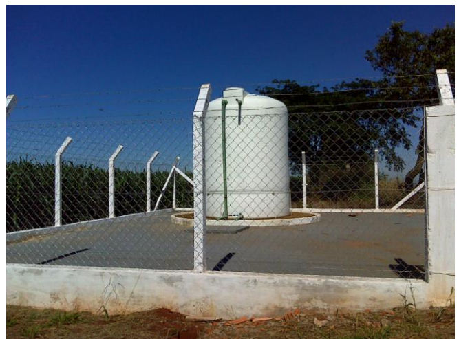
FOTO 4.42 - VISTA DO RESERVATÓRIO DE CERCADINHO
