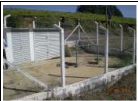
Foto nº 41 – Poço tubular profundo – PT-01 – Ponte Nova
