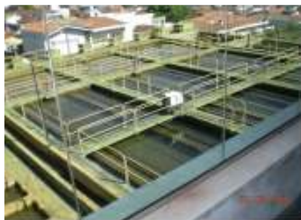
Foto nº 9 – ETA – visão geral dos decantadores
