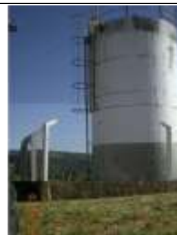
Foto nº 42 – Reservatórios de distribuição – R1 – Ponte Nova
