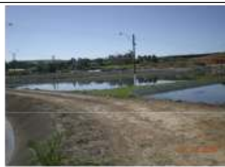
Foto nº 60 – ETE – Lagoas de decantação
