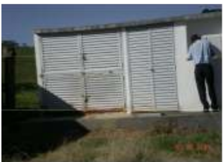
Foto nº 37 – Cabines para quadro de comando e dosagem de produtos químicos
