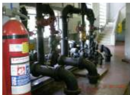
Foto nº 17 – EEAT-01 Santa Bárbara (frente) e EEAT-02 Vila Ilze (fundo)
