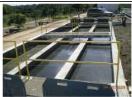
Foto nº 57 – ETE – Tratamento preliminar
