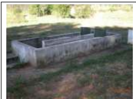
Foto nº 71 – ETE – Tratamento preliminar
