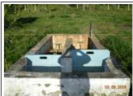
Foto nº 65 – ETE – Tratamento preliminar – caixa de areia
