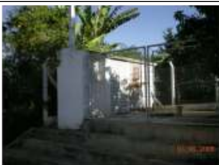
Foto nº 36 – Poço tubular profundo – PT-03 - Terrazan
