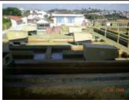
Foto nº 8 – ETA – floculadores mecanizados
