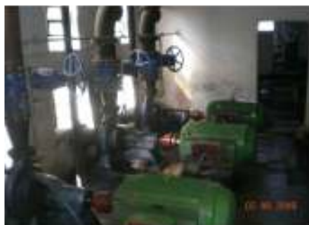
Foto nº 5 – Elevatória de água bruta – conjuntos elevatórios
