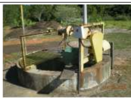
Foto nº 56 – ETE-10 - ETE – elevatória geral do sistema
