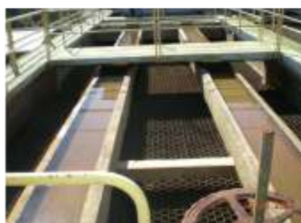
Foto nº 10 – ETA – decantador paralizado para manutenção do filtro 1
