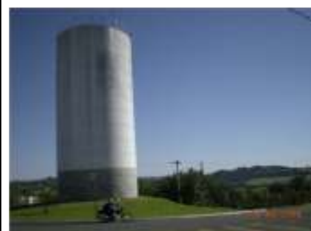
Foto nº 28 – Reservatório R7 – Braz Cavenaghi
