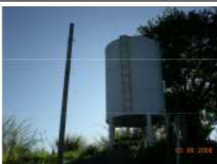
Foto nº 40 – Reservatórios de distribuição – R3 – Terrazan
