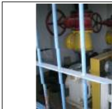
Foto nº 64 – ETE – elevatória geral – conjuntos elevatórios
