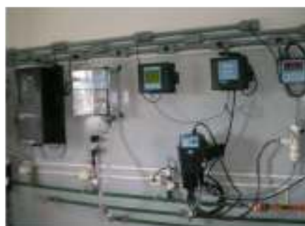
Foto nº 14 – ETA – automação de dosagens e análises
