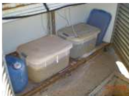
Foto nº 38 – Tanques de dosagem de hipoclorito de sódio a ácido fluossilícico
