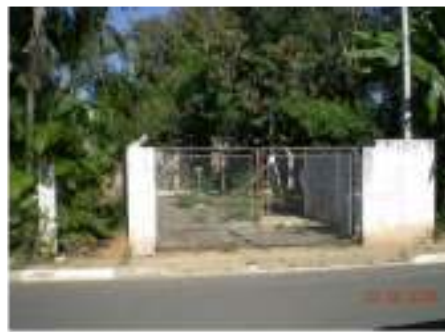
Foto nº 34 – Poço tubular profundo – PT-02 – Ataliba Nogueira
