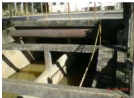
Foto nº 3 – Captação Ribeirão da Penha – canais de água bruta
