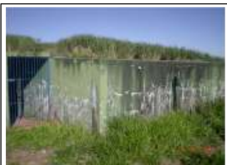
Foto nº 45 – Reservatórios de distribuição – R1 – Eleutério
