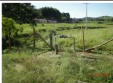
Foto nº 35 – Poço tubular profundo – PT-03 – Ataliba Nogueira
