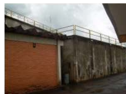
Foto nº 23 – Reservatório R2 - ETA
