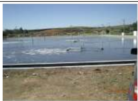
Foto nº 59 – ETE – Lagoas aeradas
