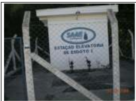
Foto nº 69 – Elevatória de esgoto EEE-01
